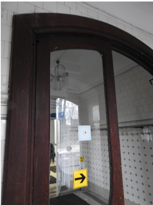
24. «Главное здание», входящее в состав объекта культурного наследия федерального значения «Институт ортопедический», Александровский парк, д. 5 литера А. Вход со стороны Троицкой площади. Тамбур. Фрагмент. Фото 11.03.2021 г.
