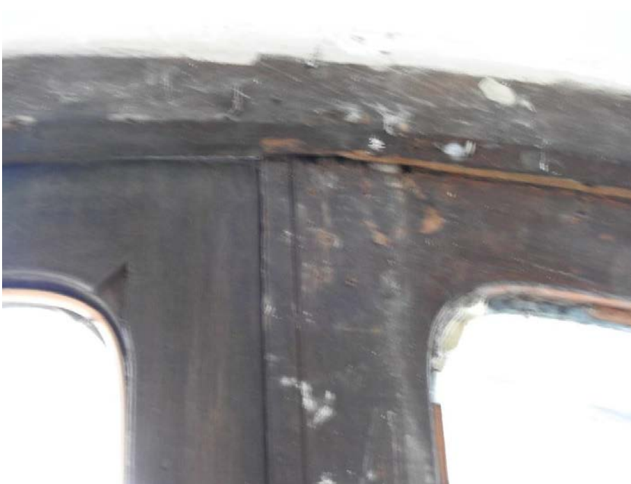
16. «Главное здание», входящее в состав объекта культурного наследия федерального значения «Институт ортопедический», Александровский парк, д. 5 литера А. Вход со стороны Троицкой площади. Тамбур. Фрагмент. Фото 11.03.2021 г.
