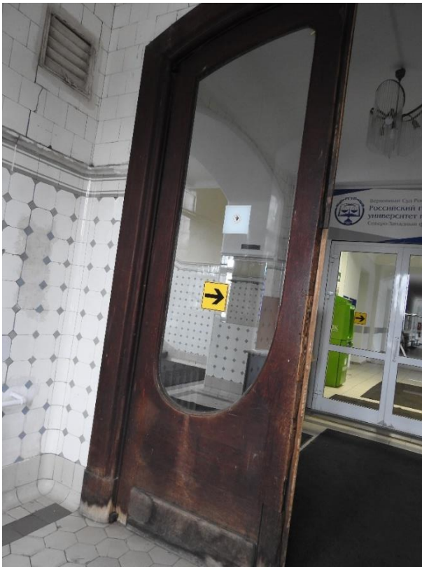
23. «Главное здание», входящее в состав объекта культурного наследия федерального значения «Институт ортопедический», Александровский парк, д. 5 литера А. Вход со стороны Троицкой площади. Тамбур. Фрагмент. Фото 11.03.2021 г.
