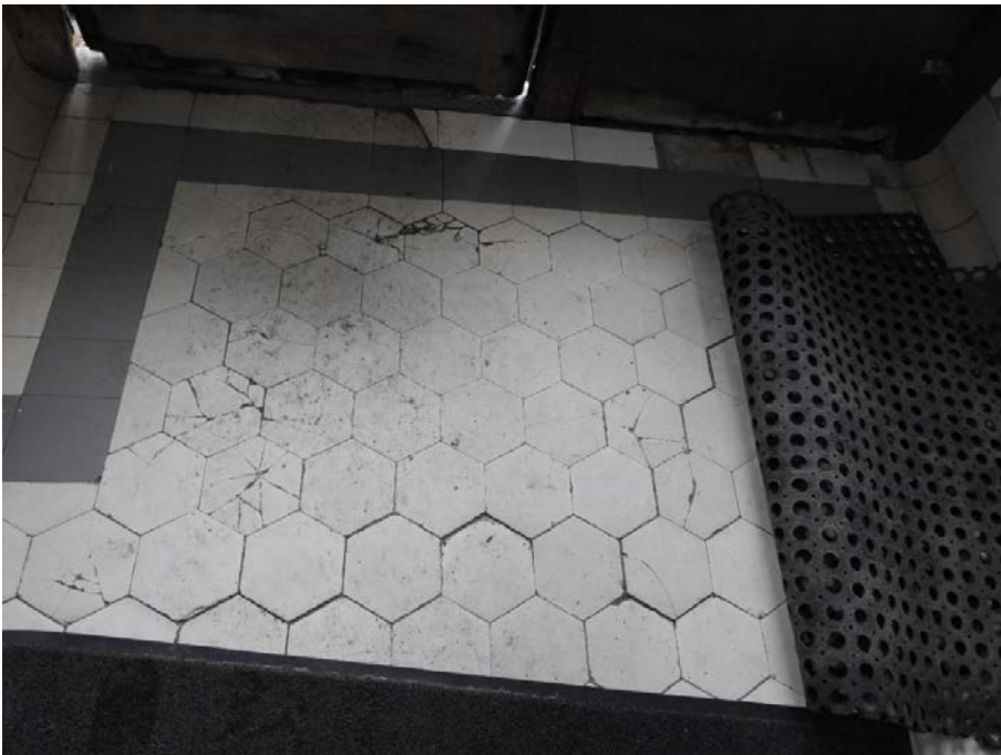
18. «Главное здание», входящее в состав объекта культурного наследия федерального значения «Институт ортопедический», Александровский парк, д. 5 литера А. Вход со стороны Троицкой площади. Тамбур. Фрагмент. Фото 11.03.2021 г.
