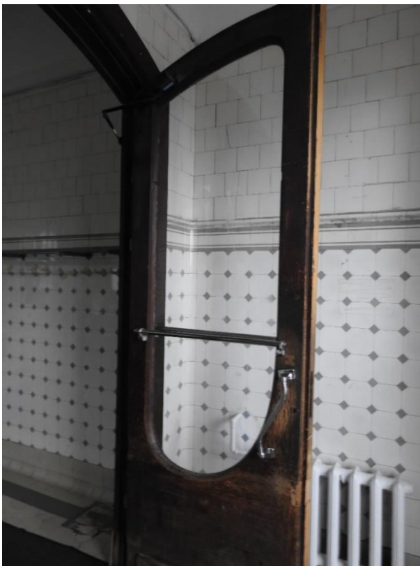
26. «Главное здание», входящее в состав объекта культурного наследия федерального значения «Институт ортопедический», Александровский парк, д. 5 литера А. Вход со стороны Троицкой площади. Тамбур. Фрагмент. Фото 11.03.2021 г.
