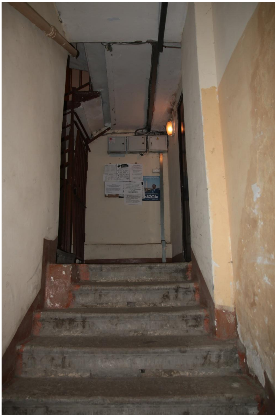
71. Интерьер первого этажа дворовой парадной в проездной арке. Лестница прохода на второй этаж
