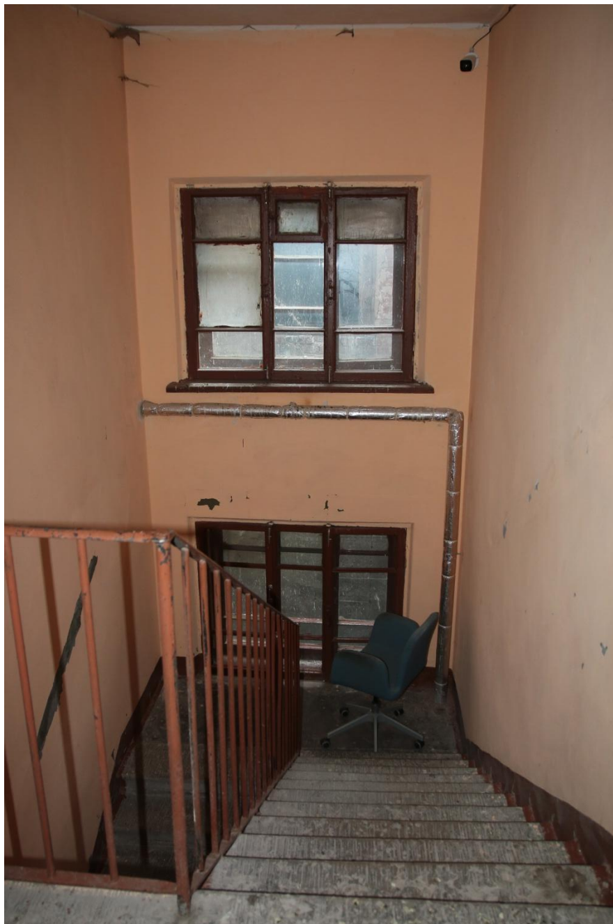
79. Интерьер дворовой парадной в проездной арке. Оформление оконного проема лестничной площадки мансардного этажа
