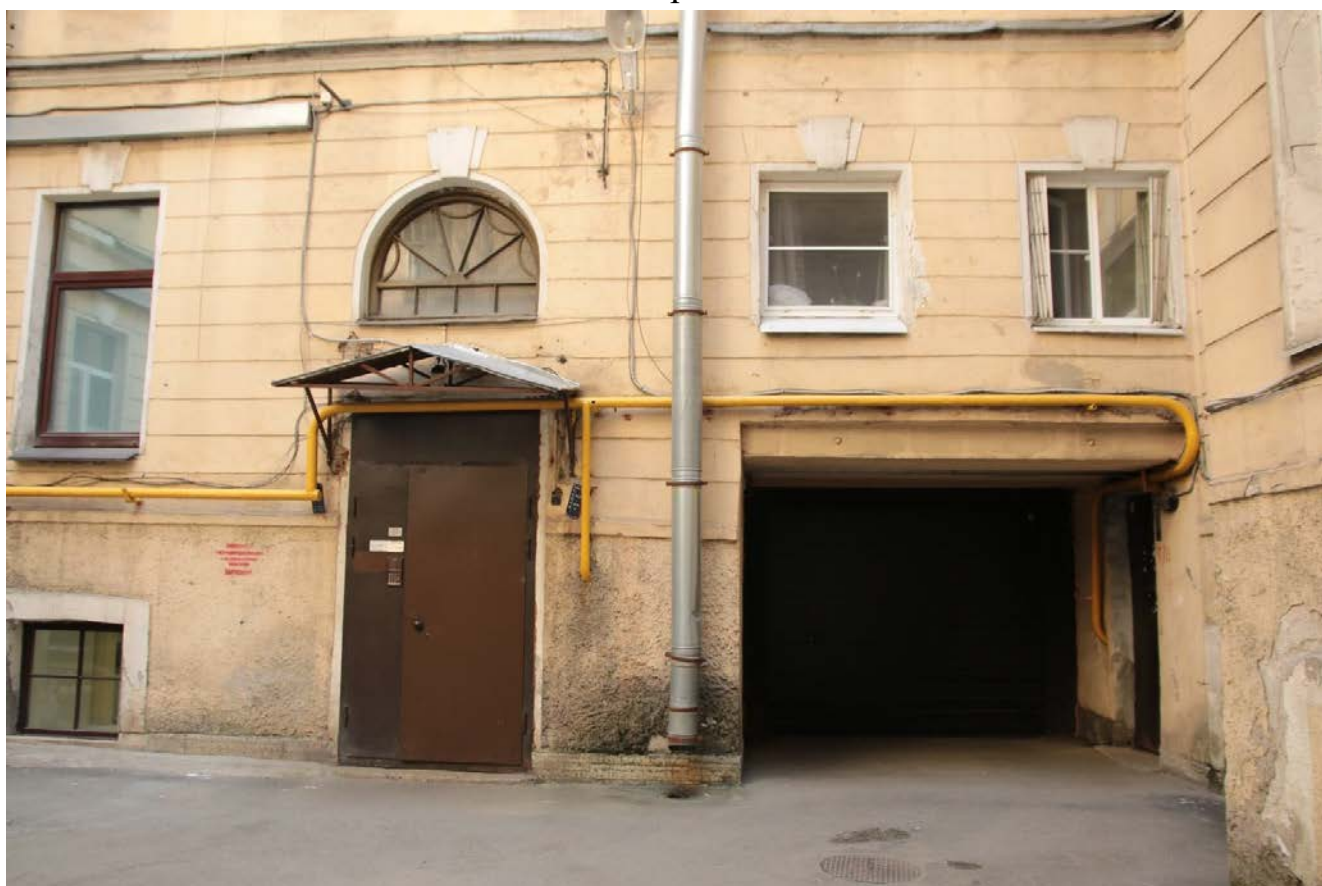
36. Фрагмент дворового фасада. Дверь входа в дворовую парадную с навесным металлическим козырьком. Оформление оконных проемов над проездной аркой. Вид с запада
