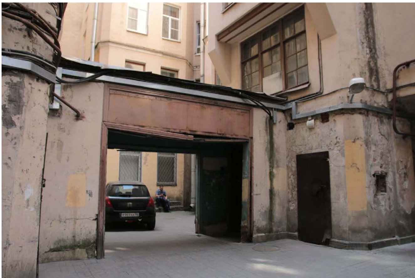
7. Фрагмент фасада внутреннего двора здания. Арка, соединяющая литеру А и литеру Б, с дверью входа в парадную литеры Б. Вид с востока
