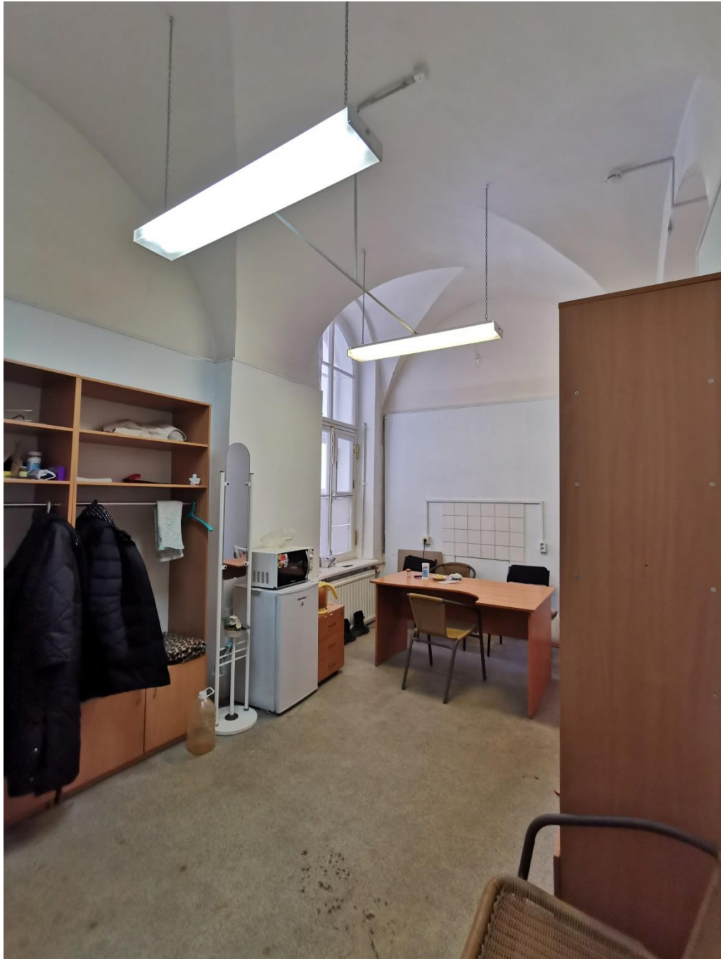
Фото 32. Объект культурного наследия федерального значения «Гостиный двор Новобиржевой», помещения входной группы. Помещение 6. Вид на оконный проём. 20 января 2023г
