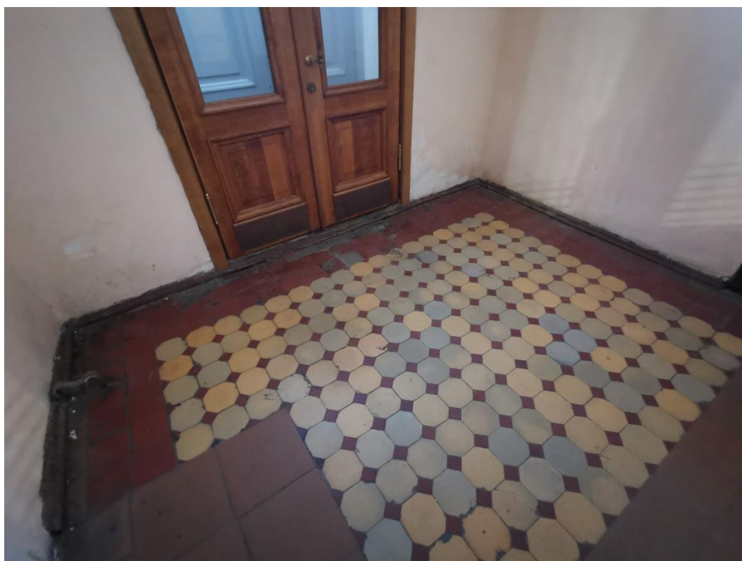
Фото 50. Объект культурного наследия федерального значения «Гостиный двор Новобиржевой», помещения входной группы. Помещение 1. Тамбур. Покрытие пола – метлахская плитка и керамогранит. 20 января 2023г
