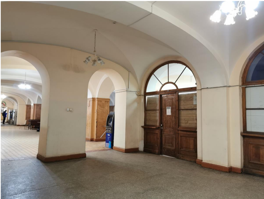
Фото 13. Объект культурного наследия федерального значения «Гостиный двор Новобиржевой», помещения входной группы. Помещение 2а. Вестибюль. Пилон. Арочные проёмы. 20 января 2023г
