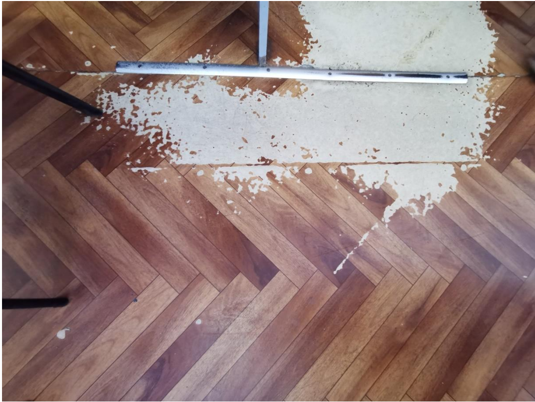
Фото 45. Объект культурного наследия федерального значения «Гостиный двор Новобиржевой», помещения входной группы. Помещение 8. Гардероб. Покрытие пола – линолеум. 20 января 2023г
