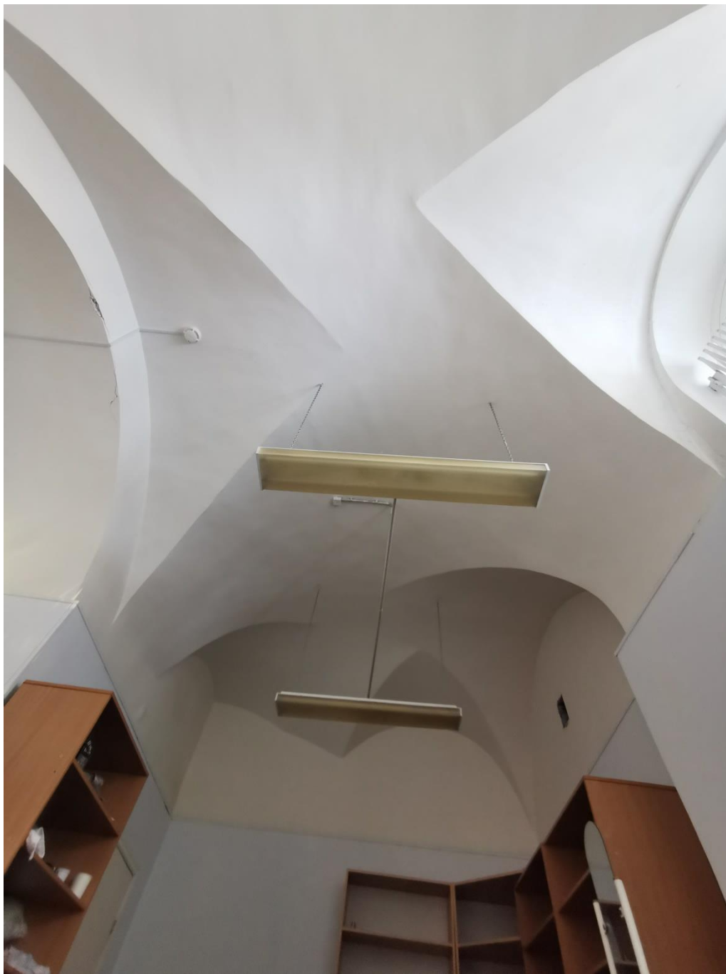
Фото 33. Объект культурного наследия федерального значения «Гостиный двор Новобиржевой», помещения входной группы. Помещение 6. Свод с распалубками. 20 января 2023г
