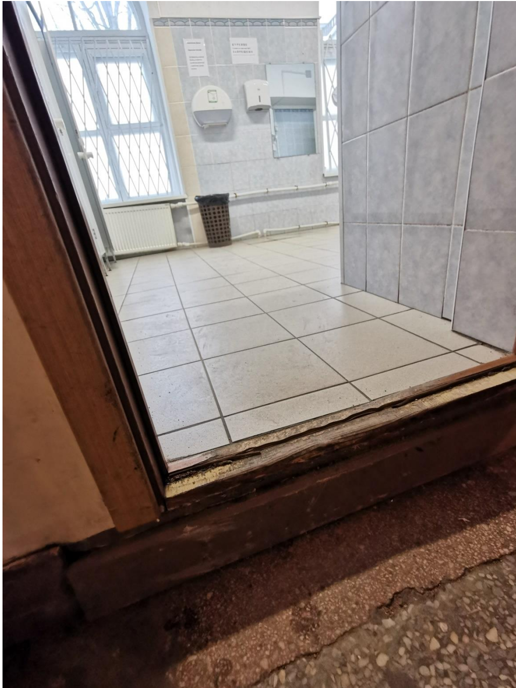
Фото 63. Объект культурного наследия федерального значения «Гостиный двор Новобиржевой», помещения входной группы. Помещение 10. Сан. узел. Перепад высот пола. 20 января 2023г
