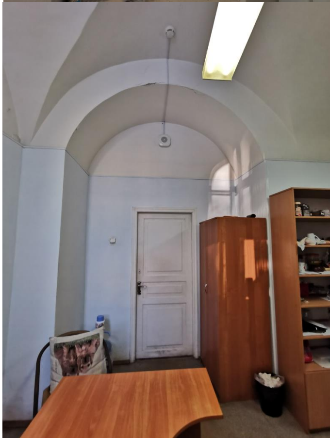
Фото 35. Объект культурного наследия федерального значения «Гостиный двор Новобиржевой», помещения входной группы. Помещение 6. Дверное заполнение. . 20 января 2023г
