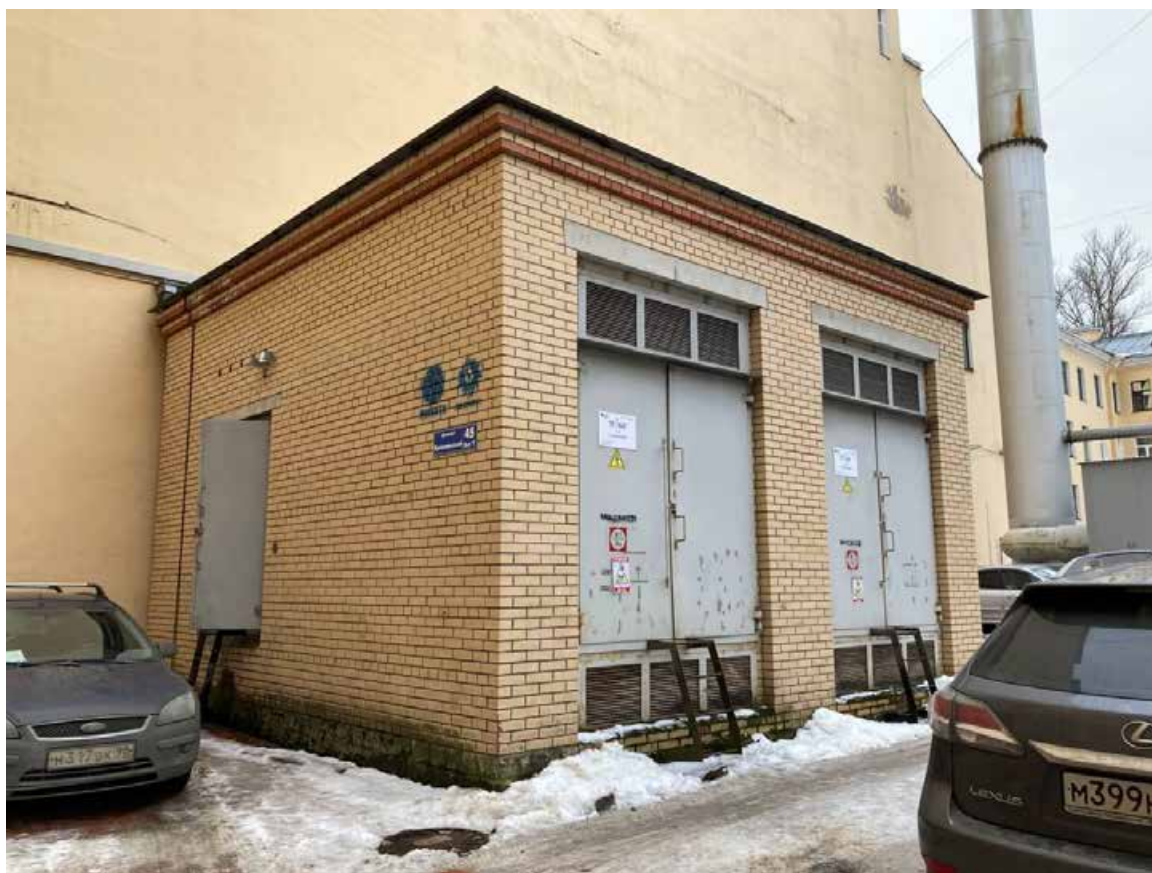
Фото 53. Фрагмент дворового фасада выявленного объекта культурного наследия «Жилой дом специалистов «Иностраннный ударник», трансформаторная подстанция 45Т
