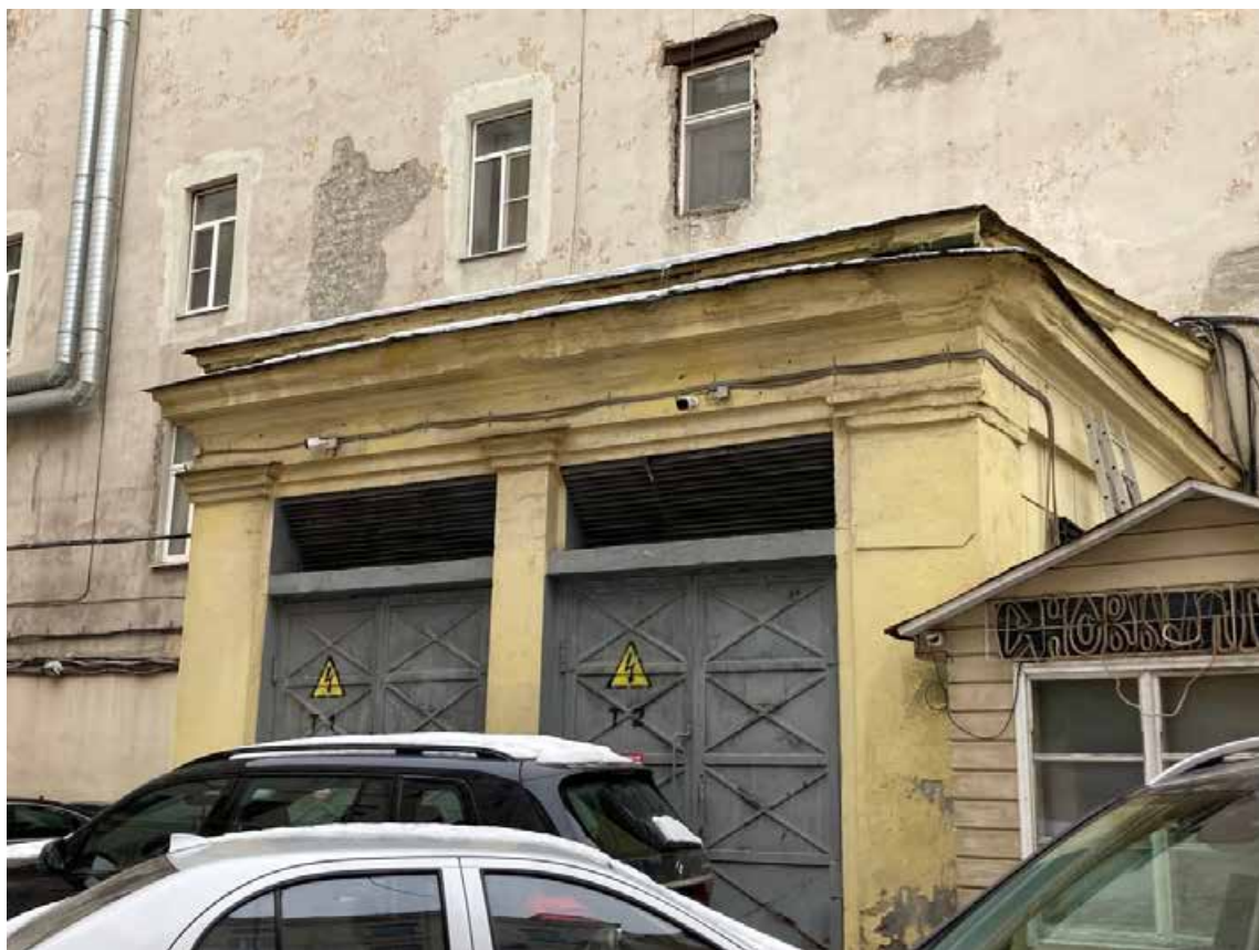
Фото 58. Фрагмент дворового фасада объекта культурного наследия регионального значения «Дом жилой», трансформаторная подстанция 2АБ
