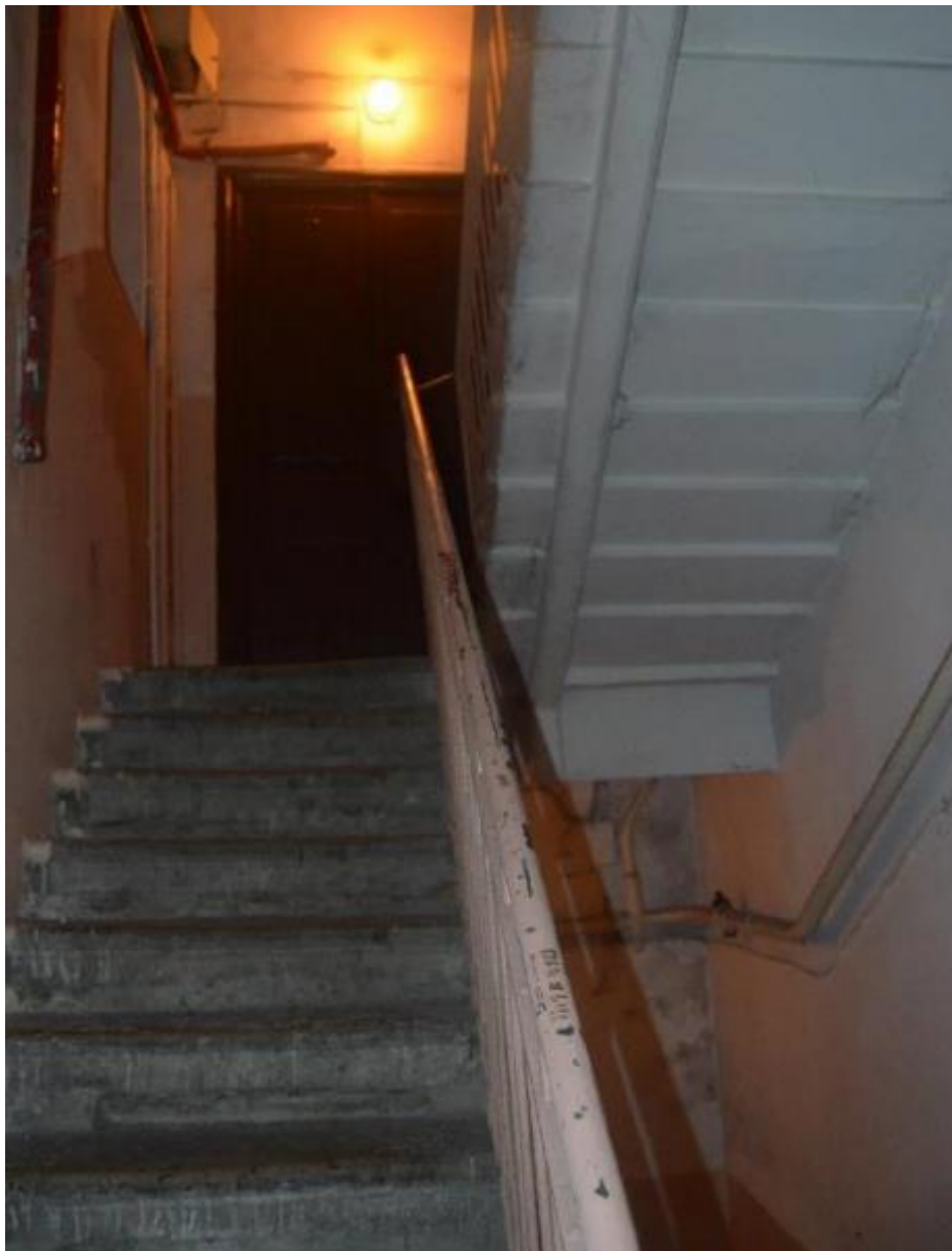
85. Выявленный объект культурного наследия «Дом П. Ф. Дыренкова». Черная лестница по южному дворовому фасаду (Л 5). Марши в уровне 1-го этажа. Вид северо-запада. Съемка 26.04.2021.
