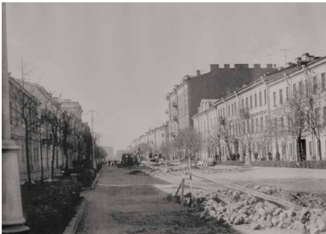
53. Реконструкция пр. Ленина в Кронштадте. Замена булыжной мостовой асфальтом. 1960-е гг. URL: https://vk.com/ .
