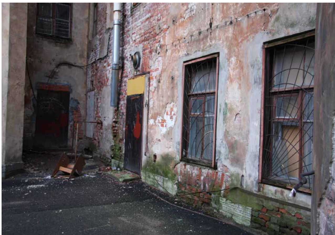
1.14. Вид на восточный дворовой фасад. Объект культурного наследия регионального значения «Дом Никитина», расположенный по адресу: Санкт-Петербург, г. Кронштадт, пр. Ленина, дом 39а, литера А (г. Кронштадт, Ленина пр., 39). Дата съемки: 15.04.2022г.
