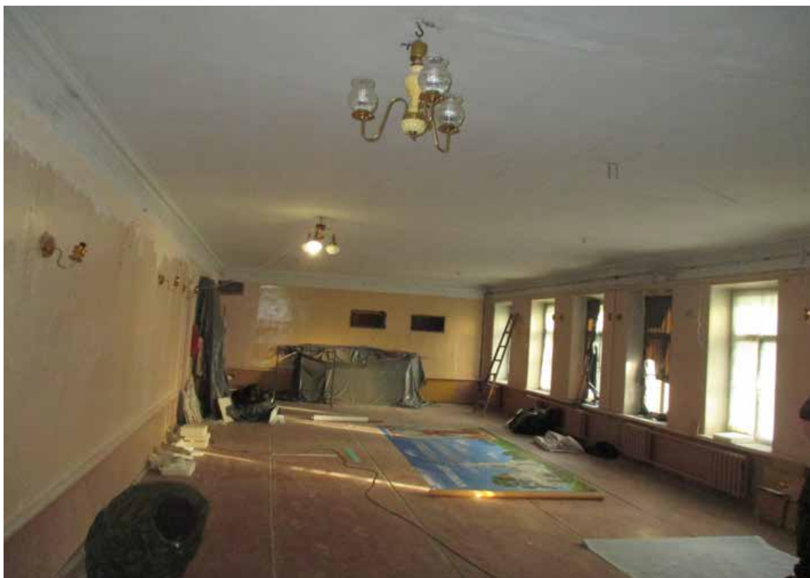
4.3. Зал второго этажа. Вид на пр. Ленина. Объект культурного наследия регионального значения «Дом Никитина», расположенный по адресу: Санкт-Петербург, г. Кронштадт, пр. Ленина, дом 39а, литера А (г. Кронштадт, Ленина пр., 39). Дата съемки: 15.04.2022г.
