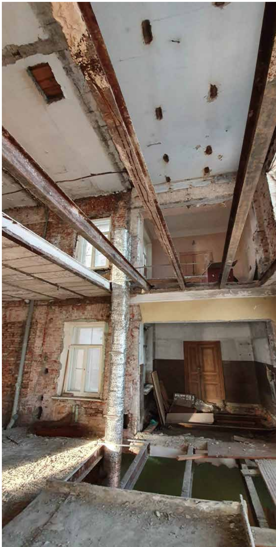
4.5. Четвёртый этаж. Северо-восточная часть. Вид на дворовую стену. Объект культурного наследия регионального значения «Дом Никитина», расположенный по адресу: Санкт-Петербург, г. Кронштадт, пр. Ленина, дом 39а, литера А (г. Кронштадт, Ленина пр., 39). Дата съёмки: 15.04.2022г.
