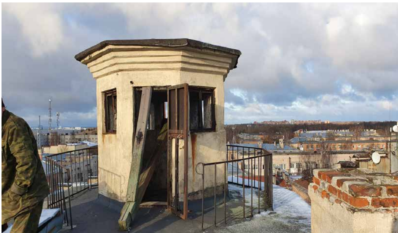
1.16. Вид на смотровую башню. Объект культурного наследия регионального значения «Дом Никитина», расположенный по адресу: Санкт-Петербург, г. Кронштадт, пр. Ленина, дом 39а, литера А (г. Кронштадт, Ленина пр., 39). Дата съемки: 15.04.2022г.
