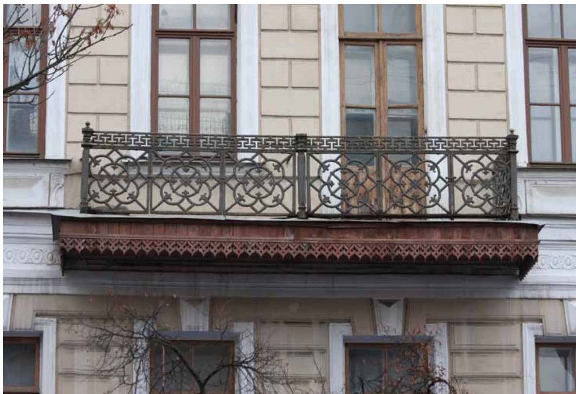
1.11. Вид на балкон по пр. Ленина. Объект культурного наследия регионального значения «Дом Никитина», расположенный по адресу: Санкт-Петербург, г. Кронштадт, пр. Ленина, дом 39а, литера А (г. Кронштадт, Ленина пр., 39). Дата съемки: 15.04.2022г.
