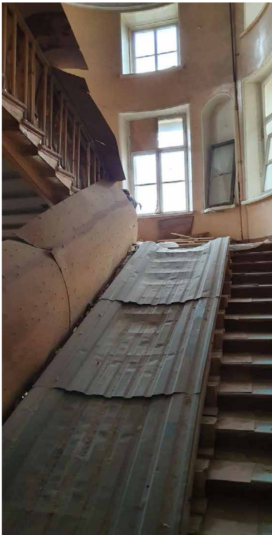
3.9. Вид на промежуточную площадку четвёртого и пятого этажей. Объект культурного наследия регионального значения «Дом Никитина», расположенный по адресу: Санкт-Петербург, г. Кронштадт, пр. Ленина, дом 39а, литера А (г. Кронштадт, Ленина пр., 39). Дата съёмки: 15.04.2022г.
