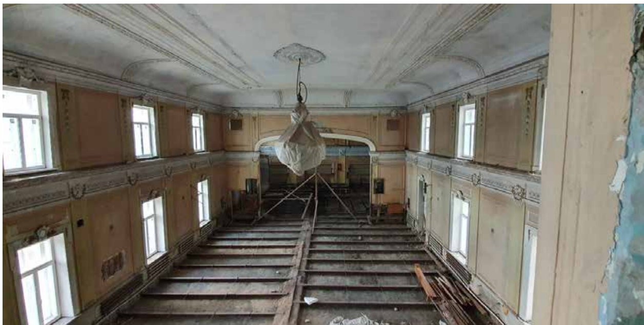
2.1. Общий вид на двухсветный зал со второго яруса. Объект культурного наследия регионального значения «Дом Никитина», расположенный по адресу: Санкт-Петербург, г. Кронштадт, пр. Ленина, дом 39а, литера А (г. Кронштадт, Ленина пр., 39). Дата съемки: 15.04.2022г.
