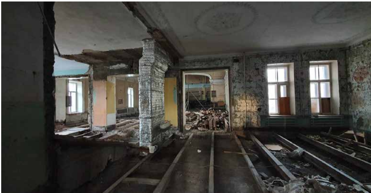
4.9. Вид на двухсветный из соседнего помещения. Объект культурного наследия регионального значения «Дом Никитина», расположенный по адресу: Санкт-Петербург, г. Кронштадт, пр. Ленина, дом 39а, литера А (г. Кронштадт, Ленина пр., 39). Дата съемки: 15.04.2022г.
