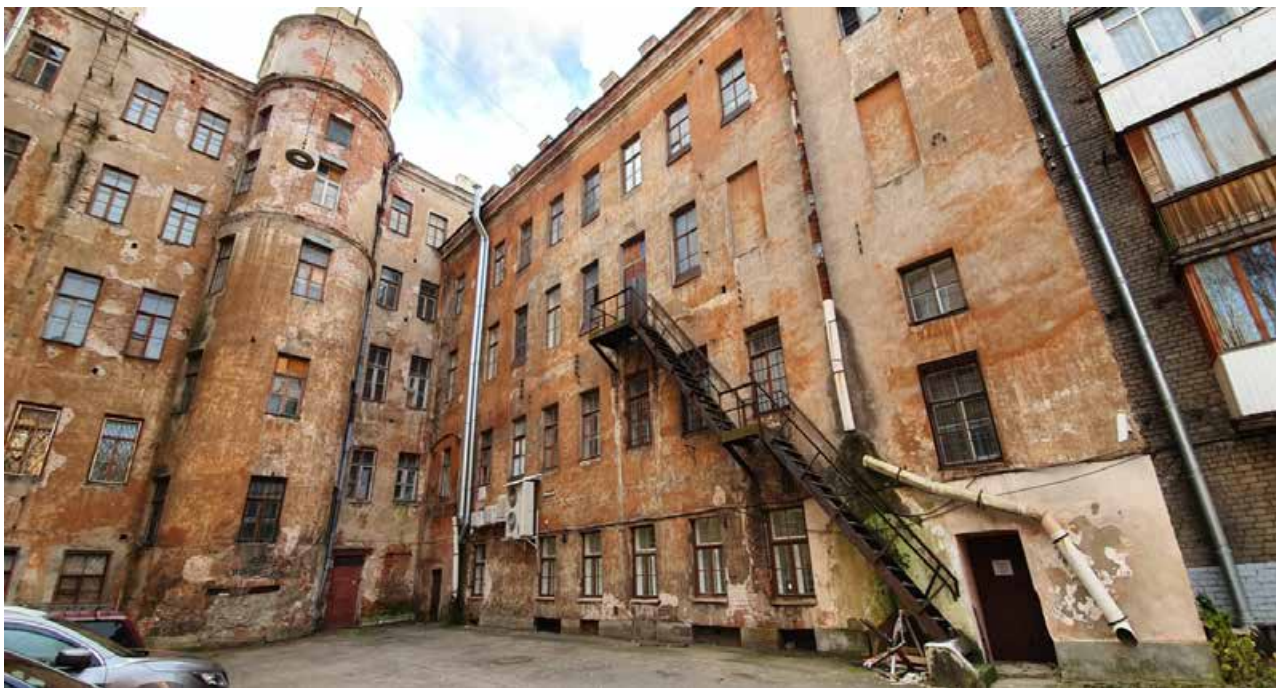
1.13. Общий вид на дворовые фасады. Объект культурного наследия регионального значения «Дом Никитина», расположенный по адресу: Санкт-Петербург, г. Кронштадт, пр. Ленина, дом 39а, литера А (г. Кронштадт, Ленина пр., 39). Дата съемки: 15.04.2022г.
