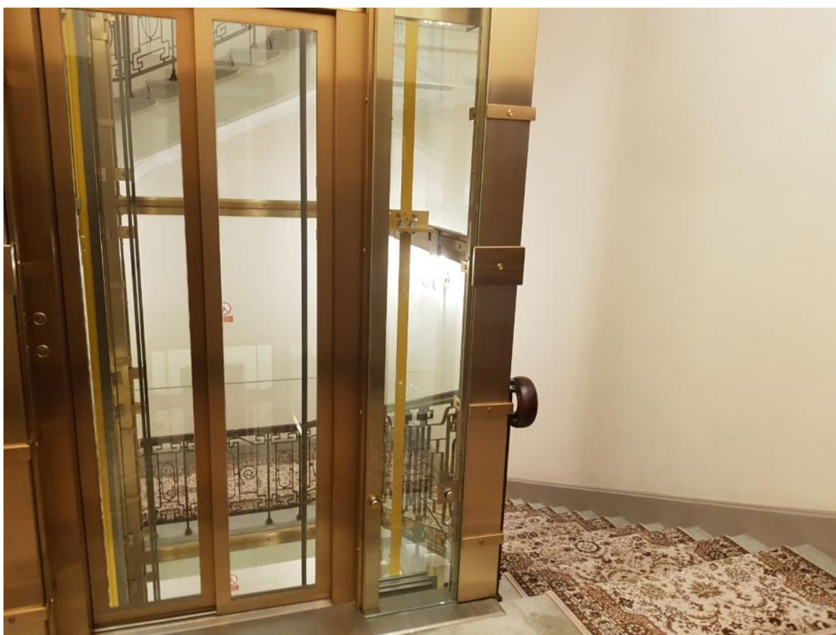
52. ОКН регионального значения «Международный коммерческий банк» по адресу г. Санкт-Петербург, Невский проспект, д.58, литера А. Помещение 3 этажа.
