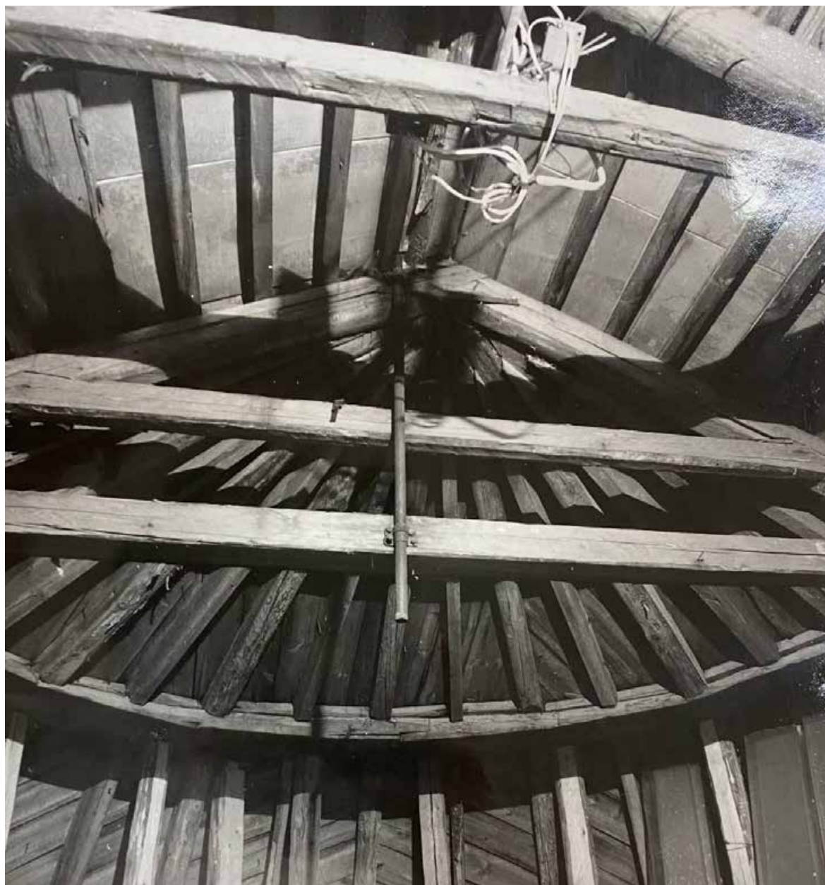
98. Ансамбль усадьбы Шуваловых. Малый дворец («Белый дом»). Полуротонда. Конструкция крыши. Дата: 1985 г. Автор: В.И. Шлакан // Архив КГИОП, № 55325/1-Н.
