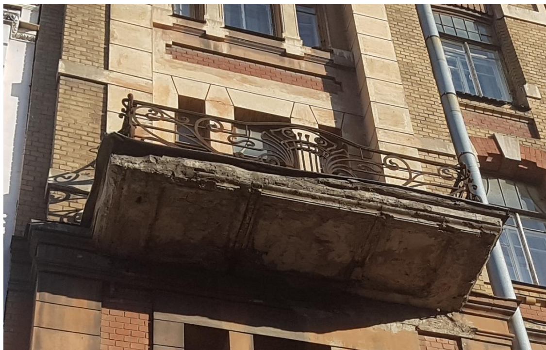
Фото 4. Балкон в уровне 4-го этажа на ризалите по левой оси лицевого фасада.
