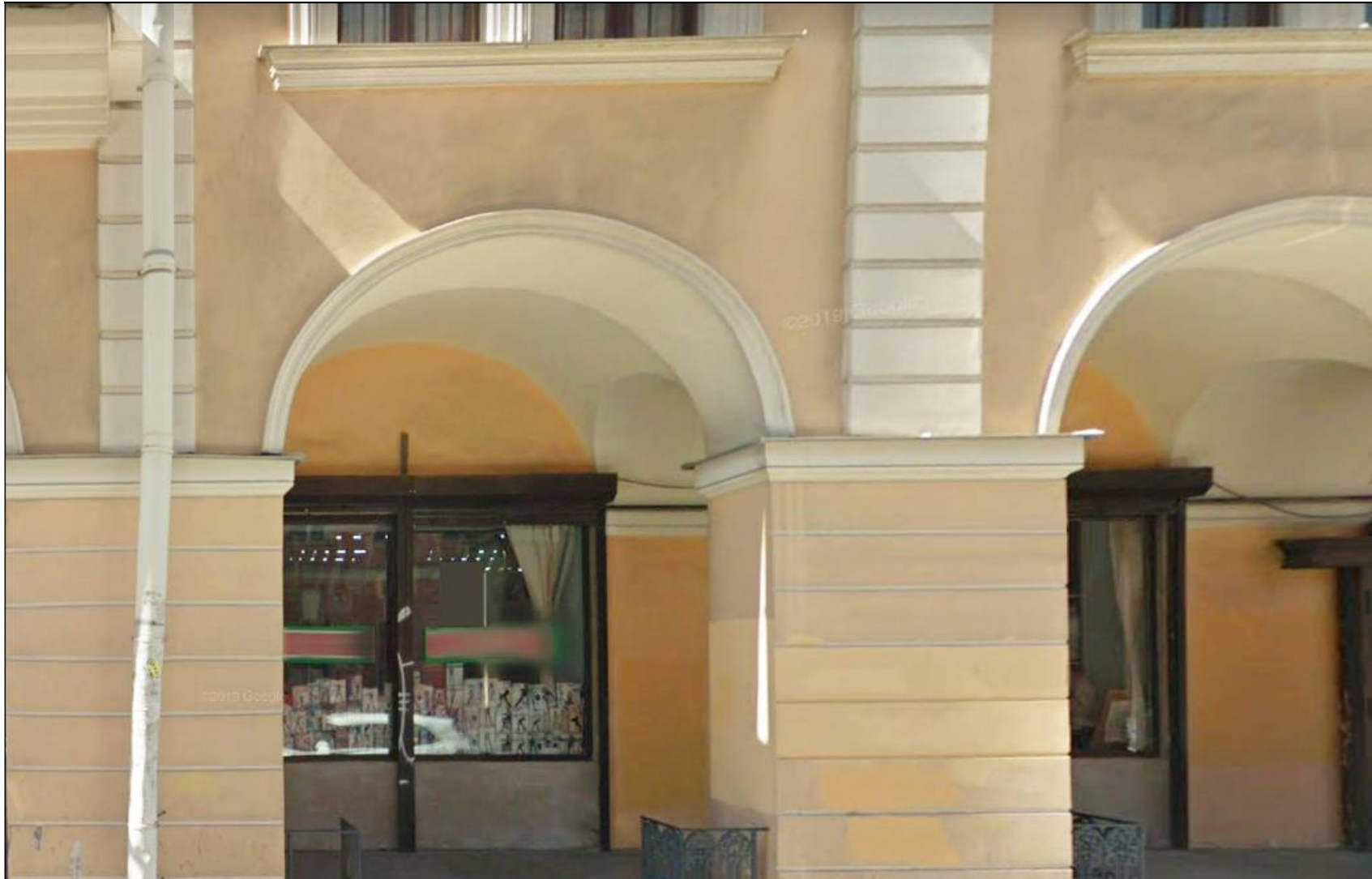
21. Натурная съёмка. Объект культурного наследия регионального значения «Апраксин двор с Мариинским рынком (б. Щукиным двором) — комплекс». Фрагмент лицевого фасада по улице Ломоносова. Неисторические витринные оконные заполнения в/о «Т-С» и «С-Р» помещения 143-Н, не соответствующие Предмету охраны. Фотосъёмка выполнена государственным аттестованным экспертом РФ Н.Б.Глинской в апреле 2022 г.
