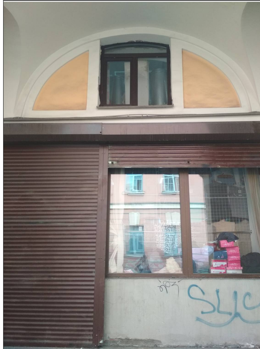
22. Натурная съёмка. Объект культурного наследия регионального значения «Апраксин двор с Мариинским рынком (б. Щукиным двором) — комплекс». Фрагмент лицевого фасада по улице Ломоносова. Неисторическое витринное окно со входом в/о «У-Т» помещения 143-Н, не соответствующие Предмету охраны. Фотосъёмка выполнена государственным аттестованным экспертом РФ Н.Б.Глинской в апреле 2022 г.
