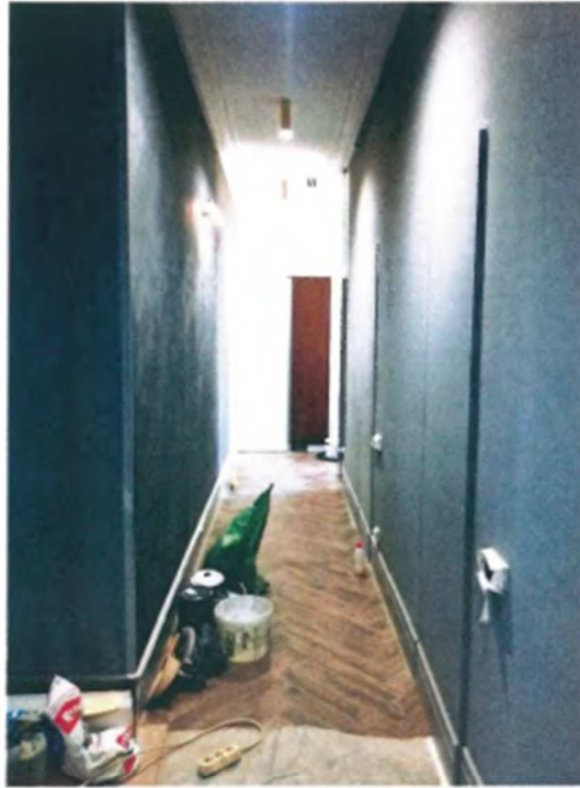
8. Басков пер., д. 13-15, лит. А, квартира № 3. Демонтирована перегородка между коридором (помещение 1 (15,8 м 2 ) и коридором (помещение 5 (10 м 2 ))
