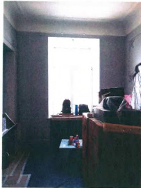
12. Басков пер., д. 13-15, лит. А, квартира № 3. Комната (помещение 2 (16,9 м 2 )). Наружная стена
