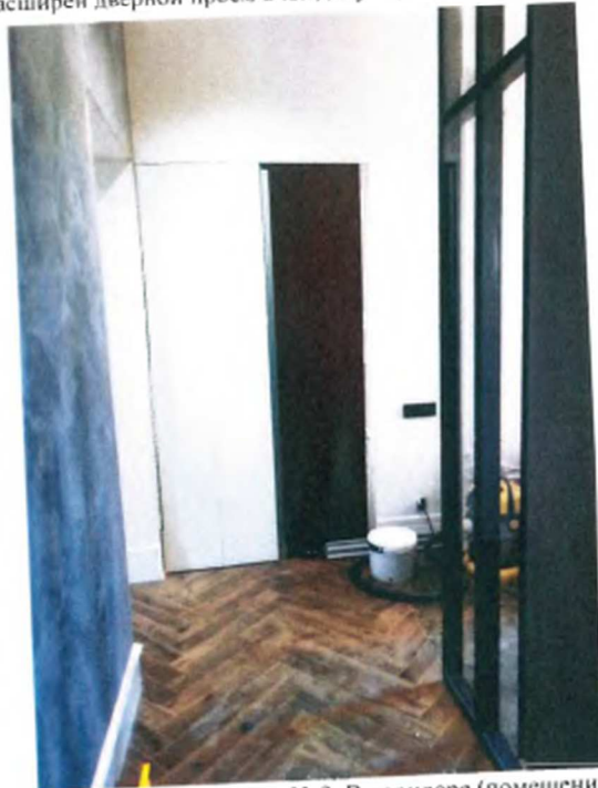
19. Басков пер., д. 13-15, лит. А, квартира № 3. Комната (помещение 3 (43,1 м 2 )). Расширен дверной проем в кладовую (помещение 4 (0,9 м 2 ))
