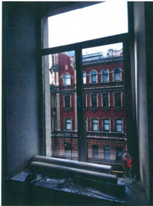
16. Басков пер., д. 13-15, лит. А, квартира № 3. Металлопластиковое оконное заполнение в комнате (помещении 3 (43,1 м 2 )).
