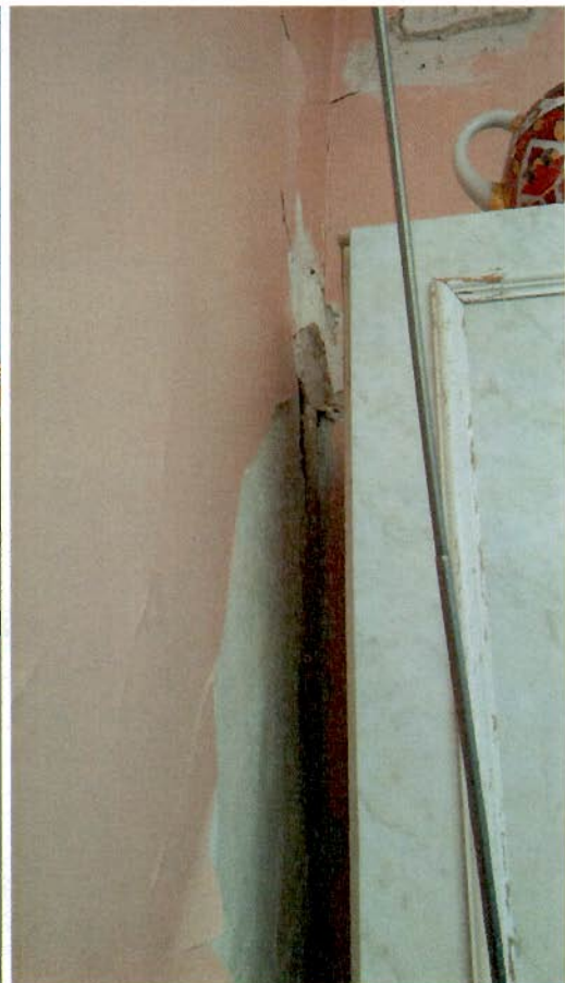
11. Трещины с маяками в квартирах последнего этажа
