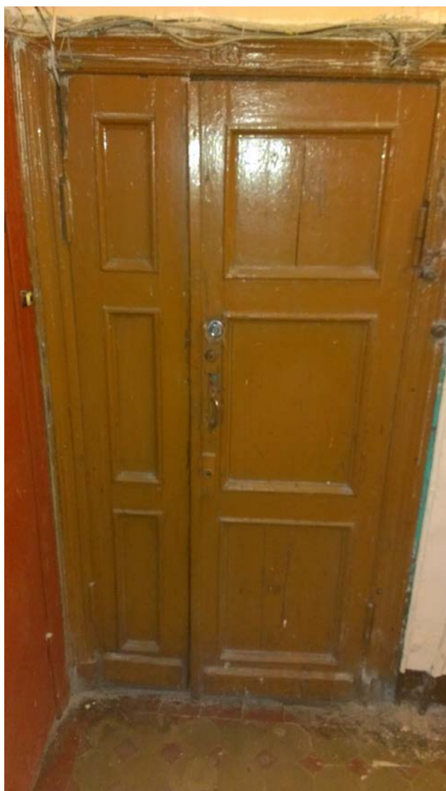
Фото 5. Дверной проем квартиры № 34.
