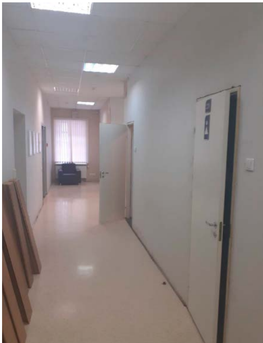
44. Помещение №1 объекта культурного наследия регионального значения «Комплекс казарм Семеновского и Егерского полков. Солдатская казарма». 23.11.2020.
