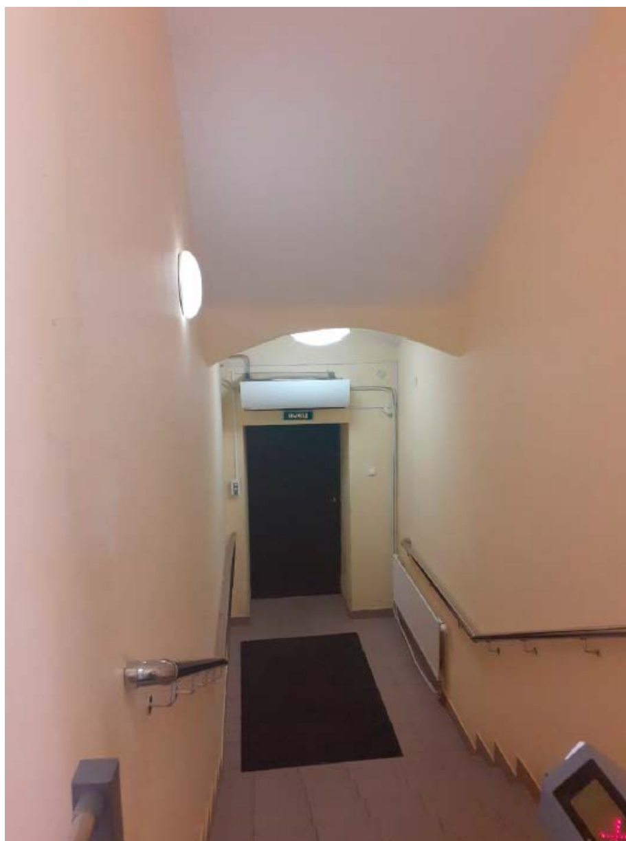
1. Лестничная клетка Л2 объекта культурного наследия регионального значения «Комплекс казарм Семеновского и Егерского полков. Солдатская казарма» расположенного по адресу: г. Санкт-Петербург, Звенигородская ул., д. 3, литера А. 23.11.2020.
