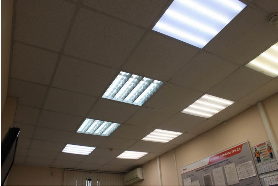
Фото 7. Объект культурного наследия регионального значения «Железнодорожная станция Левашово: вокзал» по адресу: г. Санкт-Петербург, п. Левашово, Железнодорожная ул., д. 7, лит. А (Левашово, железнодорожная станция. Вокзальное шоссе, 43). Вид на зашитый потолок в помещении №15. Дата: 28.11.2022 г.
