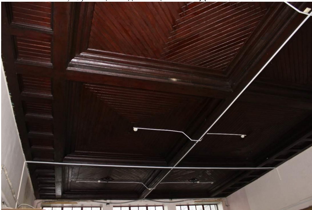
Фото 22. Объект культурного наследия регионального значения «Железнодорожная станция Левашово: вокзал» по адресу: г. Санкт-Петербург, п. Левашово, Железнодорожная ул., д. 7, лит. А (Левашово, железнодорожная станция. Вокзальное шоссе, 43). Вид на плафоны подшивные кессонированные в помещениях №2, являющимися предметом охраны. Дата: 28.11.2022г.
