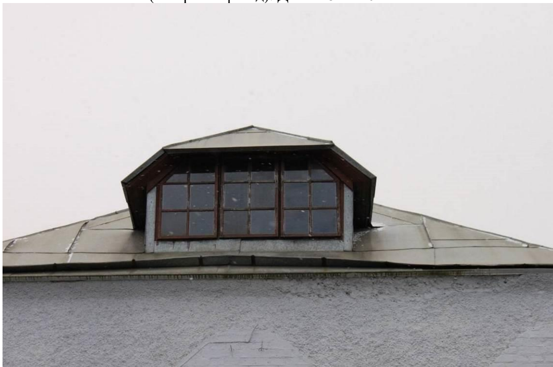
Фото 14. Объект культурного наследия регионального значения «Железнодорожная станция Левашово: вокзал» по адресу: г. Санкт-Петербург, п. Левашово, Железнодорожная ул., д. 7, лит. А (Левашово, железнодорожная станция. Вокзальное шоссе, 43). Вид на слуховое окно заднего фасада, являющимся предметом охраны (северный фасад). Дата: 28.11.2022 г.
