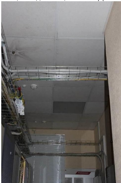
Фото 16 Объект культурного наследия регионального значения «Железнодорожная станция Левашово: вокзал» по адресу: г. Санкт-Петербург, п. Левашово, Железнодорожная ул., д. 7, лит. А (Левашово, железнодорожная станция. Вокзальное шоссе, 43). Вид на зашитый потолок в помещении №7. Дата: 28.11.2022 г.
