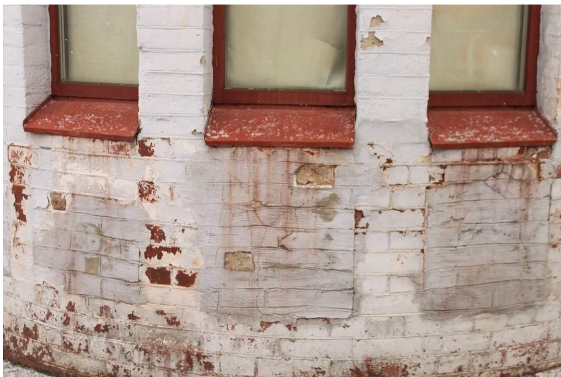
Фото 23. Объект культурного наследия регионального значения «Железнодорожная станция Левашово: вокзал» по адресу: г. Санкт-Петербург, п. Левашово, Железнодорожная ул., д. 7, лит. А (Левашово, железнодорожная станция. Вокзальное шоссе, 43). Вид на замененную кирпичную кладку (западный фасад). Дата: 28.11.2022 г.
