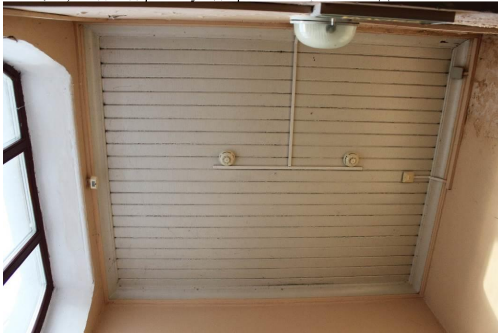
Фото 38. Объект культурного наследия регионального значения «Железнодорожная станция Левашово: вокзал» по адресу: г. Санкт-Петербург, п. Левашово, Железнодорожная ул., д. 7, лит. А (Левашово, железнодорожная станция. Вокзальное шоссе, 43). Вид на обшивку потолка в помещении №1, являющуюся предметом охраны. Дата: 28.11.2022 г.
