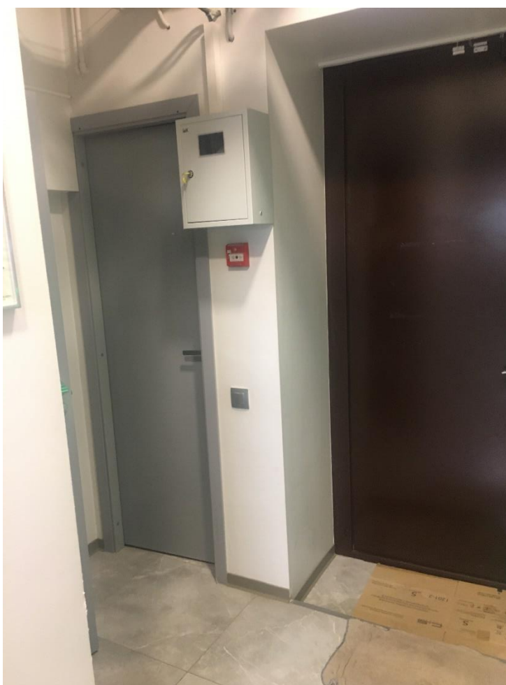
18. Фотофиксация 2-го этажа здания Невский пр., д.82, литера А. Квартира № 44. Коридор и выход на лестницу ЛК-2.
