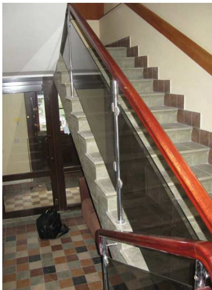
31. Лестничная клетка помещения 30-Н в уровне 1-го этажа объекта культурного наследия федерального значения «Дом, где в 1887-1891 гг. жил композитор Рубинштейн А.Г. Здесь в 1905-1906 гг. проходили заседания ЦК РСДРП», расположенного по адресу: г. Санкт-Петербург, Загородный пр., д. 9, литера А. 09.09.2022
