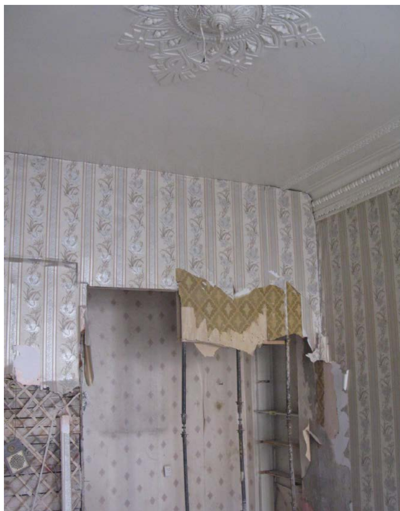
19. Помещение № 15 квартиры №13 в уровне 4-го этажа объекта культурного наследия федерального значения «Дом, где в 1887-1891 гг. жил композитор Рубинштейн А.Г. Здесь в 1905-1906 гг. проходили заседания ЦК РСДРП», расположенного по адресу: г. Санкт-Петербург, Загородный пр., д. 9, литера А. 09.09.2022
