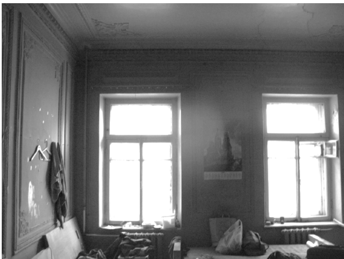
6. Помещение № 10 квартиры №14 в уровне 4-го этажа объекта культурного наследия федерального значения «Дом, где в 1887-1891 гг. жил композитор Рубинштейн А.Г. Здесь в 1905-1906 гг. проходили заседания ЦК РСДРП», расположенного по адресу: г. Санкт-Петербург, Загородный пр., д. 9, литера А. 09.09.2022
