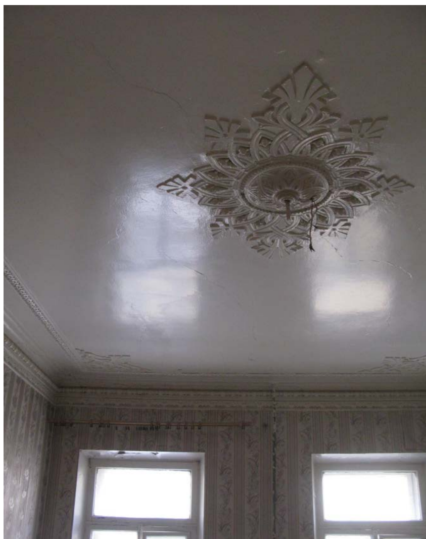
20. Помещение № 15 квартиры №13 в уровне 4-го этажа объекта культурного наследия федерального значения «Дом, где в 1887-1891 гг. жил композитор Рубинштейн А.Г. Здесь в 1905-1906 гг. проходили заседания ЦК РСДРП», расположенного по адресу: г. Санкт-Петербург, Загородный пр., д. 9, литера А. 09.09.2022
