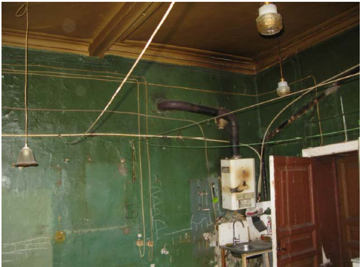
17. Помещение № 17 квартиры №14 в уровне 4-го этажа объекта культурного наследия федерального значения «Дом, где в 1887-1891 гг. жил композитор Рубинштейн А.Г. Здесь в 1905-1906 гг. проходили заседания ЦК РСДРП», расположенного по адресу: г. Санкт-Петербург, Загородный пр., д. 9, литера А. 09.09.2022
