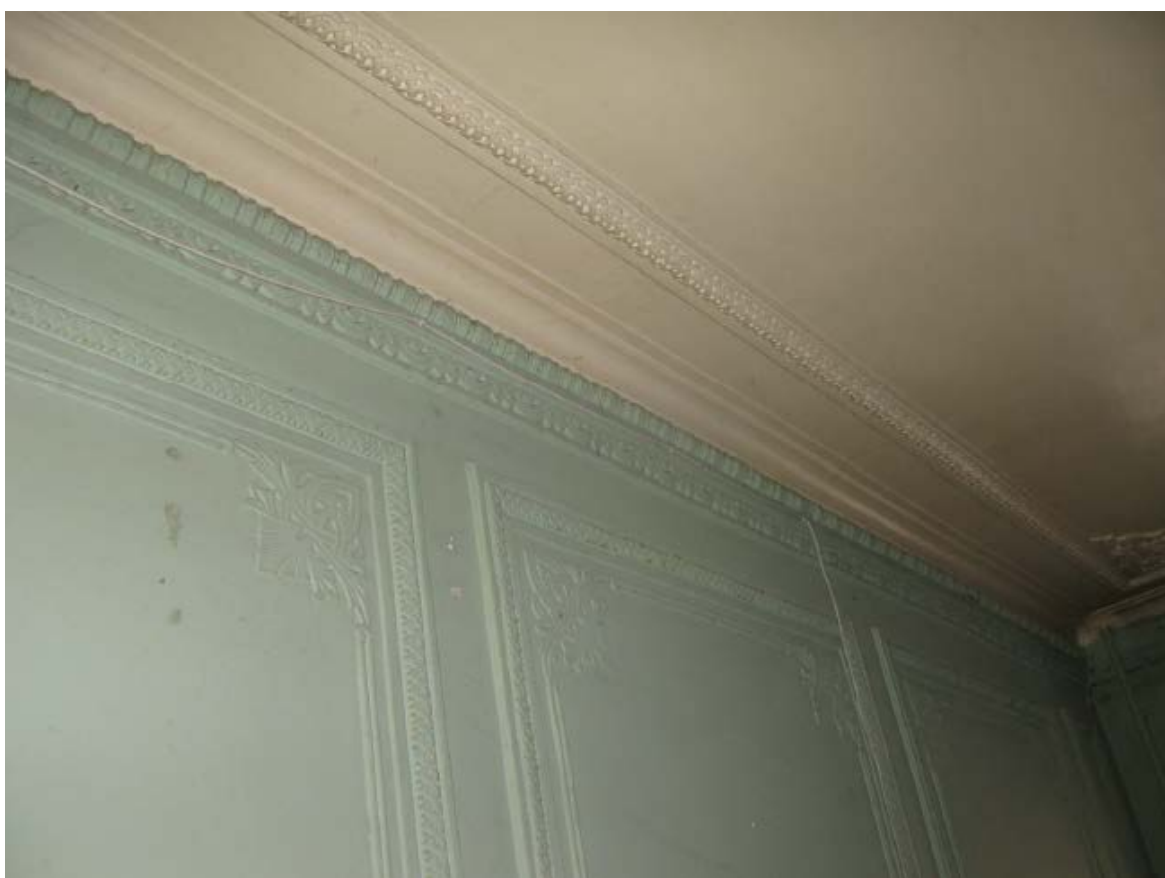
12. Помещение № 10 квартиры №14 в уровне 4-го этажа объекта культурного наследия федерального значения «Дом, где в 1887-1891 гг. жил композитор Рубинштейн А.Г. Здесь в 1905-1906 гг. проходили заседания ЦК РСДРП», расположенного по адресу: г. Санкт-Петербург, Загородный пр., д. 9, литера А. 09.09.2022
