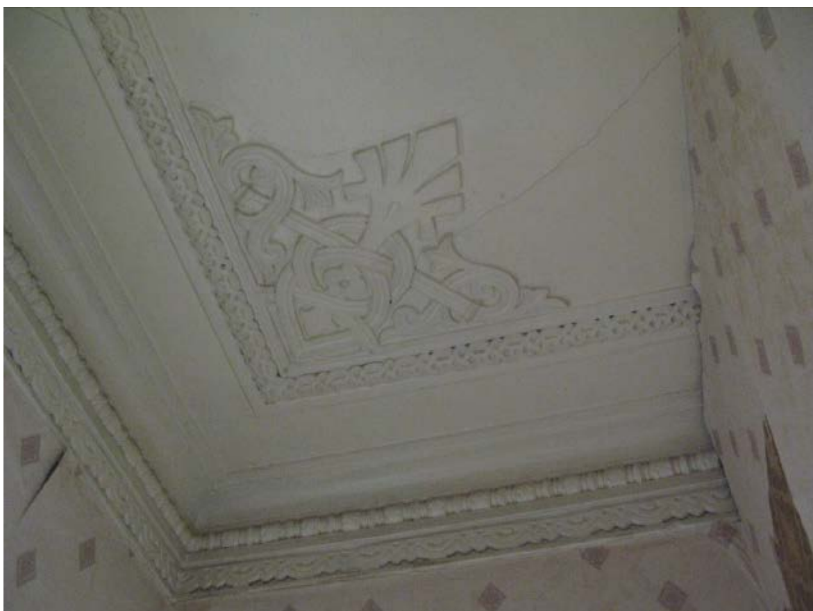
23. Помещение № 15 квартиры №13 в уровне 4-го этажа объекта культурного наследия федерального значения «Дом, где в 1887-1891 гг. жил композитор Рубинштейн А.Г. Здесь в 1905-1906 гг. проходили заседания ЦК РСДРП», расположенного по адресу: г. Санкт-Петербург, Загородный пр., д. 9, литера А. 09.09.2022
