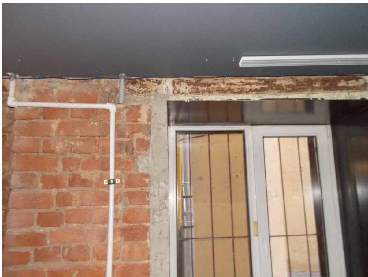
Фото 4 – Фрагмент окна 1120x1750мм. Перемычка Двугавр №13
