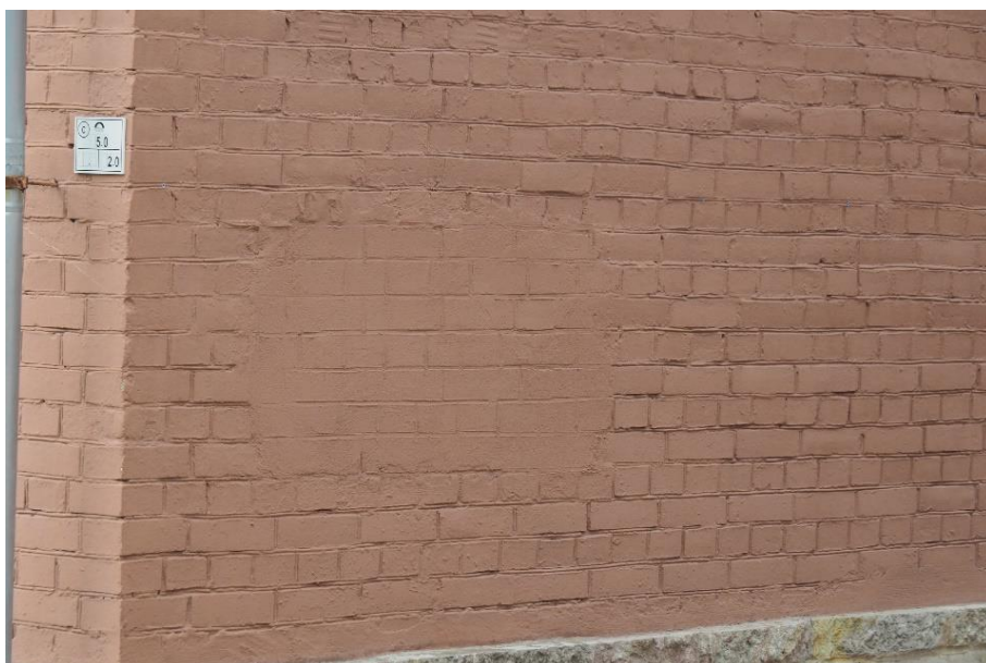
10. "Служебное здание" в составе ансамбля "Комплекс главной станции Санкт-Петербургских городских водопроводов", ул. Шпалерная, д. 56, лит. Р. Северный фасад. Фрагмент. Фото 08.08.2022г.
