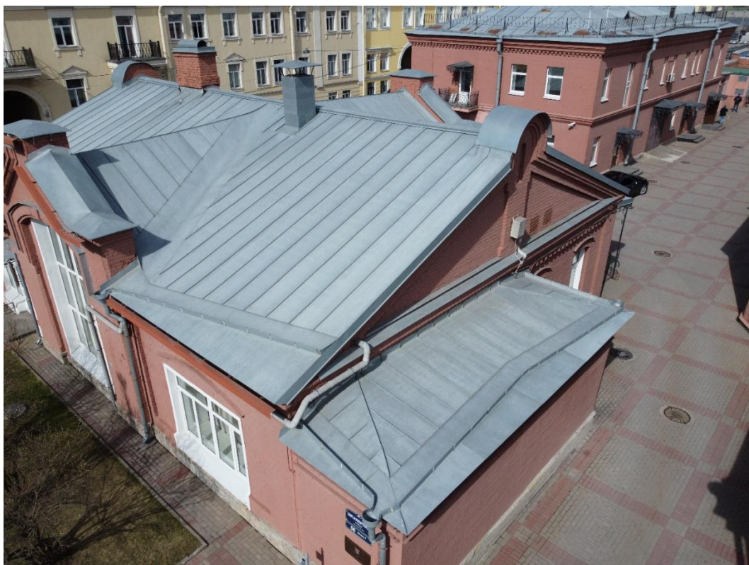
5. "Службное здание" в составе ансамбля "Комплекс главной станции Санкт-Петербургских городских водопроводов", ул. Шпалерная, д. 56, лит. Р. Восточный фасад. Общий вид. Фото 08.08.2022г.
