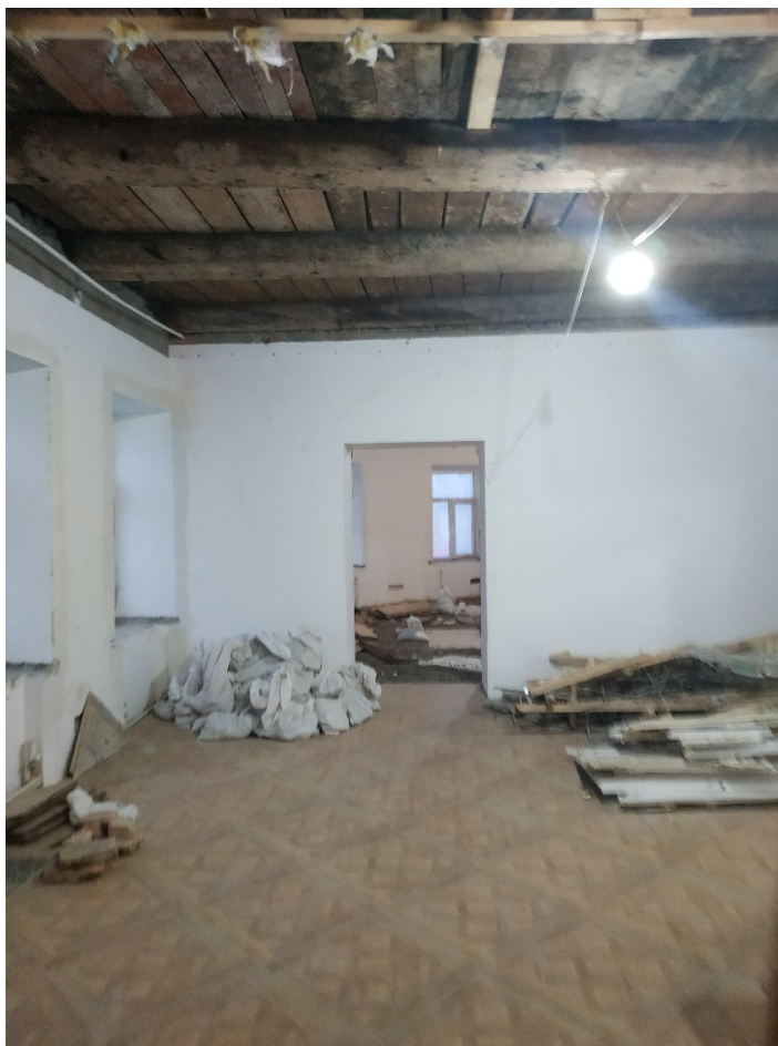
Фото 31. Отсутствие внешней отделки, складирование строительного мусора.
