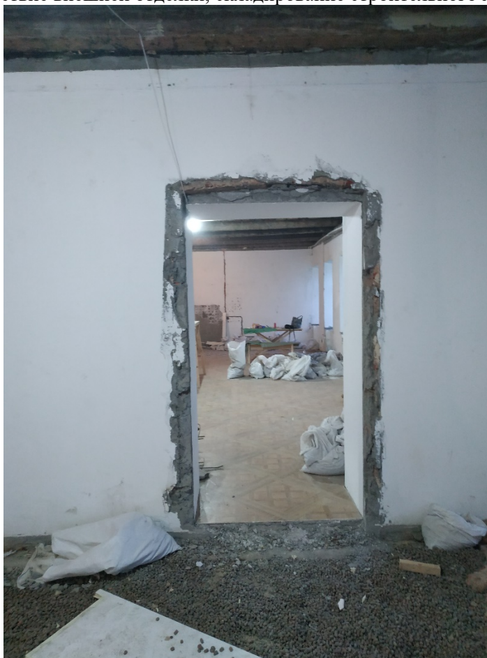
Фото 34. Отсутствие внешней отделки, складирование строительного мусора.
