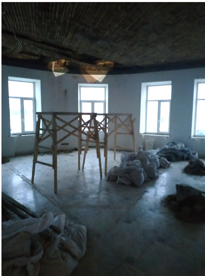
Фото 17. Отсутствие внешней отделки, складирование строительного мусора.
