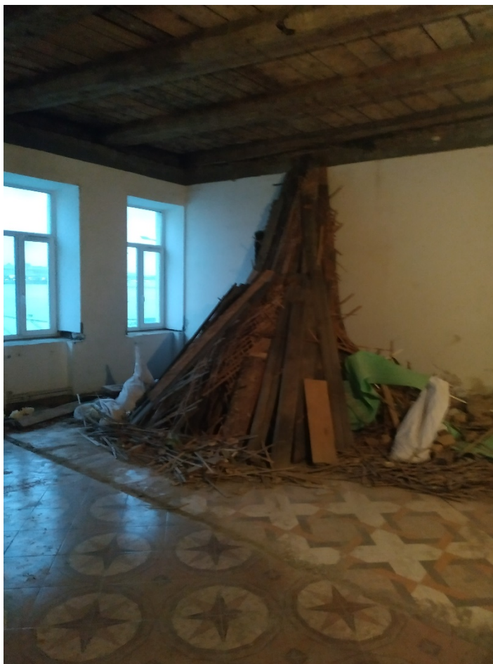
Фото 9. Отсутствие внешней отделки, складирование строительного мусора.
