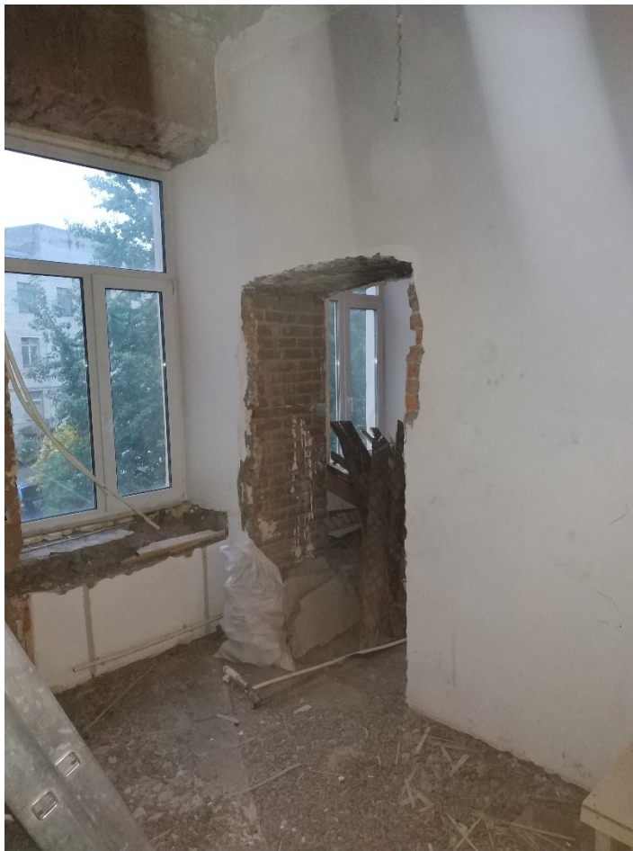
Фото 5. Отсутствие внешней отделки, складирование строительного мусора. Частичная вывалка кирпича в дверном проёме.
