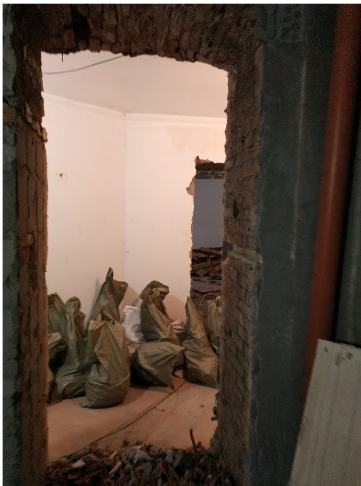
Фото 25. Отсутствие внешней отделки, складирование строительного мусора.
