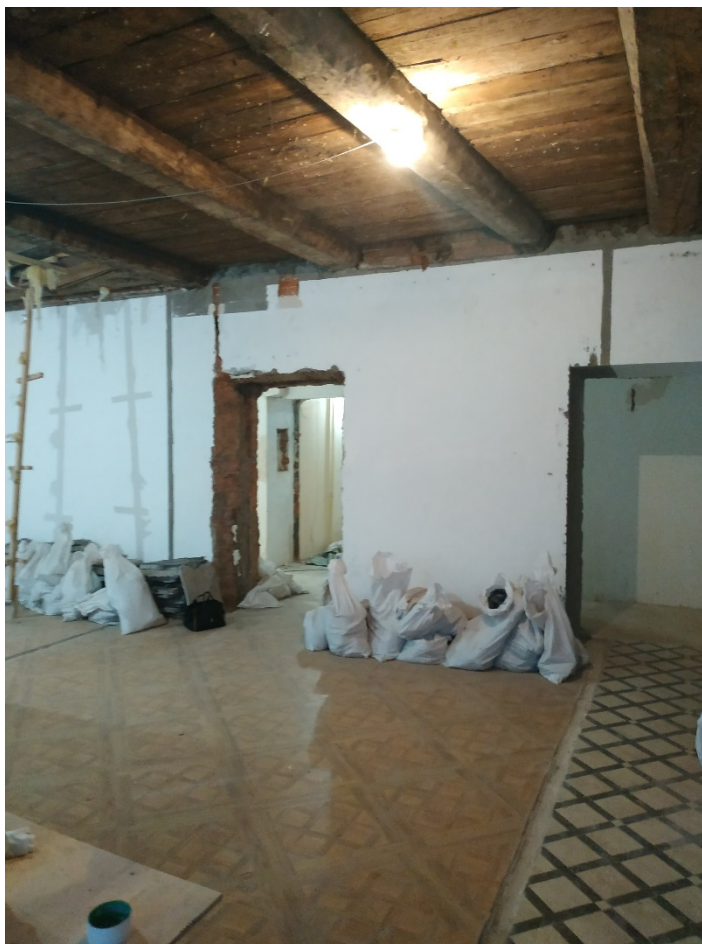
Фото 29. Отсутствие внешней отделки, складирование строительного мусора.
