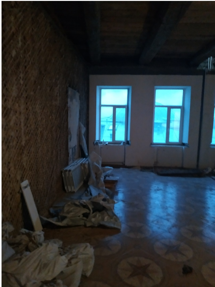
Фото 7. Отсутствие внешней отделки, складирование строительного мусора.
