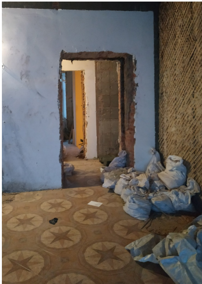
Фото 12. Отсутствие внешней отделки, складирование строительного мусора.
