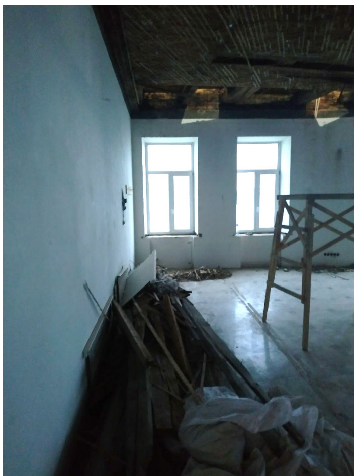
Фото 18. Отсутствие внешней отделки, складирование строительного мусора.
