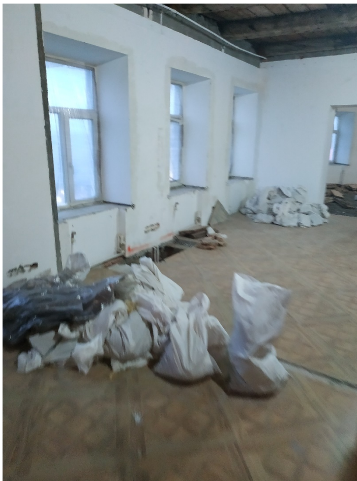
Фото 30. Отсутствие внешней отделки, складирование строительного мусора.
