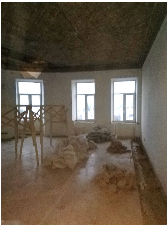
Фото 16. Отсутствие внешней отделки, складирование строительного мусора.
