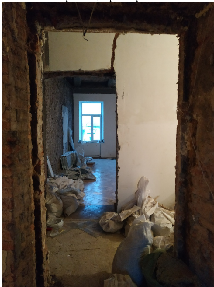
Фото 6. Отсутствие внешней отделки, складирование строительного мусора.
