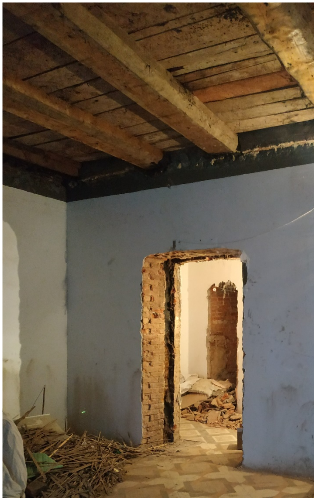
Фото 11. Отсутствие внешней отделки, складирование строительного мусора.
