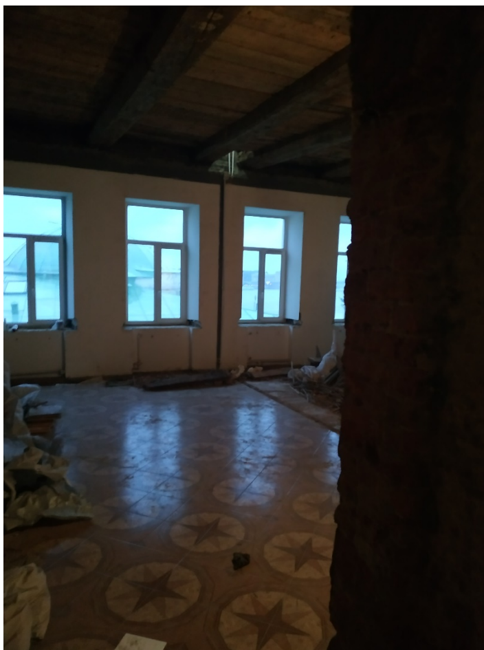
Фото 8. Отсутствие внешней отделки, складирование строительного мусора.
