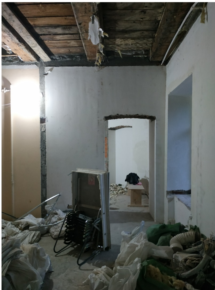
Фото 23. Лестница ЗЛК, 3 этаж. Отсутствие внешней отделки, складирование строительного мусора.
