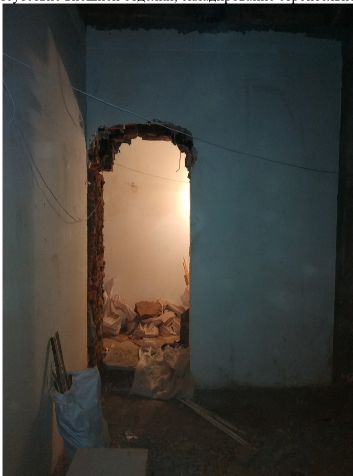
Фото 4. Отсутствие внешней отделки, складирование строительного мусора. Частичная вывалка кирпича в дверном проёме.
