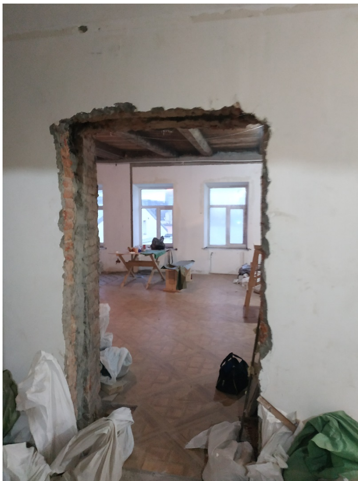
Фото 26. Отсутствие внешней отделки, складирование строительного мусора.
