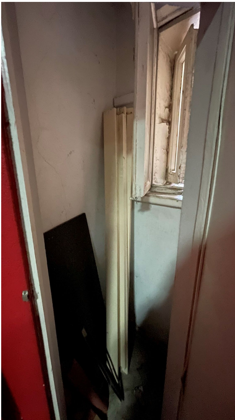
14. Вид на шкаф (помещение 5);
