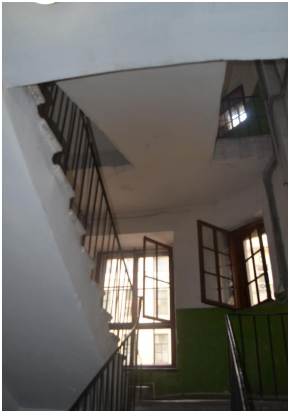
31. Выявленный объект культурного наследия «Дом Глазуновых». Южная лестница западного дворового флигеля(ЛК 2). Конструкция маршей и межэтажных площадок. Вид с запада. Съемка 26.04.2021
