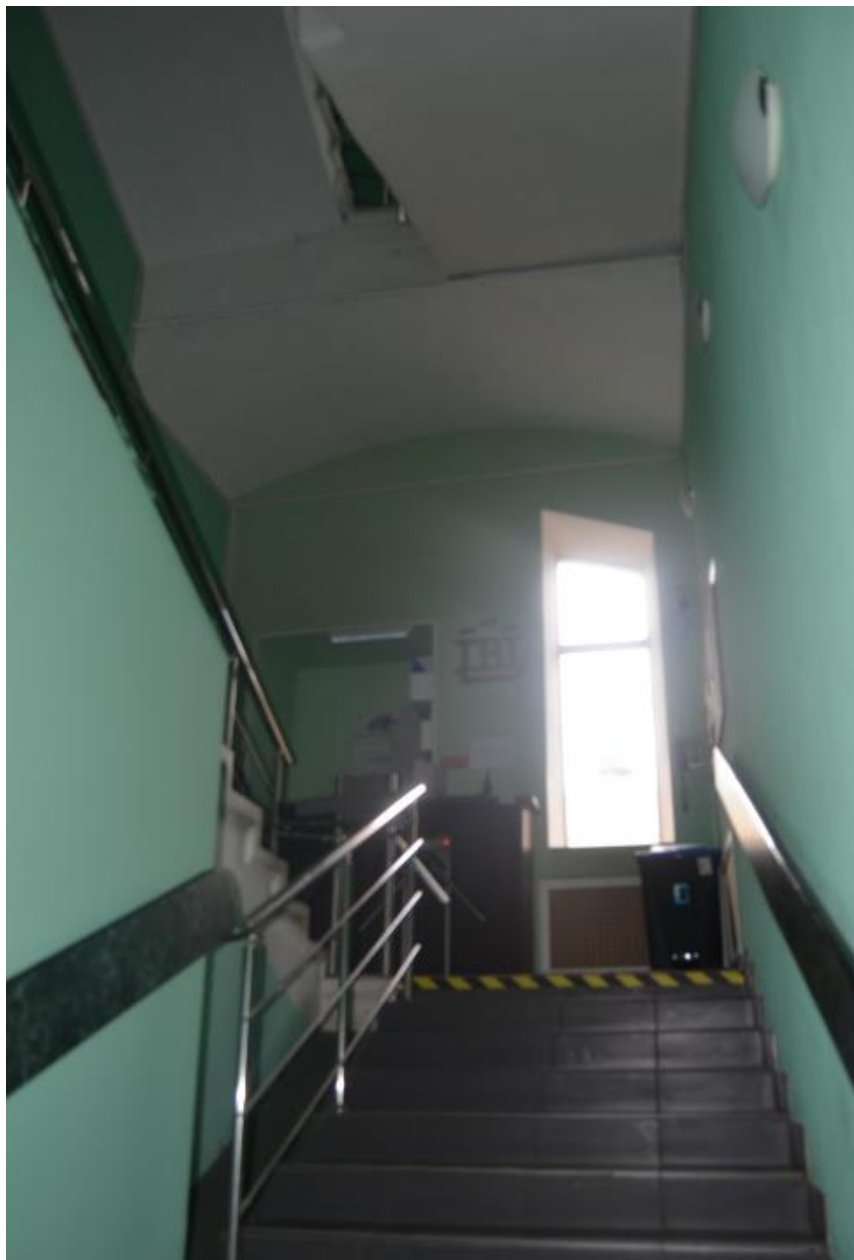
29. Выявленный объект культурного наследия «Дом Глазуновых». Западная лестница южного лицевого фасада лицевого дома (ЛК 1). Общий вид лестницы. Вид с юга. Съемка 26.04.2021
