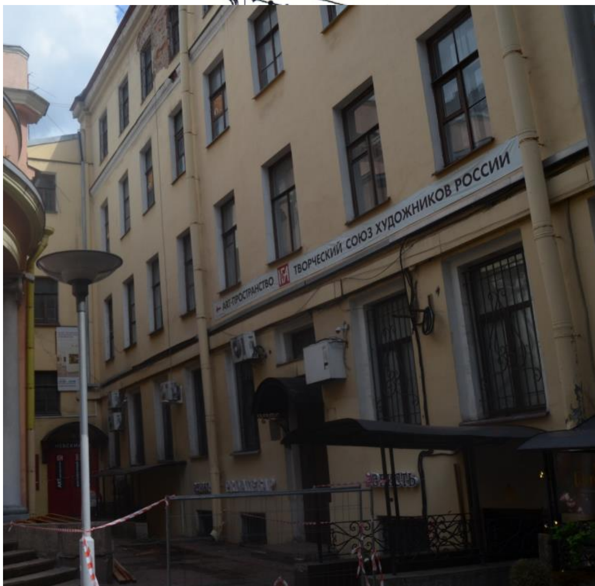
21. Выявленный объект культурного наследия «Дом Глазуновых». Восточный дворовый флигель. Северная часть западного фасада и соединение с корпусом кинотеатра «Аврора». Вид с юга. Съемка 26.04.2021
