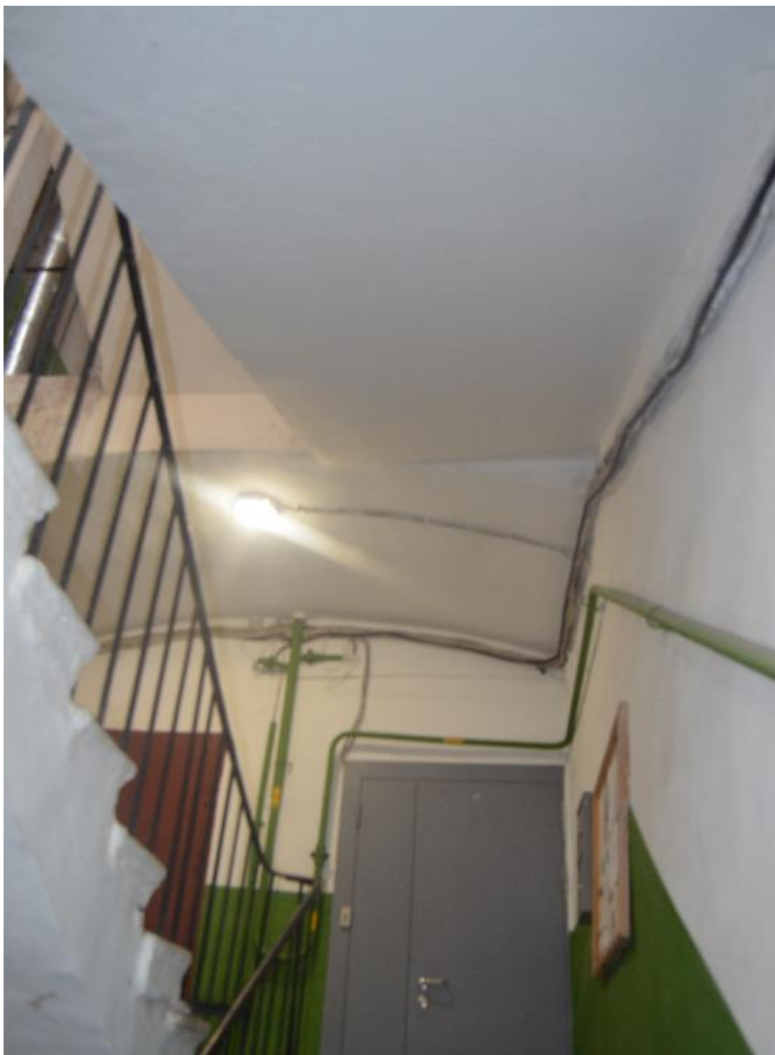
30. Выявленный объект культурного наследия «Дом Глазуновых». Южная лестница западного дворового флигеля(ЛК 2). Вид с востока. Съемка 26.04.2021
