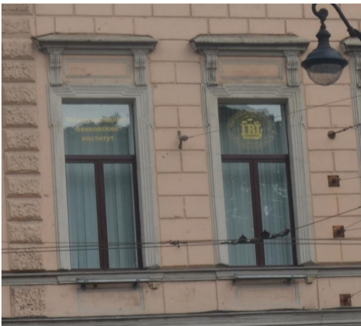
б. Выявленный объект культурного наследия «Дом Глазуновых». Лицевой (южный) фасад лицевого дома. Оформление третьего этажа фасада. Вид с юга. Съемка 26.04.2021
