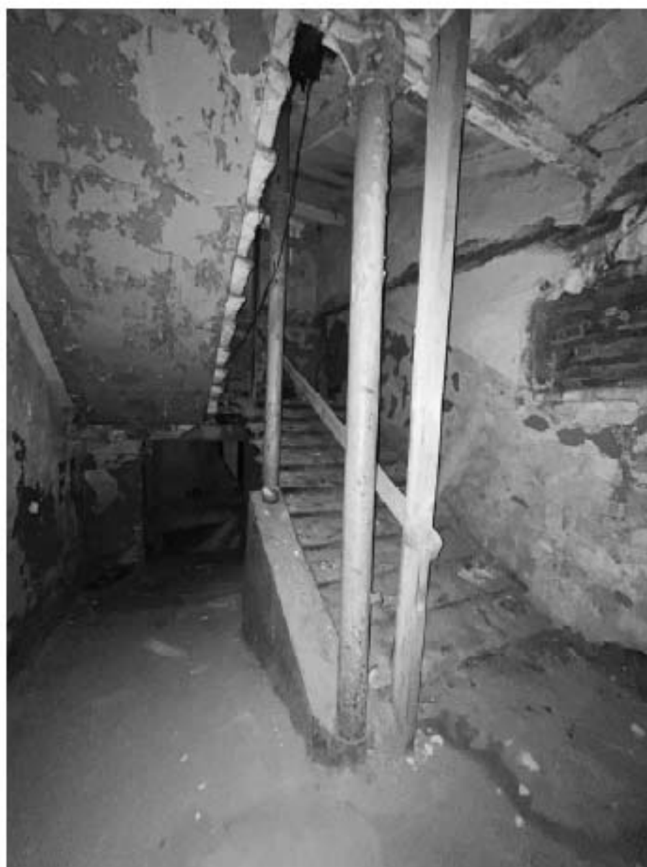
Фото №20. Объект культурного наследия регионального значения «Сельдяной ряд Никольского рынка», подвал, пом. 3-ЛК.
