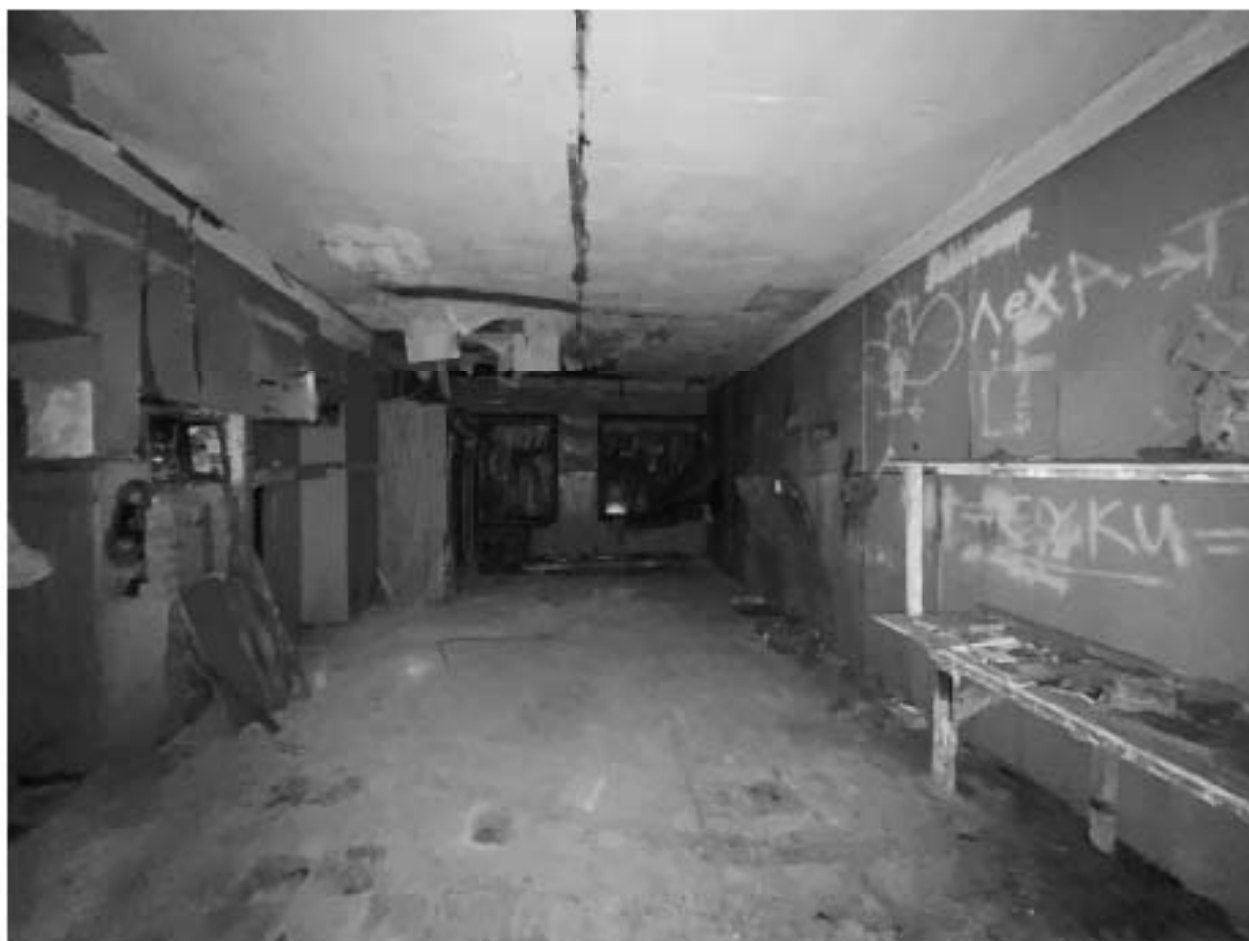
Фото №48. Объект культурного наследия регионального значения «Сельдяной ряд Никольского рынка», помещения третьего этажа.
