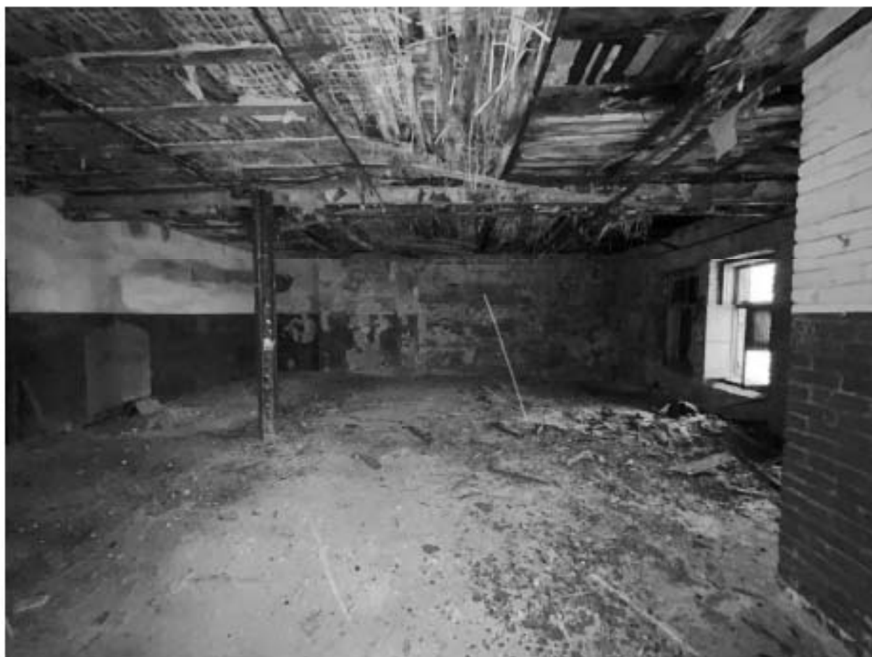
Фото №47. Объект культурного наследия регионального значения «Сельдяной ряд Никольского рынка», помещения третьего этажа.
