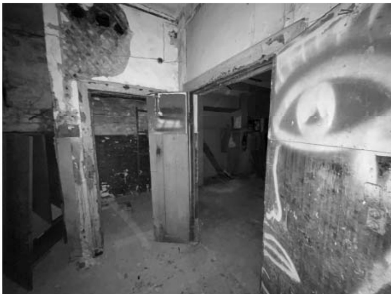
Фото №44. Объект культурного наследия регионального значения «Сельдяной ряд Никольского рынка», помещения третьего этажа.
