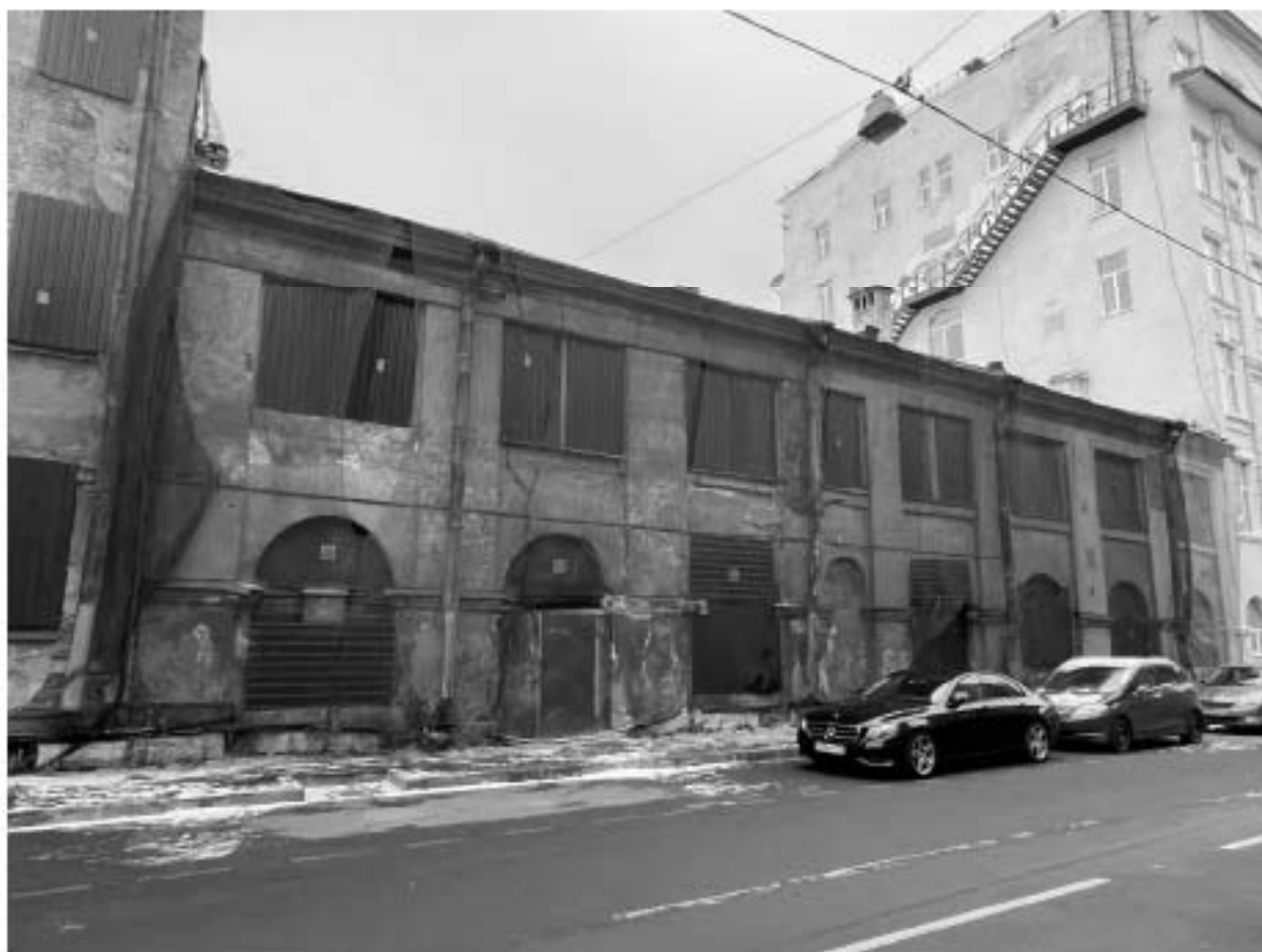
Фото №2. Объект культурного наследия регионального значения «Сельдяной ряд Никольского рынка», юго-западный фасад, двухэтажная восточная часть.
