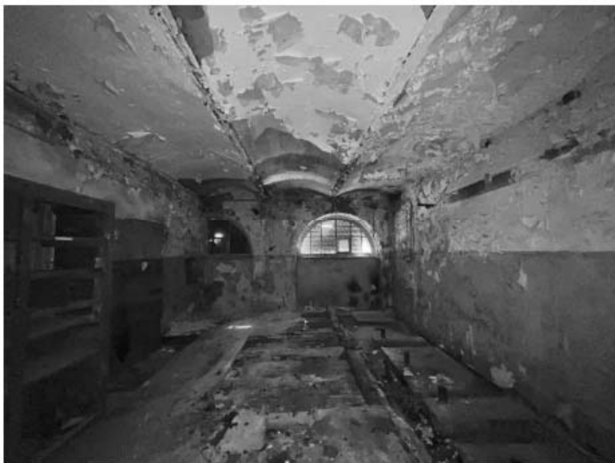
Фото №21. Объект культурного наследия регионального значения «Сельдяной ряд Никольского рынка», подвал, пом. 5-Н (4).
