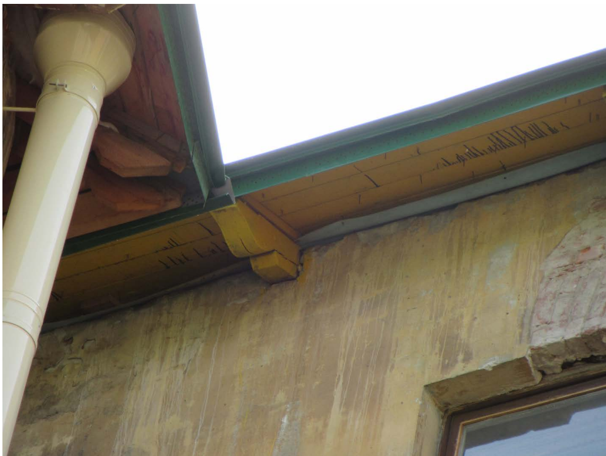
48. 15-я линия В.О., 70. Дом М.М. Кудрявцева. Фрагмент свесов кровли с деревянной подшивкой на кобылках западного двора.
