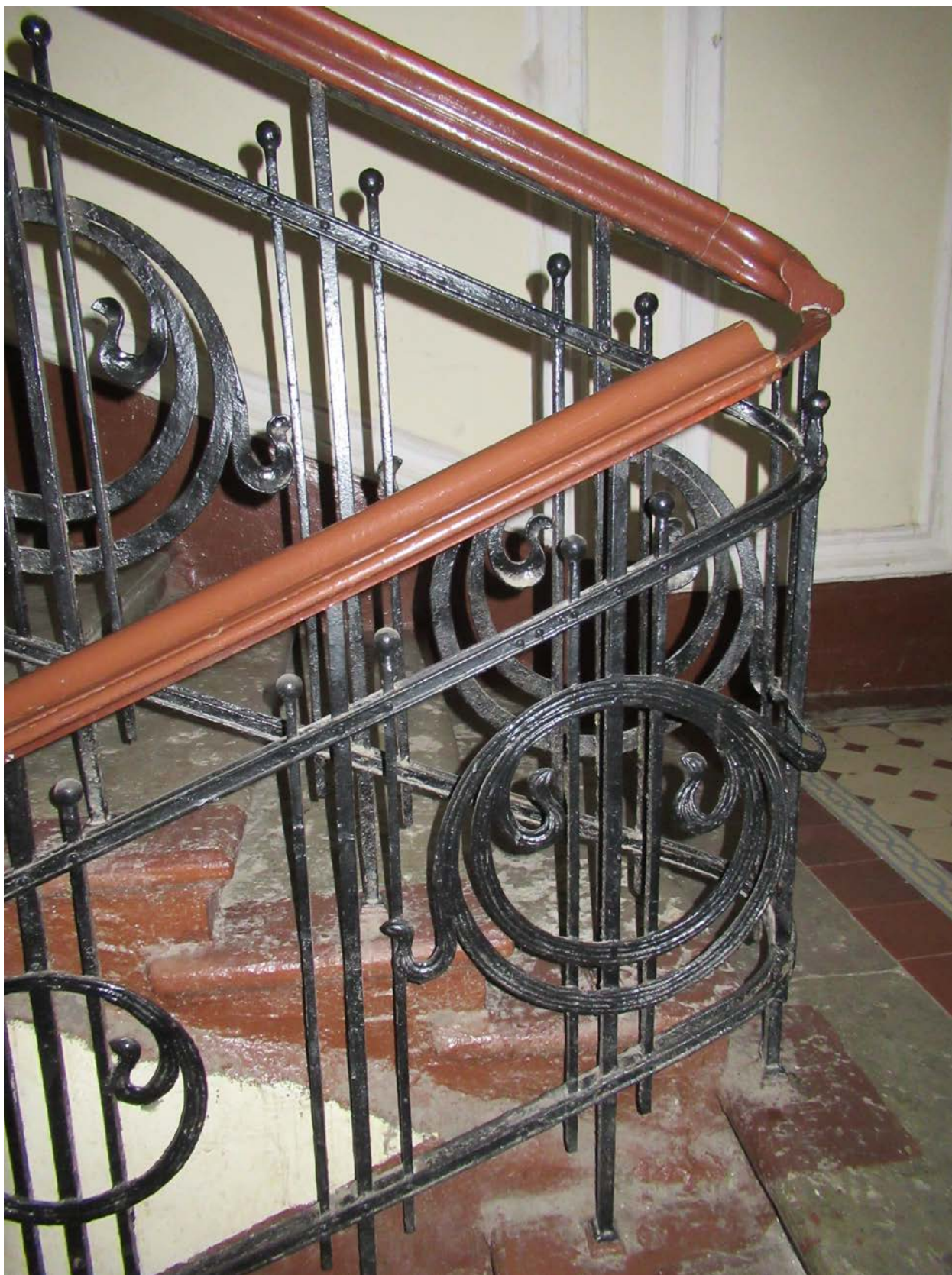
64. 15-я линия В.О., 70. Дом М.М. Кудрявцева. 1ЛК (парадная лестница). Фрагмент металлического ограждения лестничного марша.
