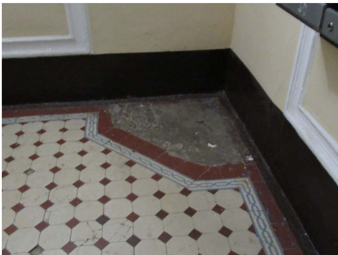
75. 15-я линия В.О., 70. Дом М.М. Кудрявцева. БЛК, пол вестибюля, покрытый метлахской плиткой с местом для угловой печи.
