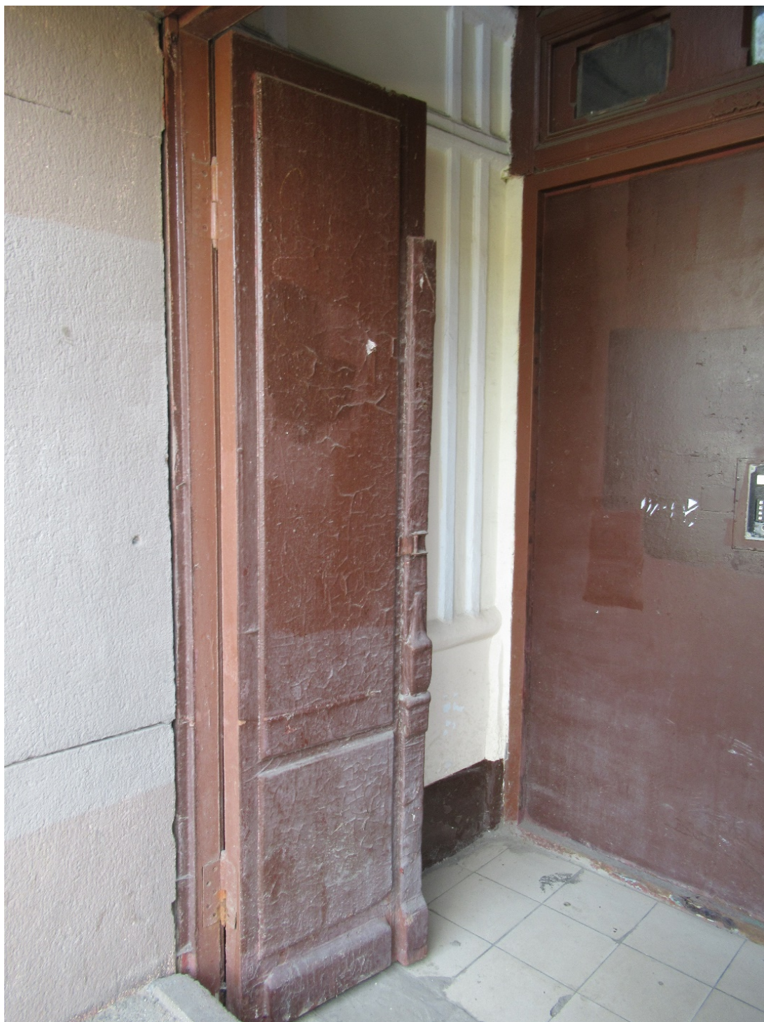
13. 15-я линия В.О., 70. Дом М.М. Кудрявцева. Деревянное заполнение дверного проема лицевого фасада.
