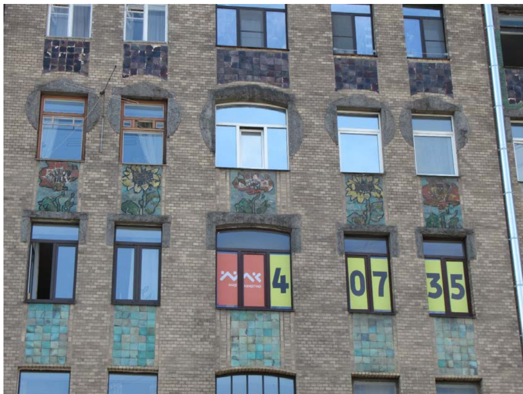
5. 15-я линия В.О., 70. Дом М.М. Кудрявцева. Центральная часть лицевого фасада в уровне 4-5 этажей.
