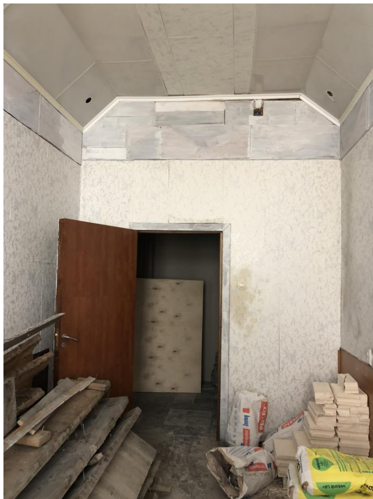
12. Объект культурного наследия федерального значения «Дом Демидова П.Г.», входящий в состав объекта культурного наследия федерального значения «Усадьба Демидовых» по адресу: г. Санкт-Петербург, пер. Гривцова, д. 5, лит. А (Гривцова пер., 1). Квартира №28. Жилая комната (помещение №3 (комната) согласно техническому паспорту. Вид в сторону дверного проема.
