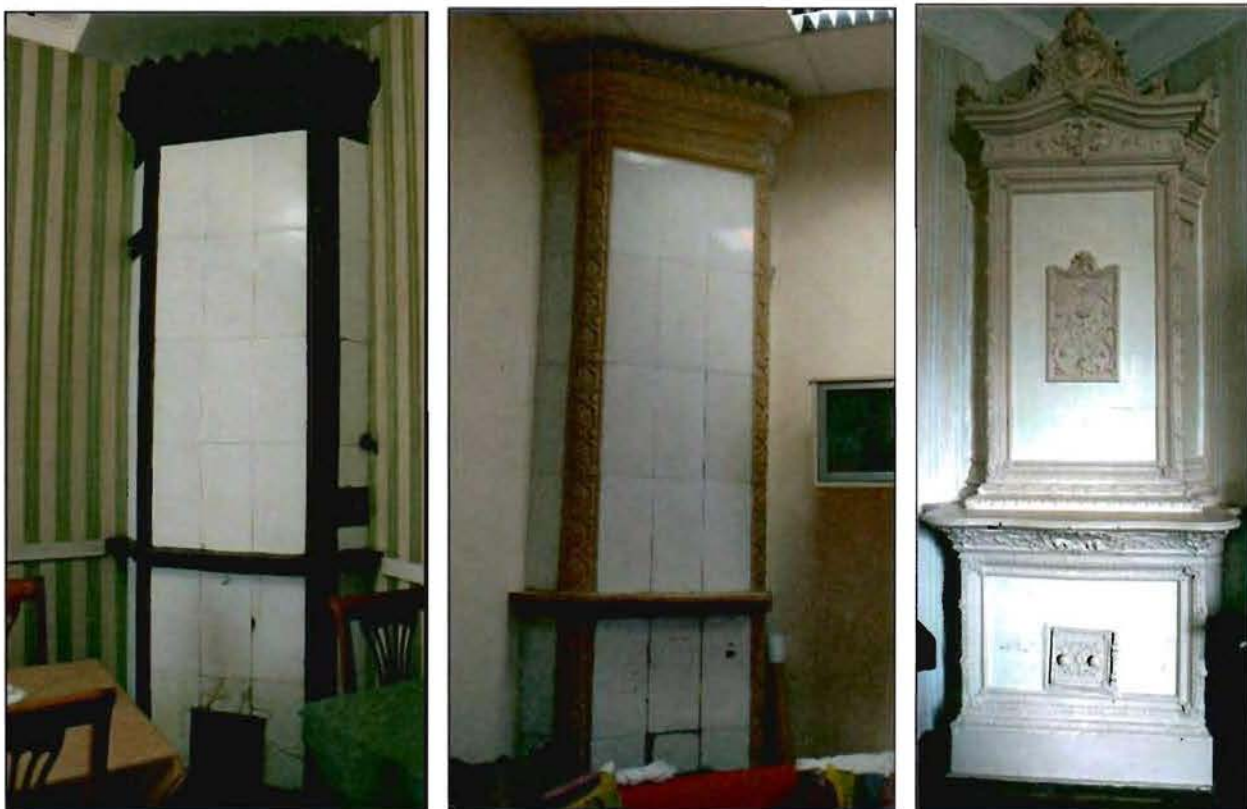
Фото №17-19. Печь угловая (кв. 29, 30, пом. 52-Н).
