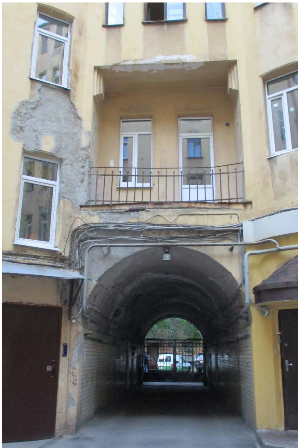
13. Санкт-Петербург, Василеостровский район, 11 линия В.О., дом 20, литера А. Лицевой корпус, фрагмент дворового фасада.
