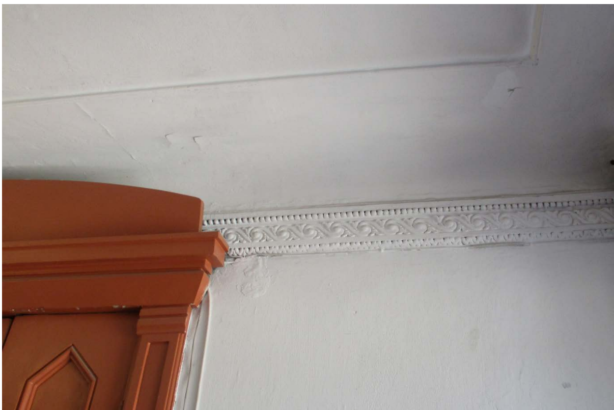
8. Санкт-Петербург, Василеостровский район, 11 линия В.О., дом 20, литера А. Лицевой корпус. Интерьер. Лестница Л-1 (южная). Декоративное оформление плафона лестничной клетки.
