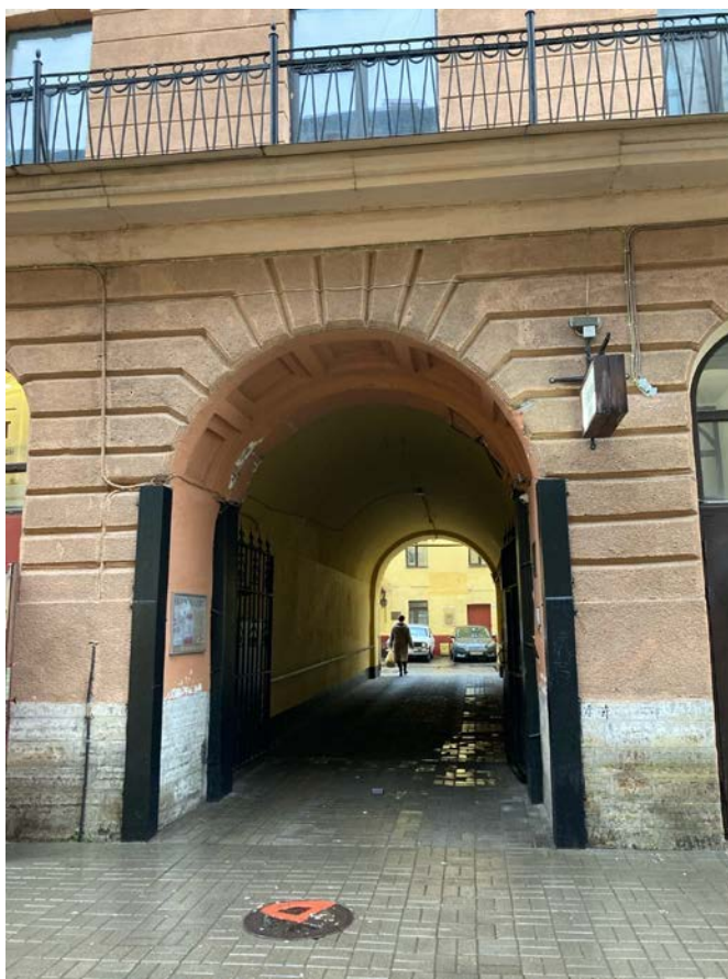
Фото 7. Фрагмент лицевого фасада выявленного объекта культурного наследия «Дом Зверкова (И.С. Никитина)», воротный проезд
