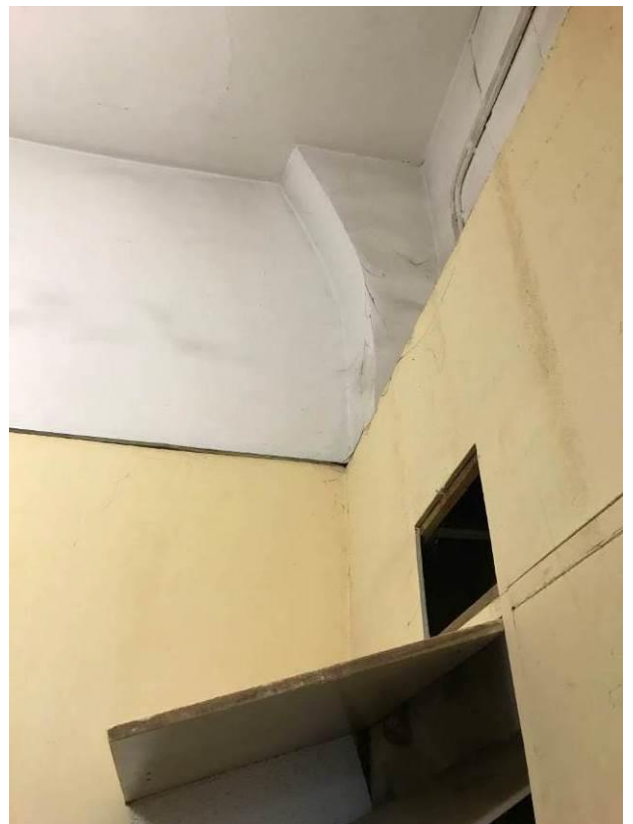
15. Малый Гостиный двор. Новая Банковская линия. Помещение 10-Н, 1-й этаж. Выход на лестницу. Штиглиц М.С. 28.09.2022 г.
