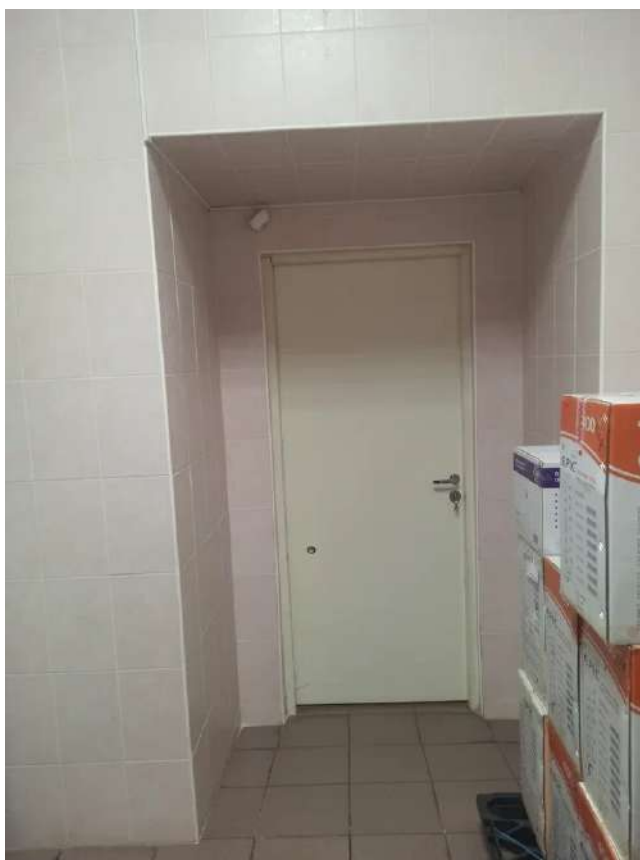
Фото 52. Помещение 126. Фрагмент вида дверного проема выхода в помещение 138.
