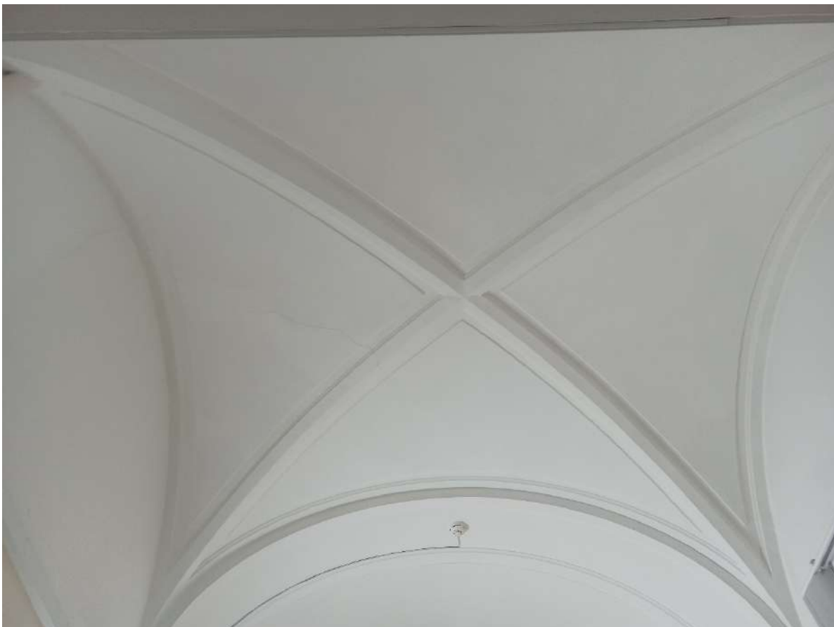
Фото 11. Помещение №138 по плану ПИБ. Фрагмент вида сводов. Волосяная трещина по парусам сводов.
