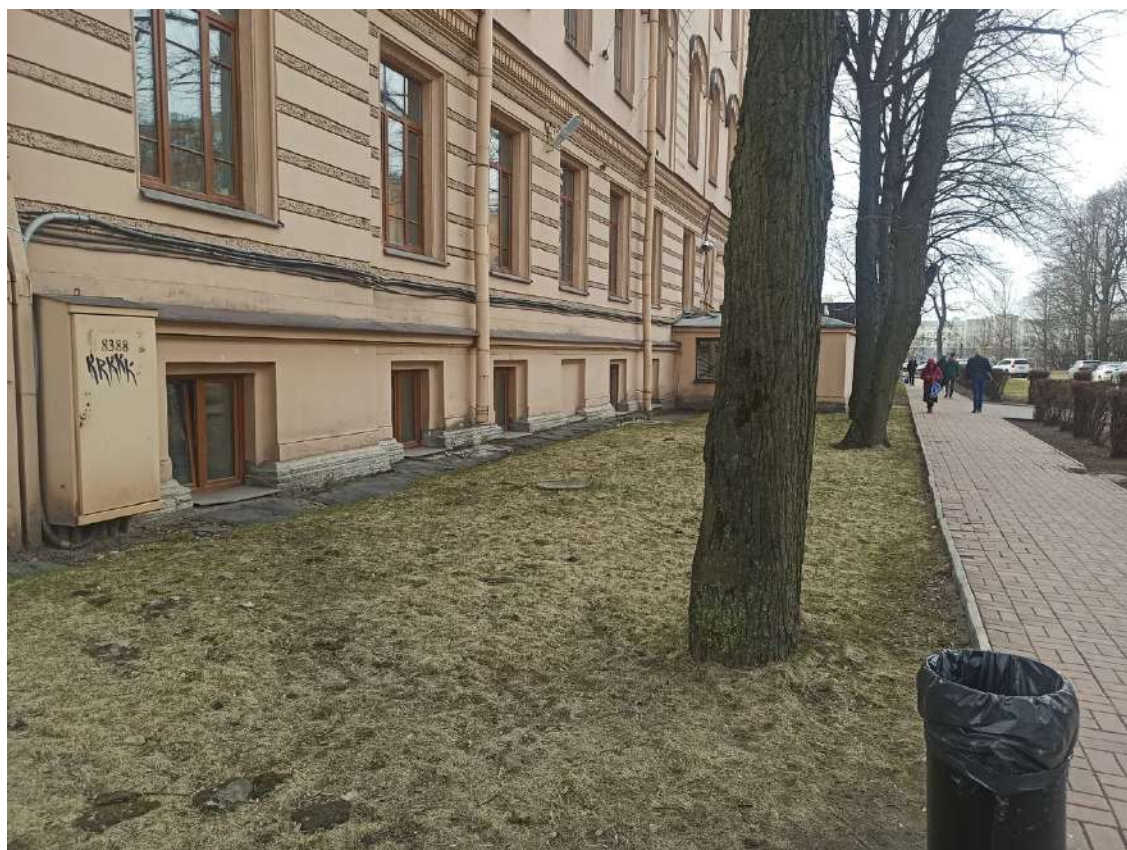
Фото 4. Фрагмент вида окон со стороны двора в границах проектируемых помещений
