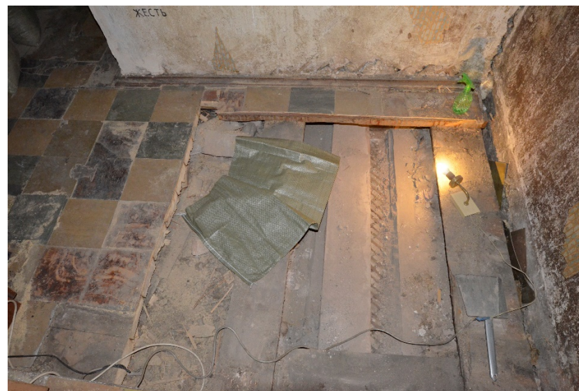
Фото 26. Фрагмент пола в коридоре № 7 (с участком вскрытия предпроектных исследований).
