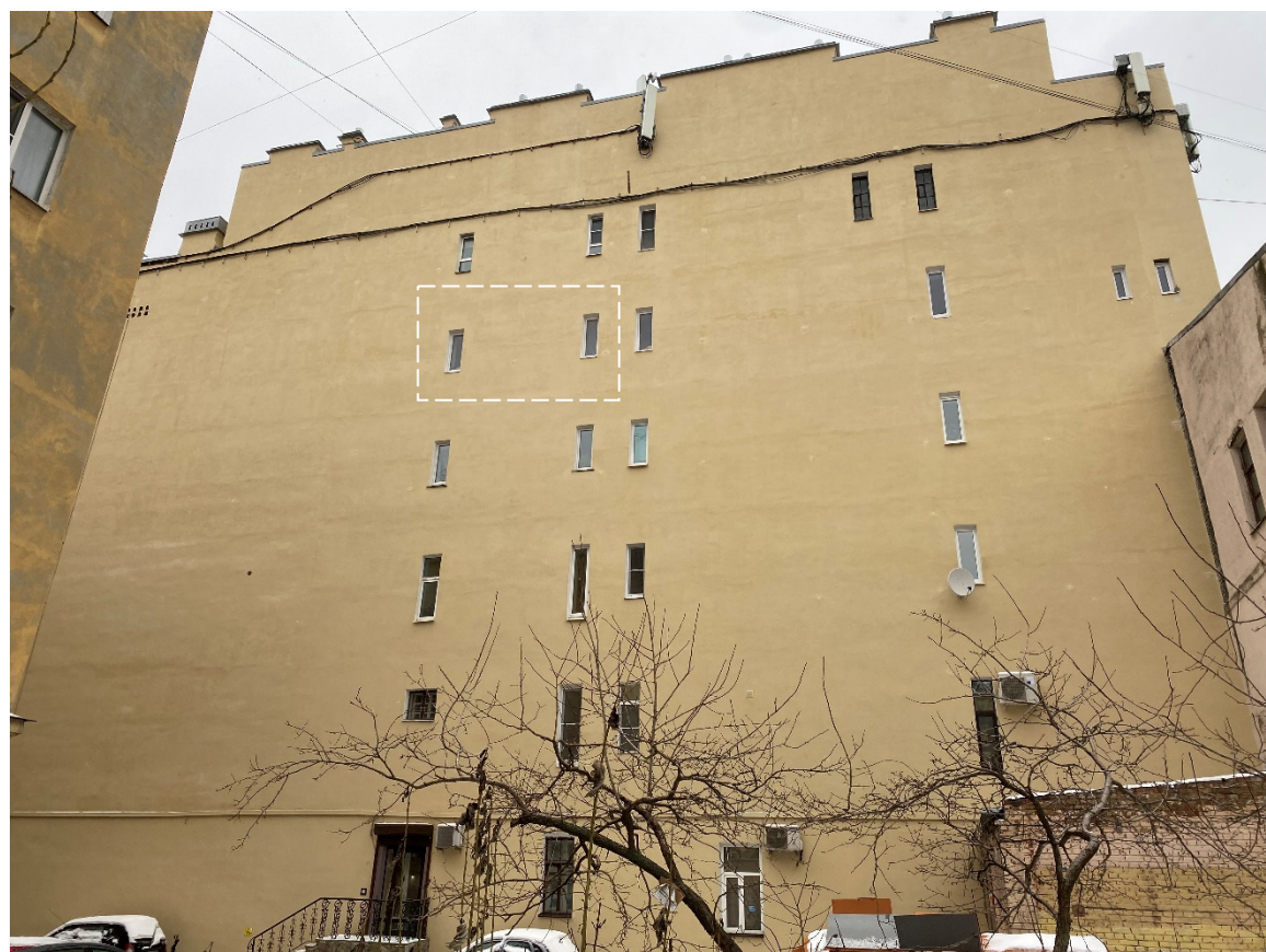
Фото 6. Фрагмент южного торцевого фасада с обозначением оконных проемов квартиры № 20 в уровне 5-го этажа.
