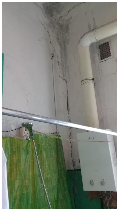
Фото 20. Трещины отделки в помещении ванной № 6.
