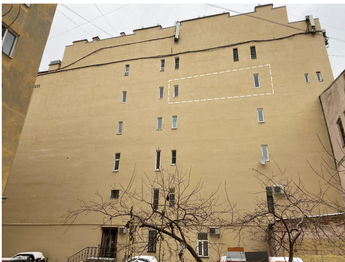
Фото 4. Фрагмент южного торцевого фасада с обозначением оконных проемов квартиры № 30 в уровне 5-го этажа.
