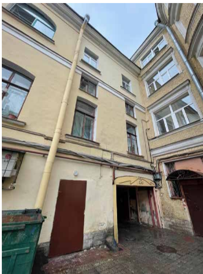
14. Дворовый фасад лицевого корпуса (фрагмент по световым осям 12–13). Дворовый корпус в месте примыкания к лицевому. Выявленный объект культурного наследия «Дом Ю. Н. Адельсон», расположенный по адресу: г. Санкт-Петербург, Гороховая ул, дом 33, литера А
