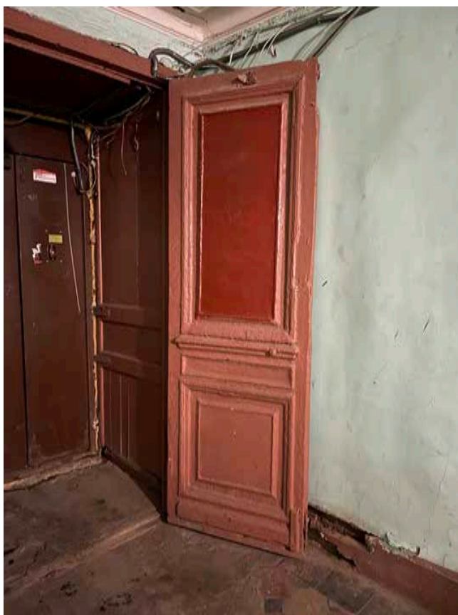
43. Деревянное дверное заполнение парадной. Выявленный объект культурного наследия «Дом Ю. Н. Адельсон», расположенный по адресу: г. Санкт-Петербург, Гороховая ул, дом 33, литера А
