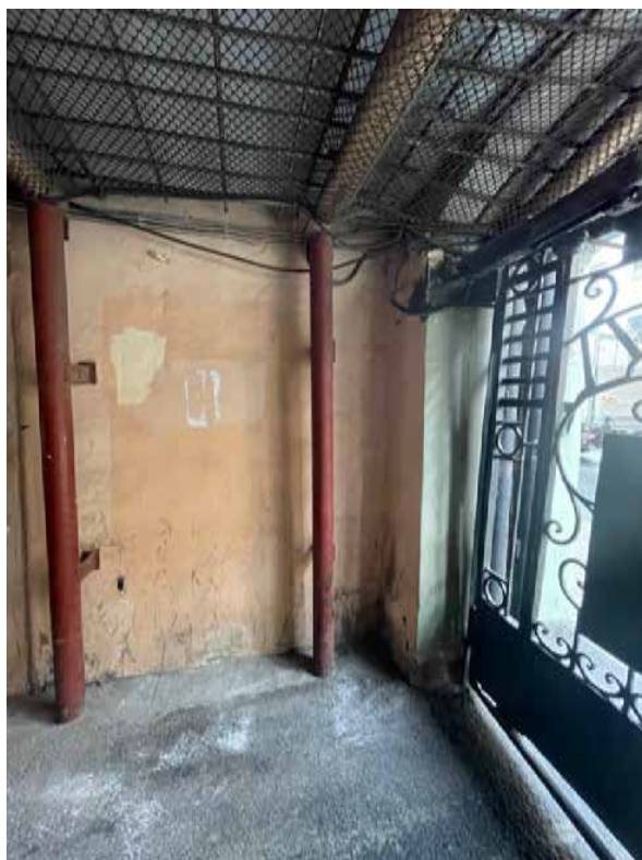
36. Проездная арка лицевого корпуса (фрагмент). Выявленный объект культурного наследия «Дом Ю. Н. Адельсон», расположенный по адресу: г. Санкт-Петербург, Гороховая ул, дом 33, литера А
