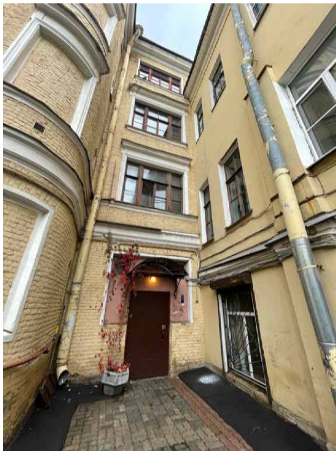
20. Дворовый фасад лицевого корпуса (фрагмент по световым осям 1, 2). Дворовый корпус в месте примыкания к лицевому. Выявленный объект культурного наследия «Дом Ю. Н. Адельсон», расположенный по адресу: г. Санкт-Петербург, Гороховая ул, дом 33, литера А
