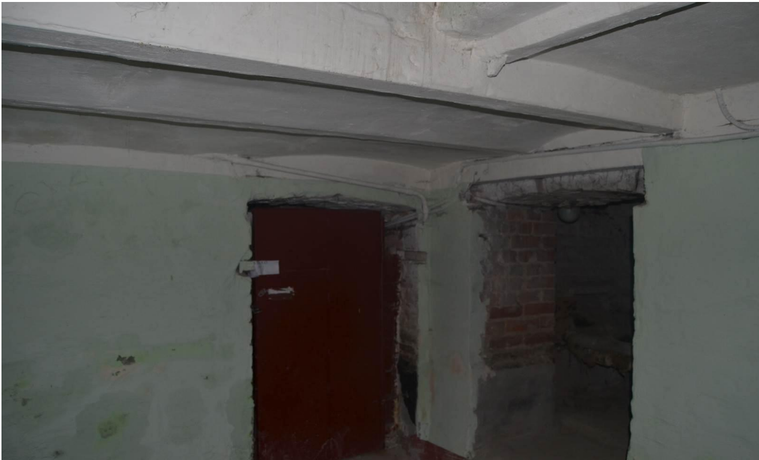
47. Выявленный объект культурного наследия «Дом А.Р. Гешвенда». Подвальные помещения северного дворового флигеля. Вид с северо-запада. Съемка 21.05.2021. Автор съемки Егорова Т.Г.
