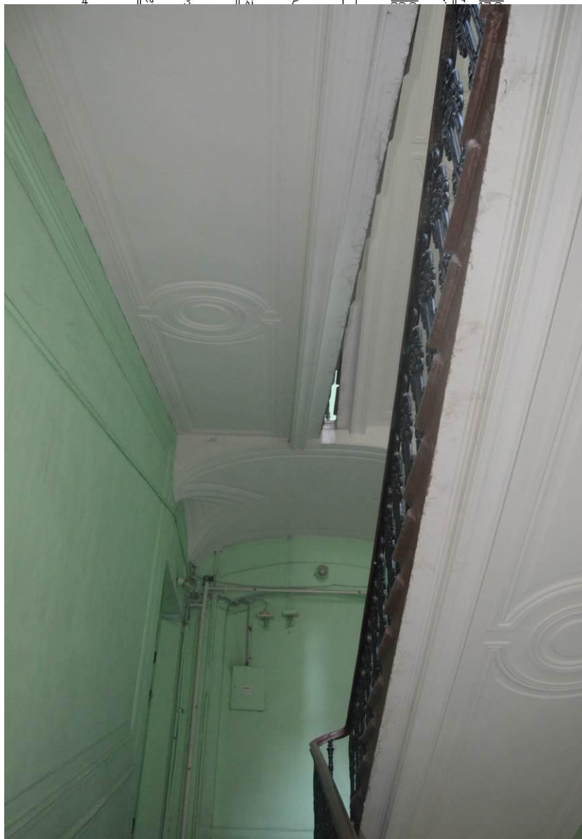
28. Выявленный объект культурного наследия «Дом А.Р. Гешвенда». Парадная лестница. Лестничные марши. Вид с юго-запада. Съемка 21.05.2021. Автор съемки Егорова Т.Г.
