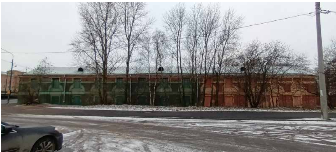
2а. Объект культурного наследия регионального значения «Хлебные амбары Александроневской лавры (5 корпусов)». Корпус по адресу: г. СПб, набережная Обводного канала, дом 3, литера А. Общий вид на продольный юго-восточный фасад (с юго-восточной стороны). Южное окончание фасада. 21 декабря 2022 г.
