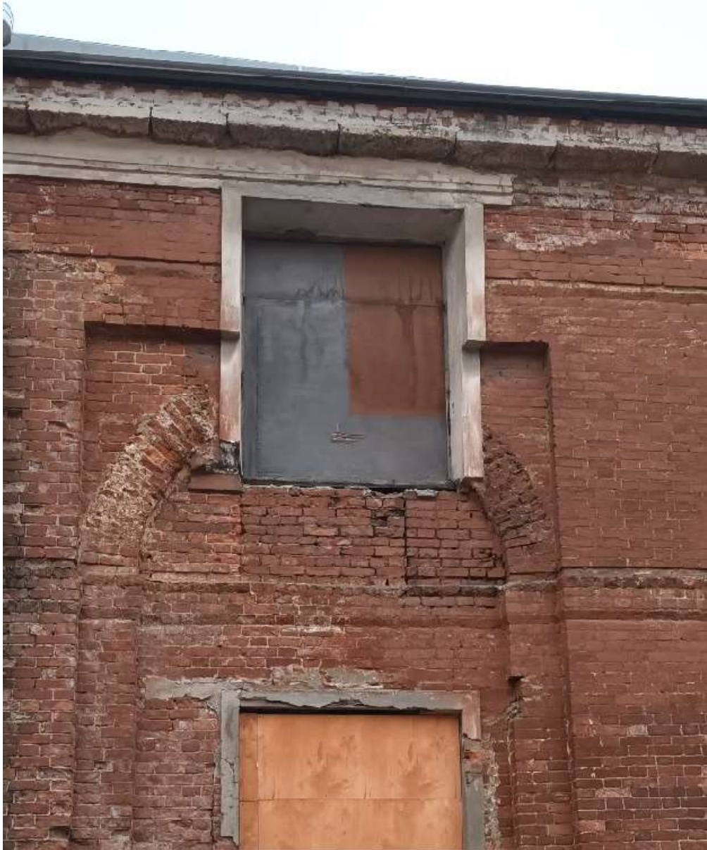
20. Объект культурного наследия регионального значения «Хлебные амбары Александроневской лавры (5 корпусов)». Корпус по адресу: г. СПб, набережная Обводного канала, дом 3, литера А. Фрагмент продольного северо-западного фасада. 21 декабря 2022 г.
