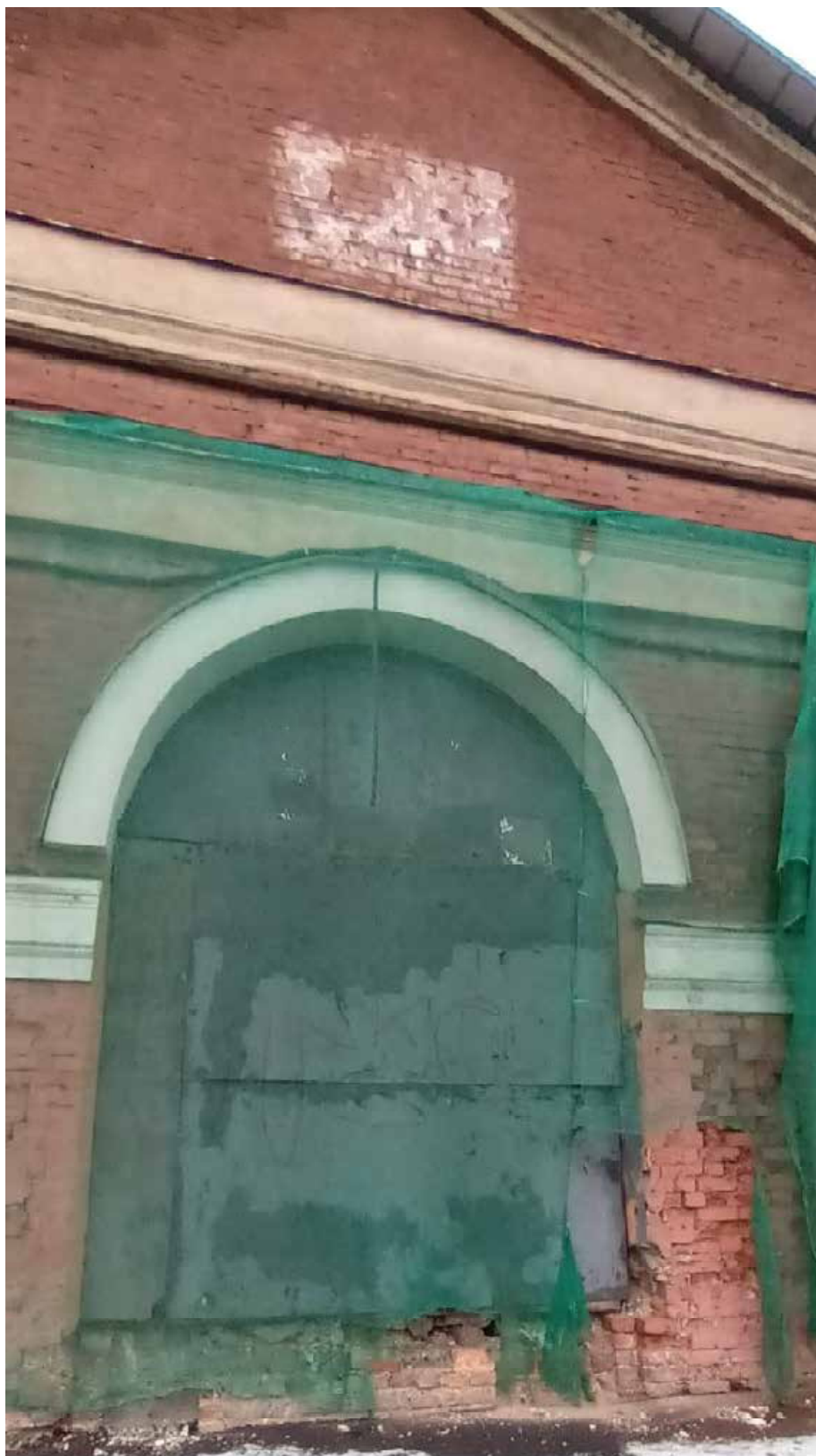
11. Объект культурного наследия регионального значения «Хлебные амбары Александро-Невской лавры (5 корпусов)». Корпус по адресу: г. СПб, набережная Обводного канала, дом 3, литера А. Фрагмент торцевого юго-западного фасада. Входной и оконный проемы. 21 декабря 2022 г.
