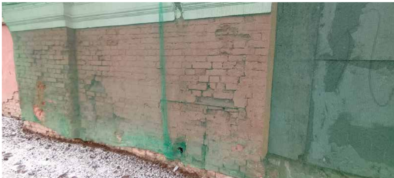
10. Объект культурного наследия регионального значения «Хлебные амбары Александро-Невской лавры (5 корпусов)». Корпус по адресу: г. СПб, набережная Обводного канала, дом 3, литера А. Фрагмент торцевого юго-западного фасада. 21 декабря 2022 г.
