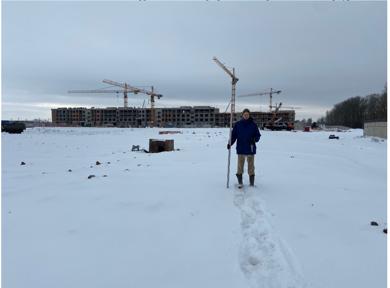
Рис. 15 Санкт-Петербург, Пушкинский район. Общий вид участка обследования между Колпинским шоссе и р. Славянкой. Точка фотосъемки №1. Вид на юг.
