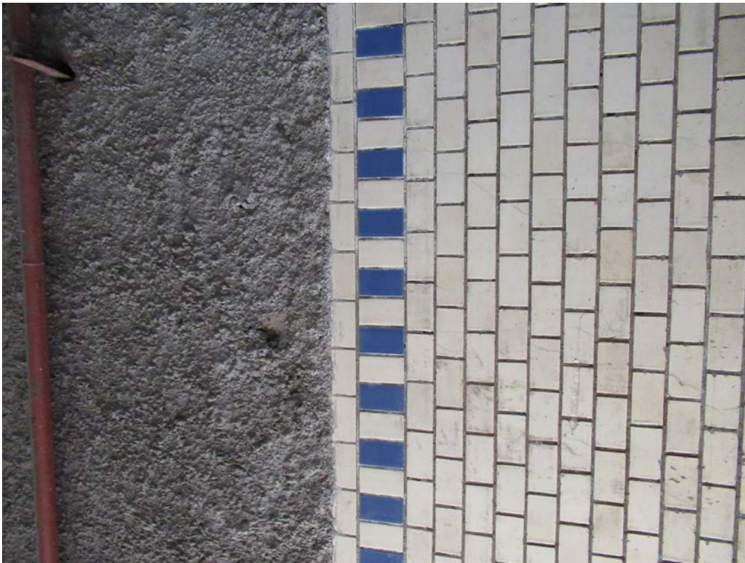
34. 12-я линия В.О., 19. Дом О.М. Фогт и Б.А. Попова. Фрагмент отделки стенки воротного проезда лицевого корпуса – декоративная плитка и штукатурка.
