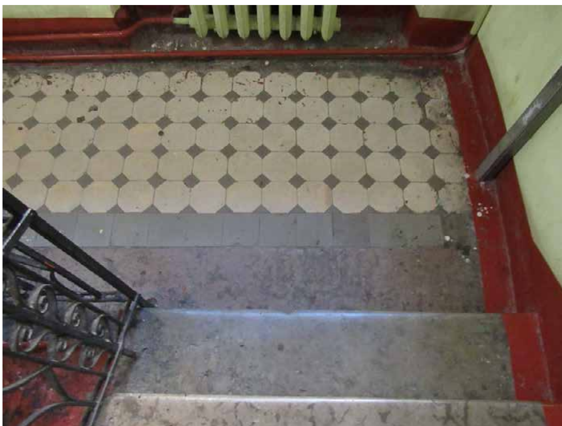
62. 12-я линия В.О., 19. Дом О.М. Фогт и Б.А. Попова. 1ЛК, фрагмент покрытия пола лестничной клетки метлахской плиткой.
