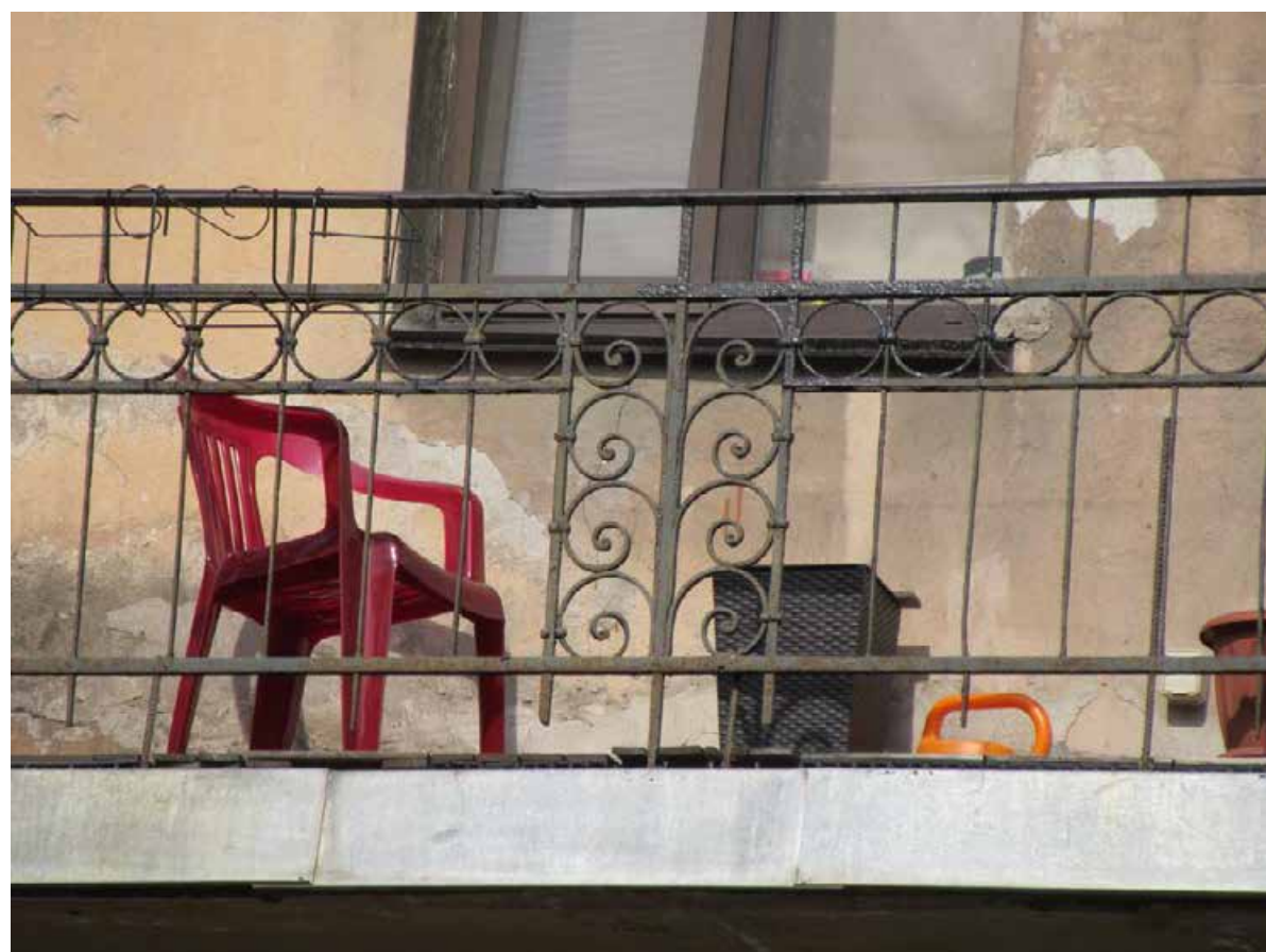
12. 12-я линия В.О., 19. Дом О.М. Фогт и Б.А. Попова. Фрагмент металлического ограждения балкона в уровне 3-го этажа.
