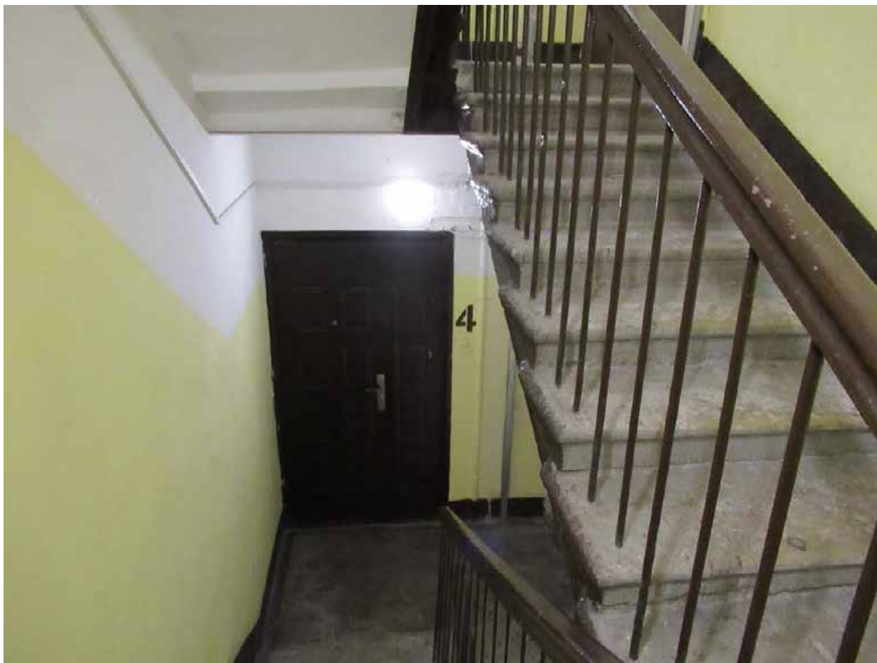
107. 12-я линия В.О., 19. Дом О.М. Фогт и Б.А. Попова. 4ЛК, вид снизу на лестничную клетку с квартирами.
