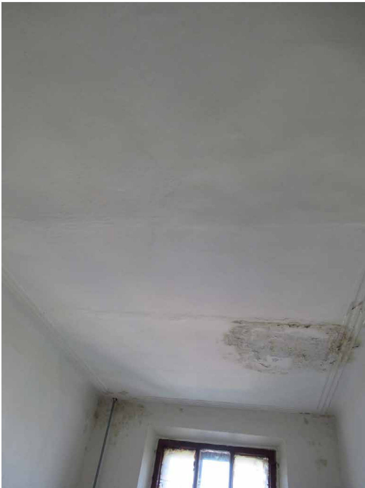
88. 12-я линия В.О., 19. Дом О.М. Фогт и Б.А. Попова. ЗЛК, потолок 6-го этажа.
