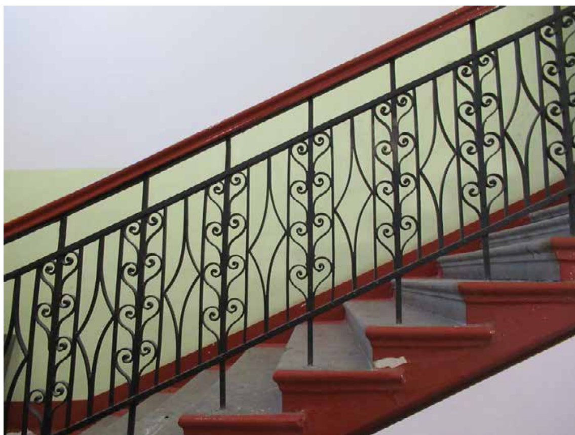
67. 12-я линия В.О., 19. Дом О.М. Фогт и Б.А. Попова. 1ЛК, фрагмент исторического металлического лестничного ограждения.
