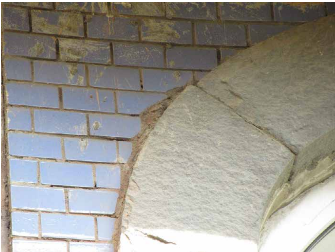
13. 12-я линия В.О., 19. Дом О.М. Фогт и Б.А. Попова. Фрагмент отделки южной части лицевого фасада с декоративной плиткой и перемычкой оконного проема 2-го этажа.
