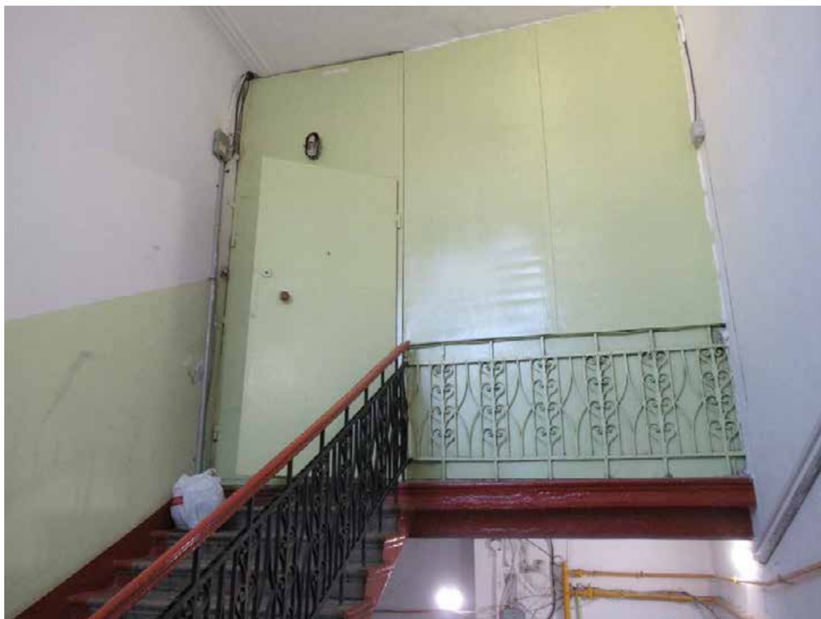
70. 12-я линия В.О., 19. Дом О.М. Фогт и Б.А. Попова. 1ЛК, вход на чердак.
