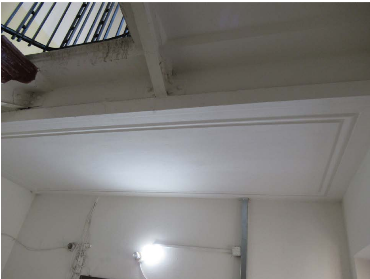
54. 12-я линия В.О., 15, лит. А. Доходный дом Н.В. Смирнова, входящий в состав ОКН «Доходный дом и особняк Н.В. Смирнова». 3ЛК, потолок лестничной клетки.
