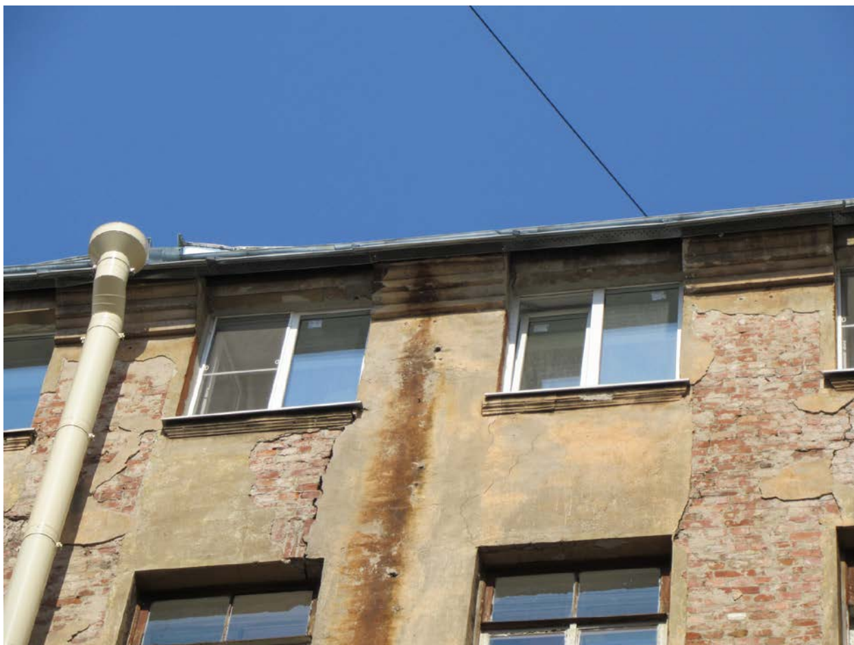
21. 12-я линия В.О., 15, лит. А. Доходный дом Н.В. Смирнова, входящий в состав ОКН «Доходный дом и особняк Н.В. Смирнова». Фрагмент венчающего карниза дворового фасада.
