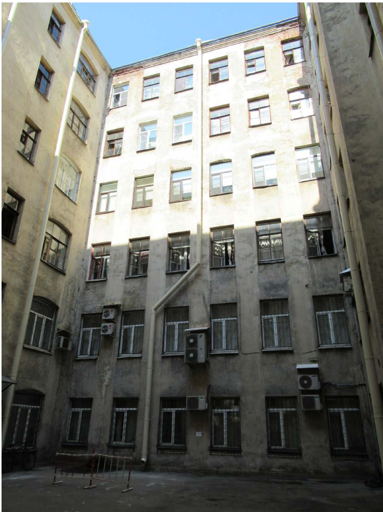
25. 12-я линия В.О., 15, лит. А. Доходный дом Н.В. Смирнова, входящий в состав ОКН «Доходный дом и особняк Н.В. Смирнова». Северо-восточный фасад западного двора.
