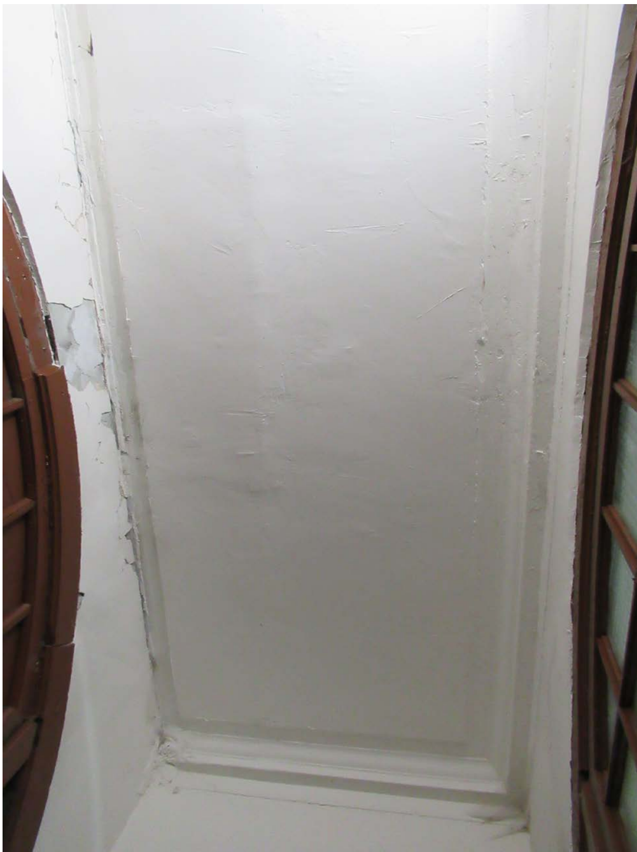
33. 12-я линия В.О., 15, лит. А. Доходный дом Н.В. Смирнова, входящий в состав ОКН «Доходный дом и особняк Н.В. Смирнова». Парадная лестница (4ЛК). Потолок тамбура.
