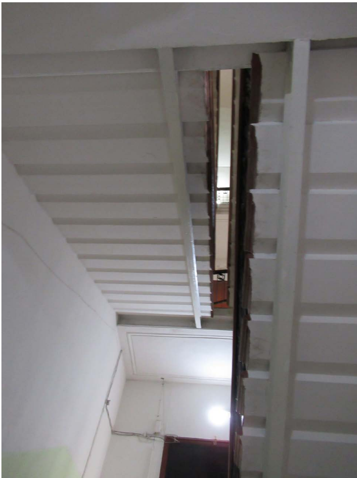
42. 12-я линия В.О., 15, лит. А. Доходный дом Н.В. Смирнова, входящий в состав ОКН «Доходный дом и особняк Н.В. Смирнова». Парадная лестница (4ЛК). Вид снизу на лестничные марши.
