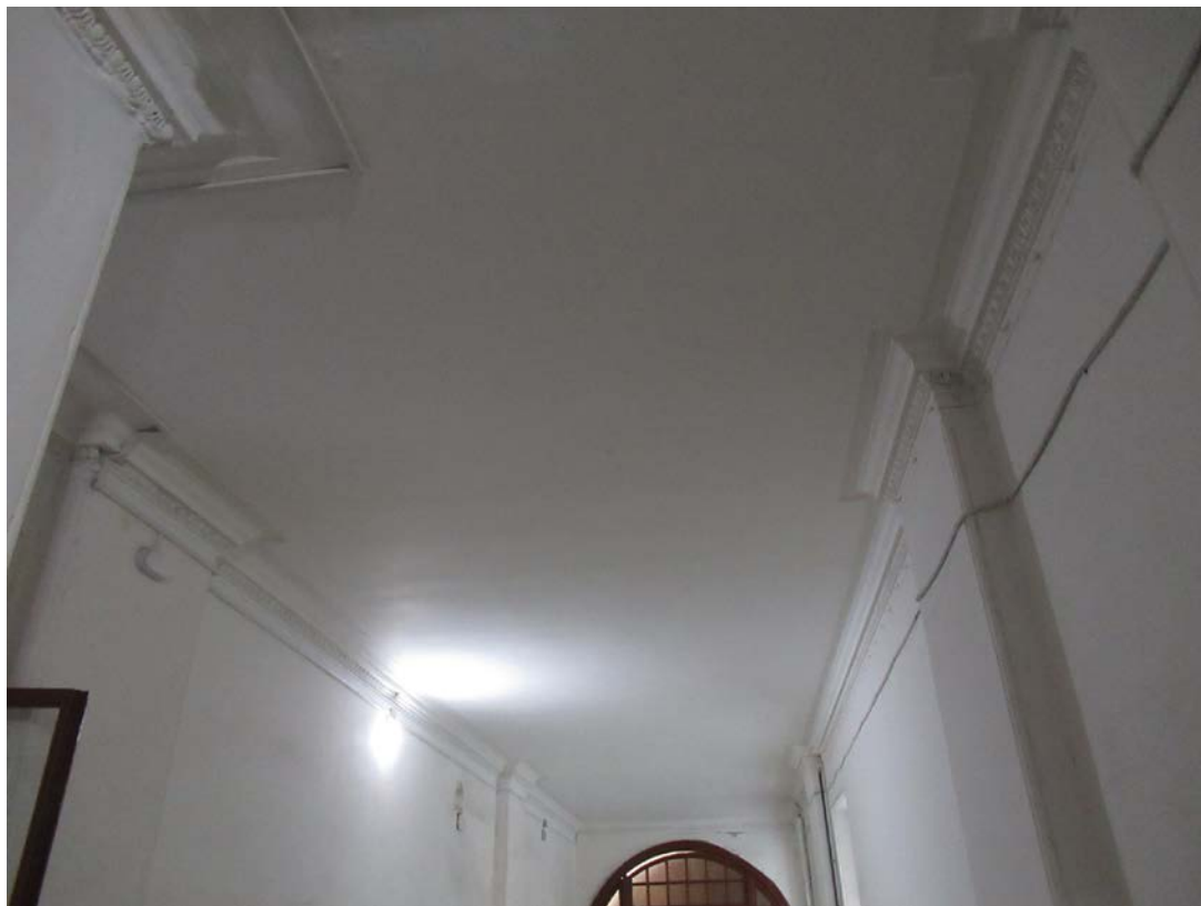
34. 12-я линия В.О., 15, лит. А. Доходный дом Н.В. Смирнова, входящий в состав ОКН «Доходный дом и особняк Н.В. Смирнова». Парадная лестница (4ЛК). Потолок вестибюля.
