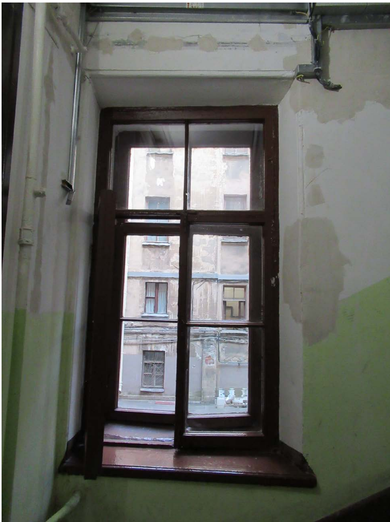
41. 12-я линия В.О., 15, лит. А. Доходный дом Н.В. Смирнова, входящий в состав ОКН «Доходный дом и особняк Н.В. Смирнова». Парадная лестница (4ЛК). Оконный проем с историческим заполнением, выходящий во внутренний двор.
