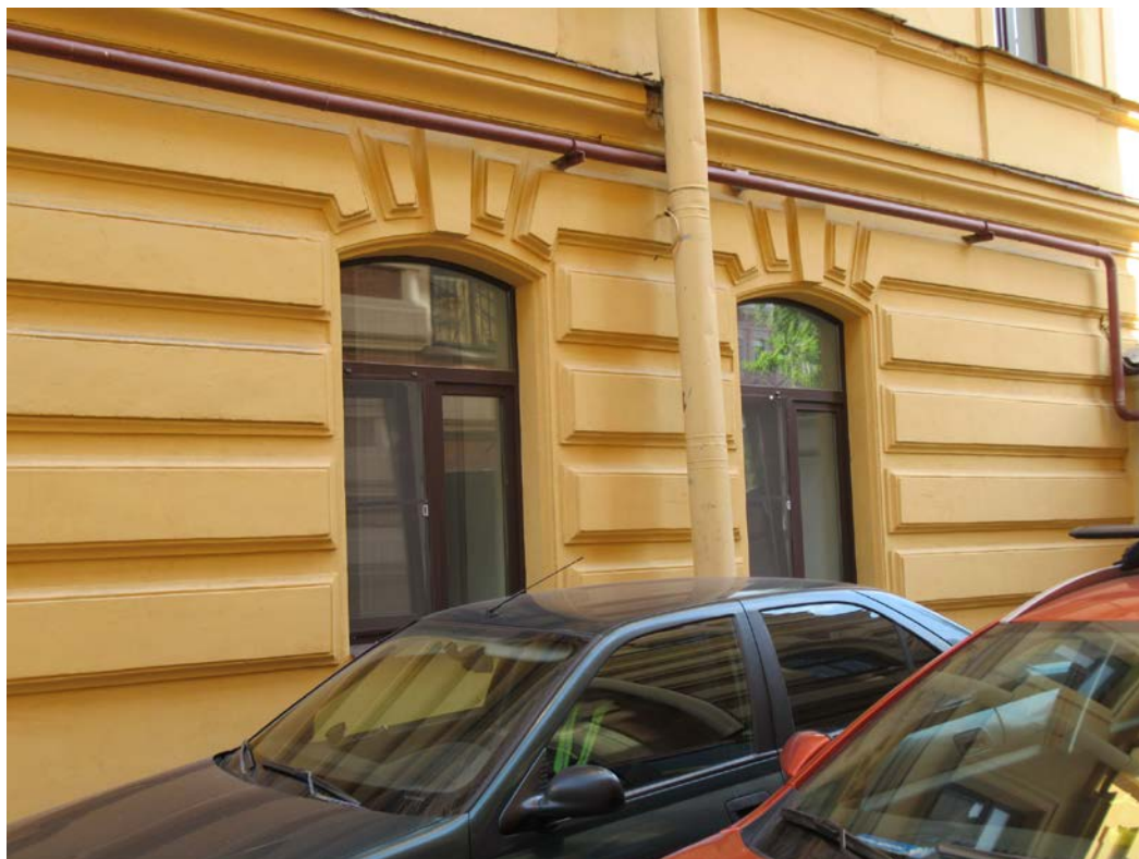
24. 12-я линия В.О., 25; Средний пр. В.О., 48, лит.Б. Флигель, входящий в состав ОКН «Дома В.Н. фон Дервиз». Юго-западный фасад в уровне 1-го этажа.
