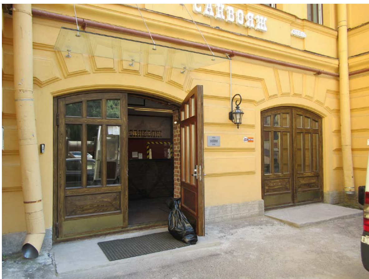
8. 12-я линия В.О., 25; Средний пр. В.О., 48, лит.Б. Флигель, входящий в состав ОКН «Дома В.Н. фон Дервиз». Центральная часть лицевого фасада в уровне 1-го этажа.
