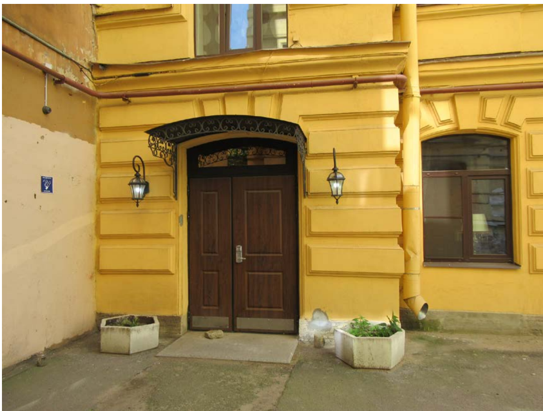
16. 12-я линия В.О., 25; Средний пр. В.О., 48, лит.Б. Флигель, входящий в состав ОКН «Дома В.Н. фон Дервиз». Дверной проем в уровне 1-го этажа ризалита северо-восточного фасада.
