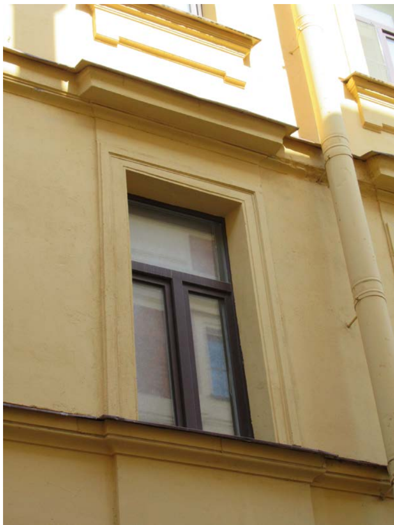
27. 12-я линия В.О., 25; Средний пр. В.О., 48, лит.Б. Флигель, входящий в состав ОКН «Дома В.Н. фон Дервиз». Оконный проем в уровне 2-го этажа юго-западного фасада.
