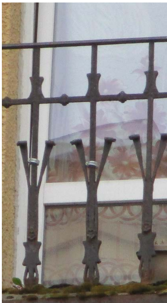
10. Санкт-Петербург. 11 линия, д.48. Ограждение балкона 3 этажа.
