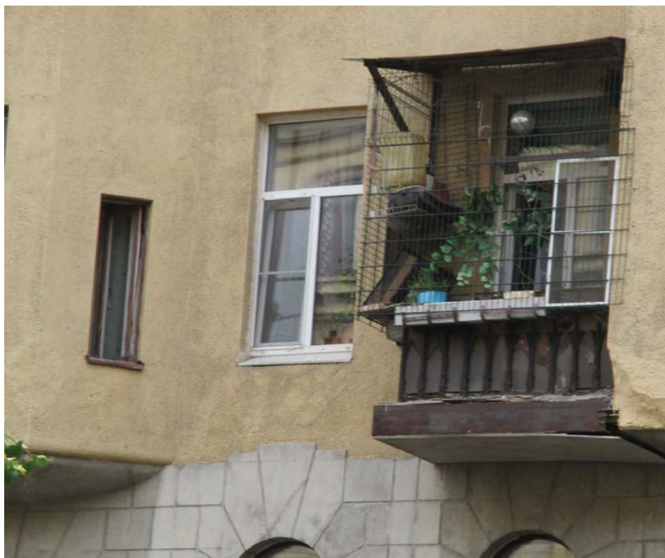
9. Санкт-Петербург. 11 линия, д.48. Балкон в уровне 3 этажа.
