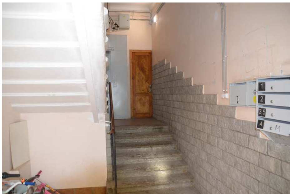
Фото 11. Выявленный объект культурного наследия «Дом Сидоровых», расположенный по адресу Санкт-Петербург, Съезжинская ул., д. 22, литера А. Вестибюль парадной лестницы лицевого корпуса. Съемка 26.04.2021. Егорова Т. Г.
