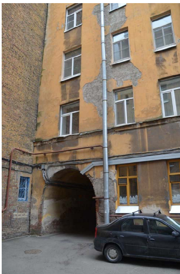
Фото 10. Выявленный объект культурного наследия «Дом Сидоровых», расположенный по адресу Санкт-Петербург, Съезжинская ул., д. 22, литера А. Вид части северного фасада дворового корпуса и арочного проезда. Съемка 26.04.2021. Егорова Т. Г.
