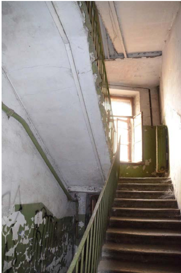
Фото 38. Выявленный объект культурного наследия «Дом И. С. Мальцева», расположенный по адресу Санкт-Петербург, Басков пер., 41/29, литера А (Басков пер., 41, ул. Радищева, 29). Вид черной лестницы. Съемка 26.04.2021. Егорова Т. Г.
