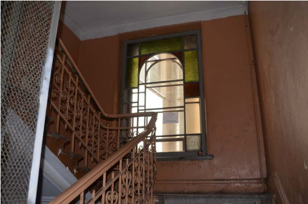
Фото 31. Выявленный объект культурного наследия «Дом И. С. Мальцева», расположенный по адресу Санкт-Петербург, Басков пер., 41/29, литера А (Басков пер., 41, ул. Радищева, 29). Вид парадной лестницы по ул. Радищева. Съемка 26.04.2021. Егорова Т. Г.
