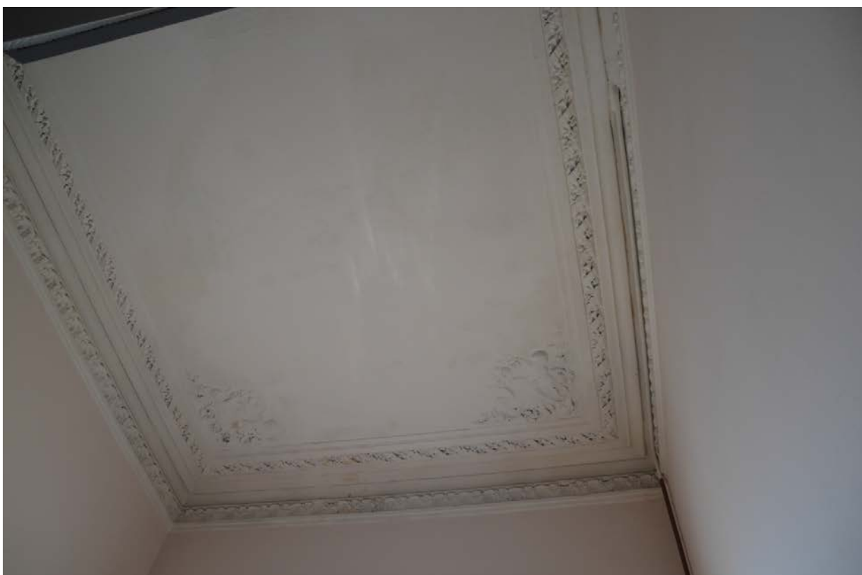
Фото 22. Выявленный объект культурного наследия «Дом И. С. Мальцева», расположенный по адресу Санкт-Петербург, Басков пер., 41/29, литера А (Басков пер., 41, ул. Радищева, 29). Вид потолка парадной лестницы по Баскову переулку. Фрагмент. Съемка 26.04.2021. Егорова Т. Г.
