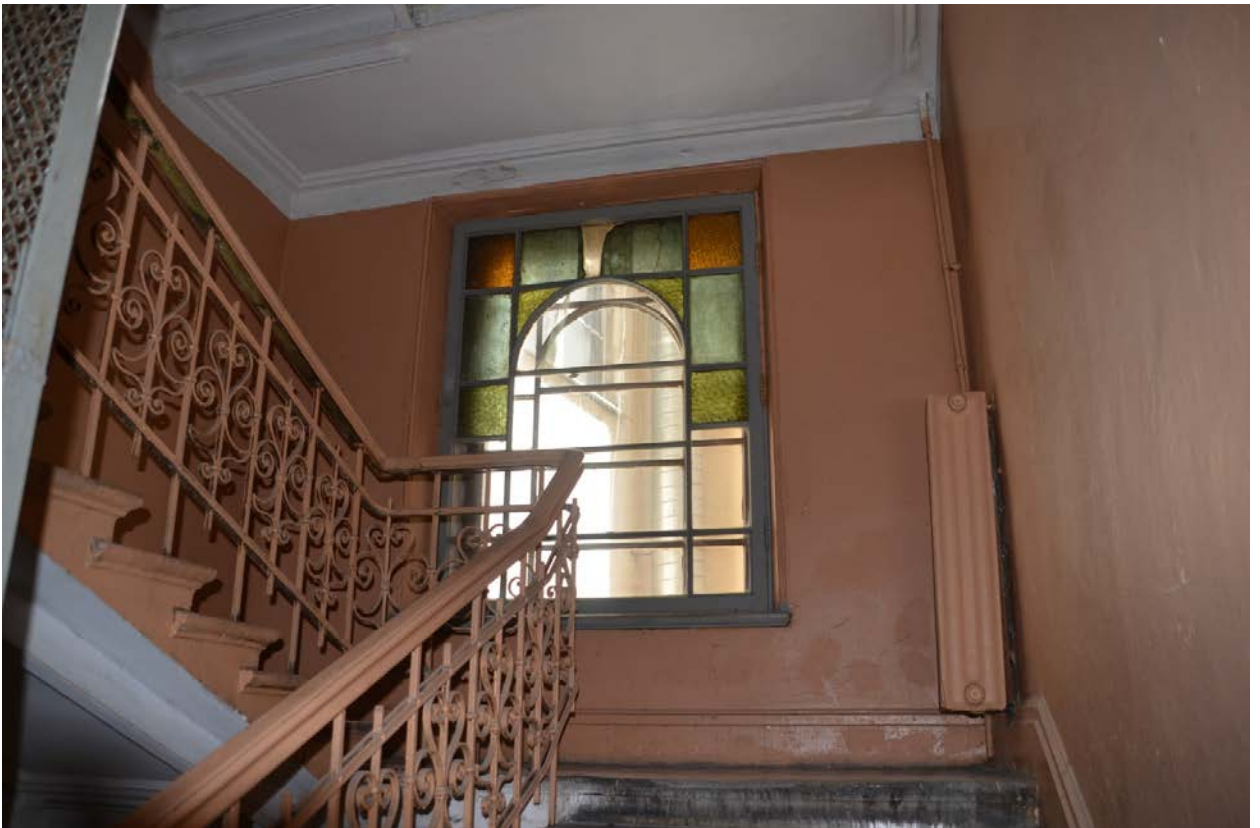
Фото 33. Выявленный объект культурного наследия «Дом И. С. Мальцева», расположенный по адресу Санкт-Петербург, Басков пер., 41/29, литера А (Басков пер., 41, ул. Радищева, 29). Вид парадной лестницы по ул. Радищева. Съемка 26.04.2021. Егорова Т. Г.
