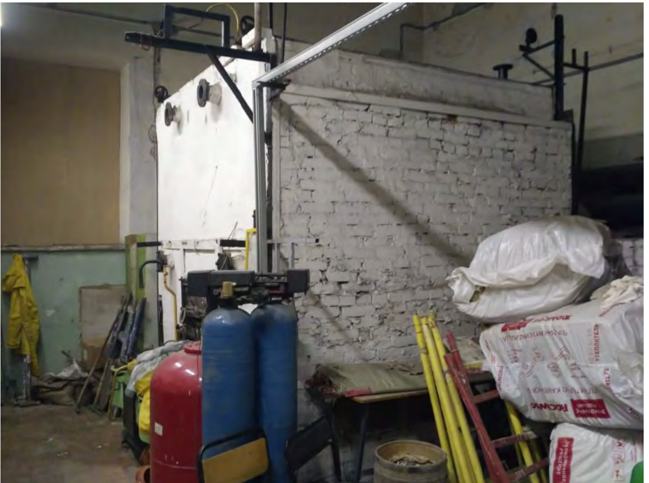
Фото 7. Объект культурного наследия федерального значения "Центральное училище технического рисования и музей Штиглица А.Л" по адресу: Санкт-Петербург, Соляной пер., д. 13-15, лит. А. Помещения 11-Н (Котельная)
