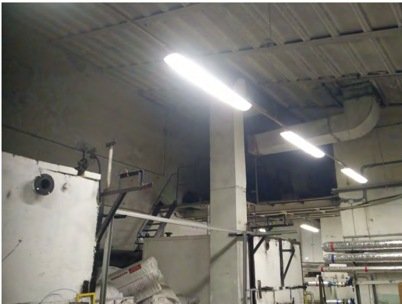
Фото 3. Объект культурного наследия федерального значения "Центральное училище технического рисования и музей Штиглица А.Л" по адресу: Санкт-Петербург, Соляной пер., д. 13-15, лит. А. Помещения 11-Н (Котельная)
