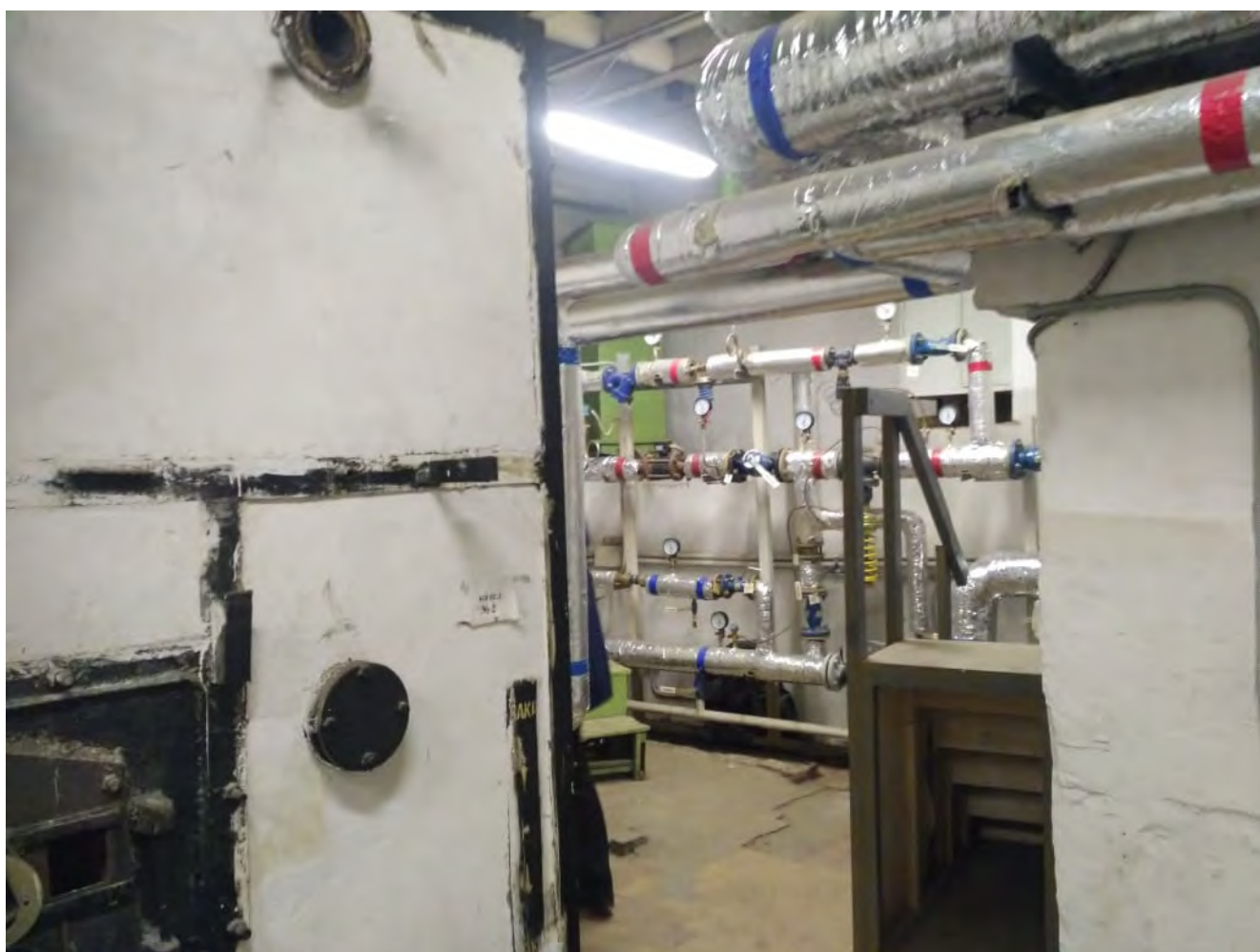
Фото 9. Объект культурного наследия федерального значения "Центральное училище технического рисования и музей Штиглица А.Л" по адресу: Санкт-Петербург, Соляной пер., д. 13-15, лит. А. Помещения 11-Н (Котельная)
