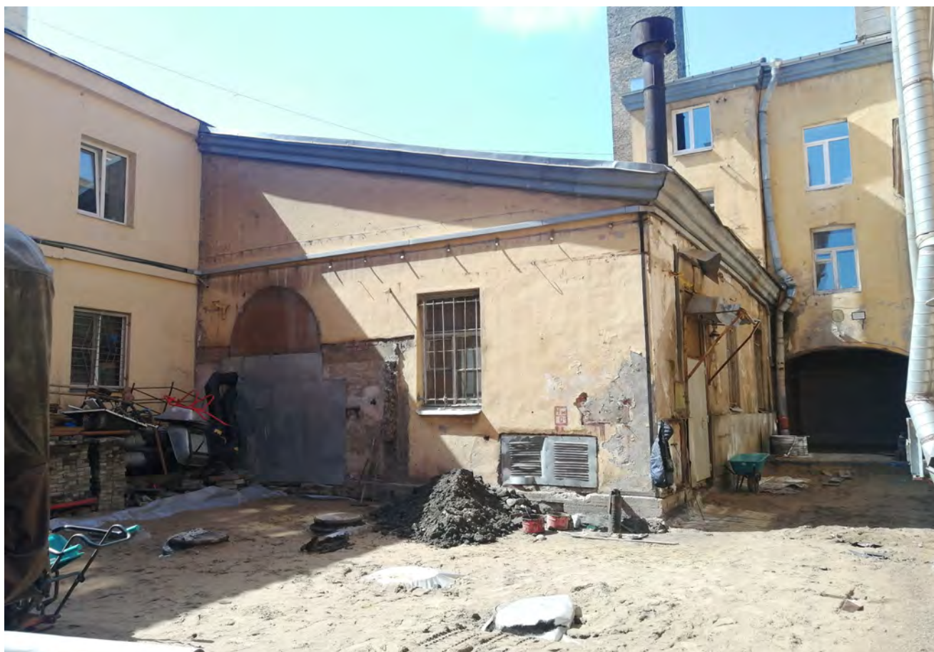
Фото 1. Объект культурного наследия федерального значения "Центральное училище технического рисования и музей Штиглица А.Л" по адресу: Санкт-Петербург, Соляной пер., д. 13-15, лит. А. Помещения 11-Н (Котельная)
