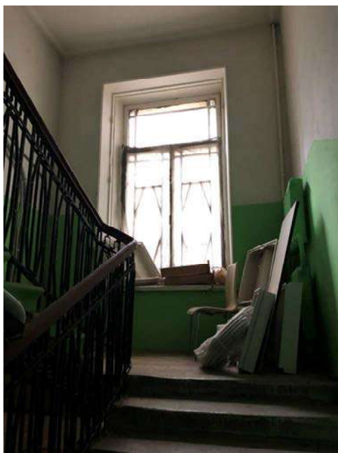
Фото 18 Выявленный объект культурного наследия «Дом Ш. З. Иофа», расположенный по адресу Санкт-Петербург, ул. Белинского, д. 13, Литейный пр., д. 47. Вид черной лестницы. Съемка 26.04.2021. Егорова Т. Г.
