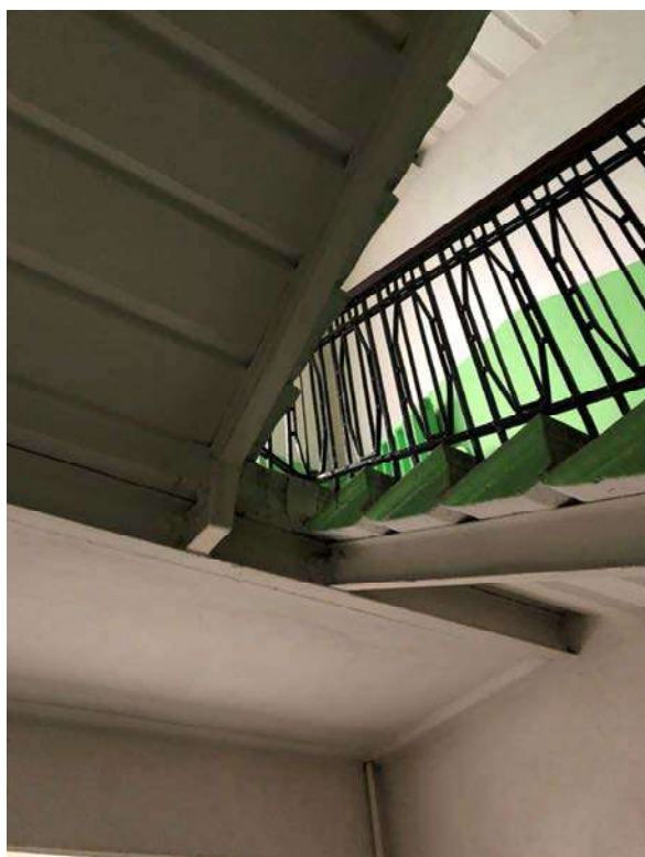
Фото 30. Выявленный объект культурного наследия «Дом Ш. З. Иофа», расположенный по адресу Санкт-Петербург, ул. Белинского, д. 13, Литейный пр., д. 47. Вид конструкции черной лестницы. Съемка 26.04.2021. Егорова Т. Г.
