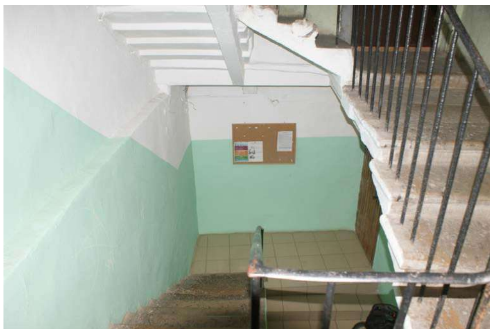
Фото 78. Выявленный объект культурного наследия «Дом Ш. З. Иофа», расположенный по адресу Санкт-Петербург, ул. Белинского, д. 13, Литейный пр., д. 47. Вид лестницы № 3 (со стороны двора). Съемка 26.04.2021. Егорова Т. Г.
