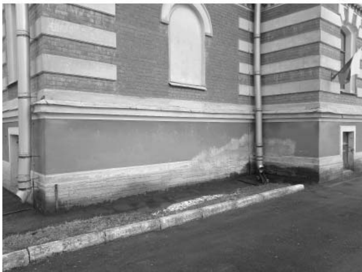
Фото 31. Фрагмент вида лицевого фасада. Цементные домestikовки
