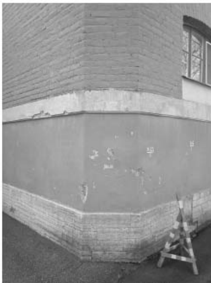
Фото 18. Фрагмент вида дворового фасада. Дефекты штукатурного слоя
