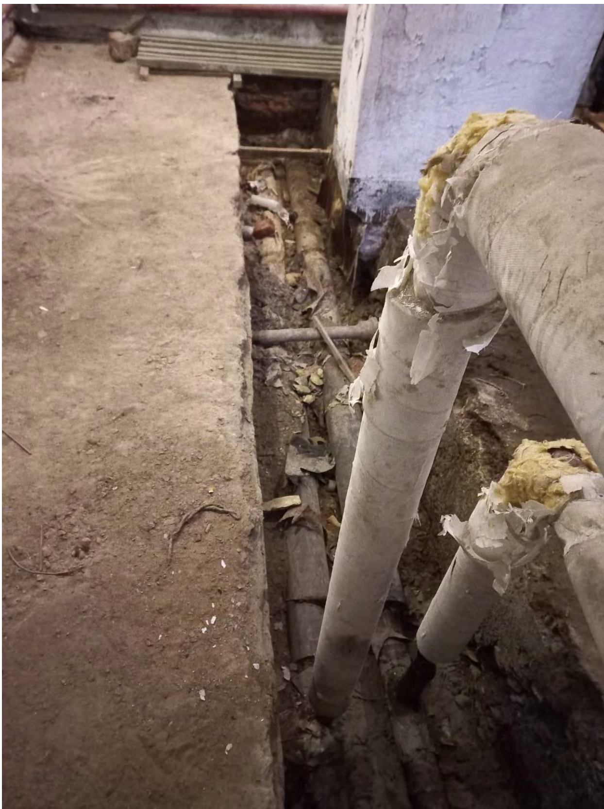
Фото 31. Вид на южный индивидуальный тепловой пункт в здании по адресу: Санкт-Петербург, г. Кронштадт, Флотская ул., 2, входящего в состав объекта культурного наследия регионального значения «Шесть флигелей».
