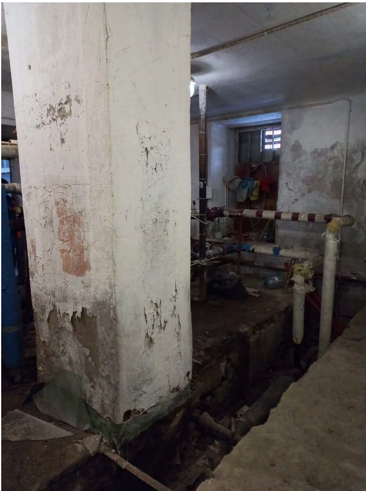
Фото 28. Вид на южный индивидуальный тепловой пункт в здании по адресу: Санкт-Петербург, г. Кронштадт, Флотская ул., 2, входящего в состав объекта культурного наследия регионального значения «Шесть флигелей».
