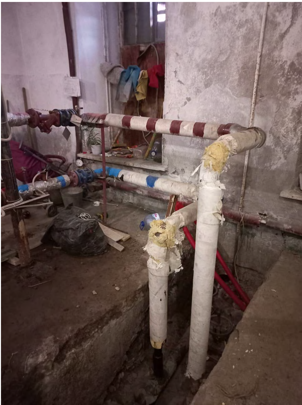
Фото 29. Вид на южный индивидуальный тепловой пункт в здании по адресу: Санкт-Петербург, г. Кронштадт, Флотская ул., 2, входящего в состав объекта культурного наследия регионального значения «Шесть флигелей».
