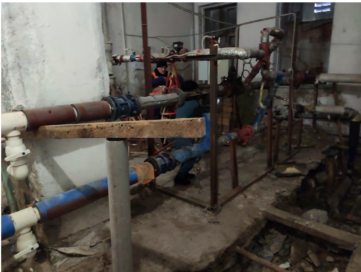
Фото 24. Вид на северный индивидуальный тепловой пункт в здании по адресу: Санкт-Петербург, г. Кронштадт, Флотская ул., 2, входящего в состав объекта культурного наследия регионального значения «Шесть флигелей».
