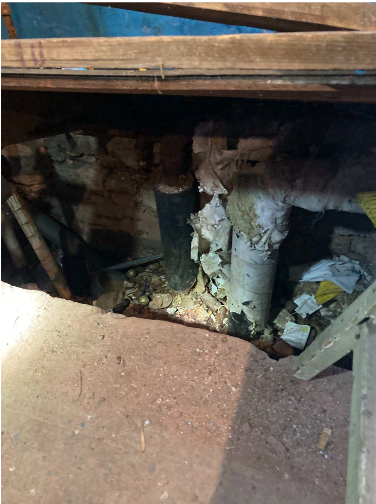
Фото 43. Вид на помещение индивидуального теплового пункта здания по адресу: Санкт-Петербург, г. Кронштадт, Советская ул., 39, входящего в состав объекта культурного наследия регионального значения «Пять флигелей».
