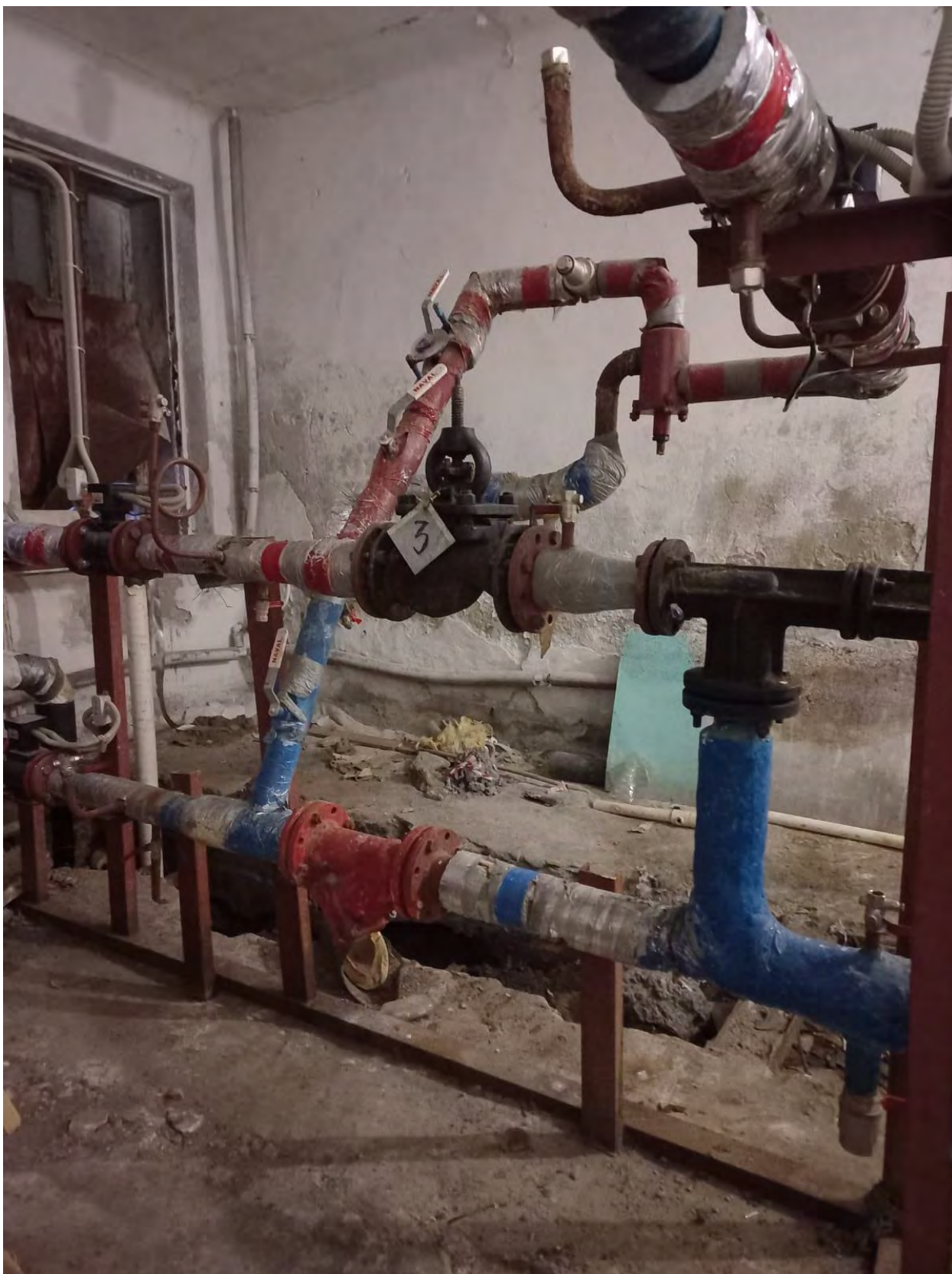
Фото 25. Вид на северный индивидуальный тепловой пункт в здании по адресу: Санкт-Петербург, г. Кронштадт, Флотская ул., 2, входящего в состав объекта культурного наследия регионального значения «Шесть флигелей».
