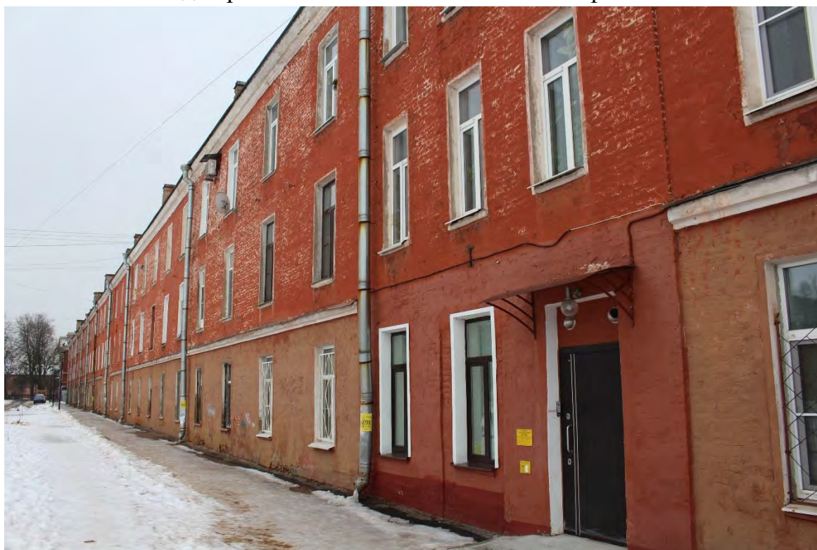
Фото 4. Вид на восточный фасад здания по адресу: Санкт-Петербург, г. Кронштадт, Флотская ул., 2, входящего в состав объекта культурного наследия регионального значения «Шесть флигелей».
