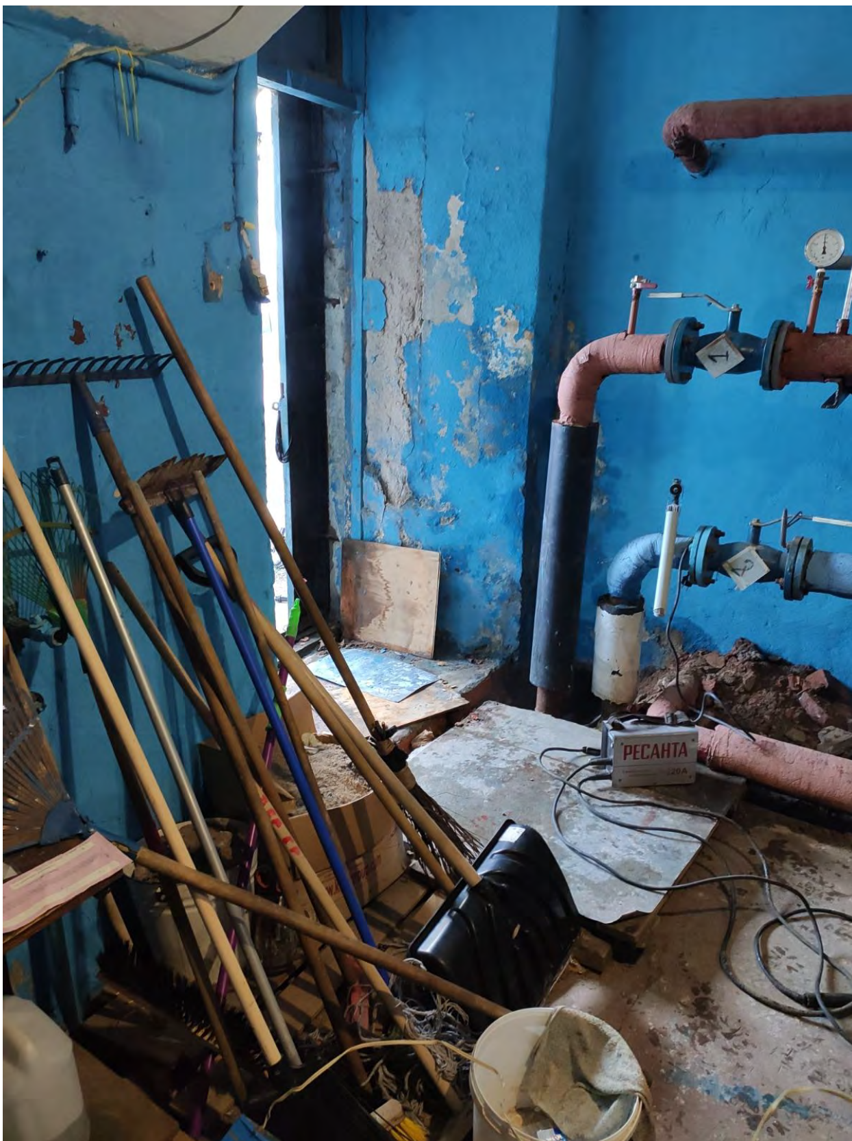
Фото 41. Вид на помещение индивидуального теплового пункта здания по адресу: Санкт-Петербург, г. Кронштадт, Советская ул., 39, входящего в состав объекта культурного наследия регионального значения «Пять флигелей».
