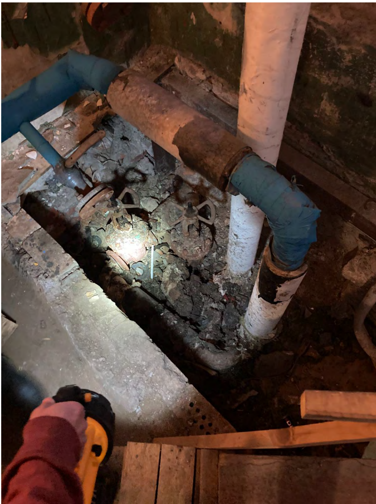
Фото 42. Вид на помещение индивидуального теплового пункта здания по адресу: Санкт-Петербург, г. Кронштадт, Советская ул., 39, входящего в состав объекта культурного наследия регионального значения «Пять флигелей».
