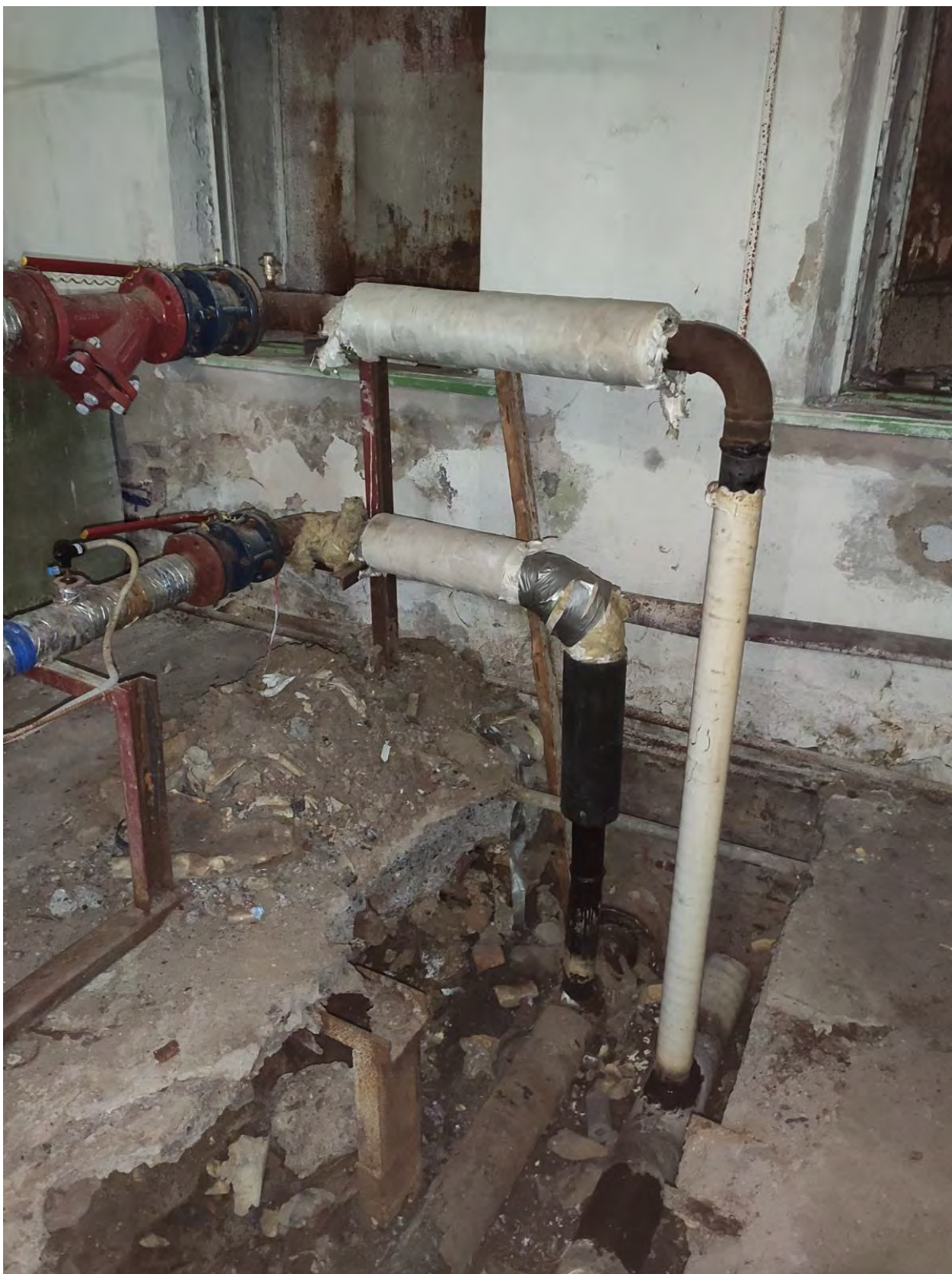
Фото 26. Вид на северный индивидуальный тепловой пункт в здании по адресу: Санкт-Петербург, г. Кронштадт, Флотская ул., 2, входящего в состав объекта культурного наследия регионального значения «Шесть флигелей».
