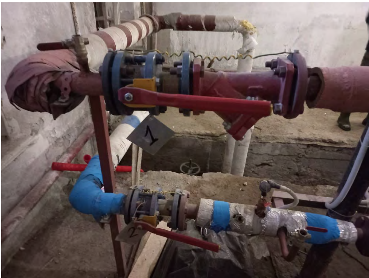
Фото 30. Вид на южный индивидуальный тепловой пункт в здании по адресу: Санкт-Петербург, г. Кронштадт, Флотская ул., 2, входящего в состав объекта культурного наследия регионального значения «Шесть флигелей».
