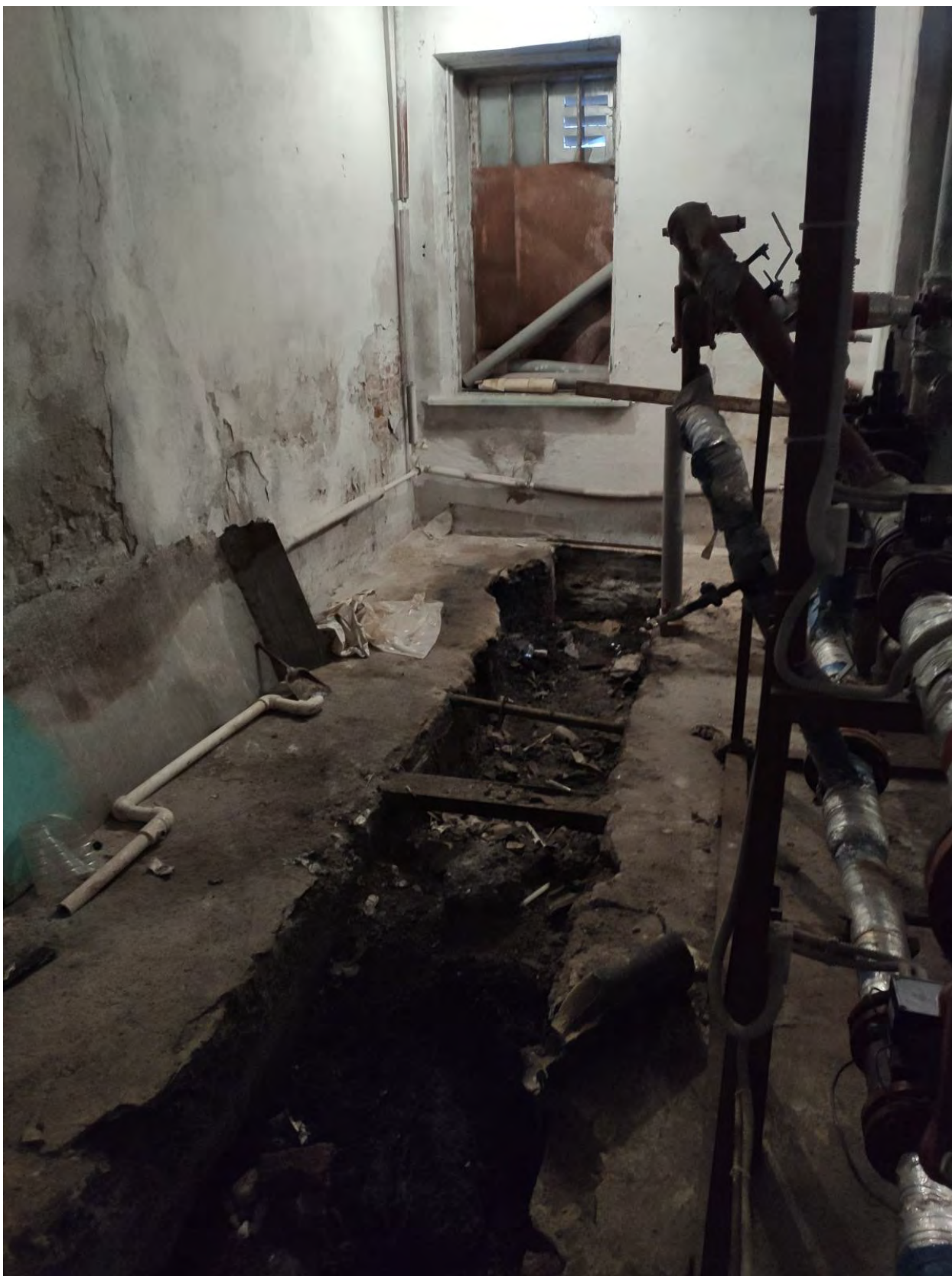
Фото 27. Вид на северный индивидуальный тепловой пункт в здании по адресу: Санкт-Петербург, г. Кронштадт, Флотская ул., 2, входящего в состав объекта культурного наследия регионального значения «Шесть флигелей».
