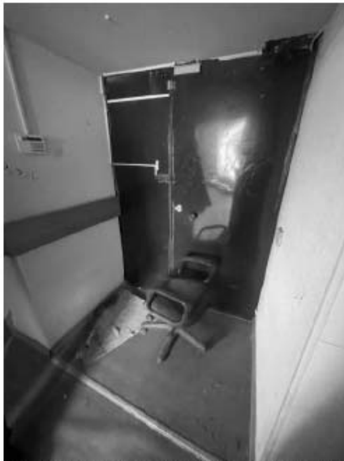
Фото 21 Интерьер части пом. 1-Н выявленного объекта культурного наследия «Дом Б.Е. Фурмана», по адресу: Санкт-Петербург, ул. Смольчкова, д. 15-17, лит. А (от 07.12.2022)
