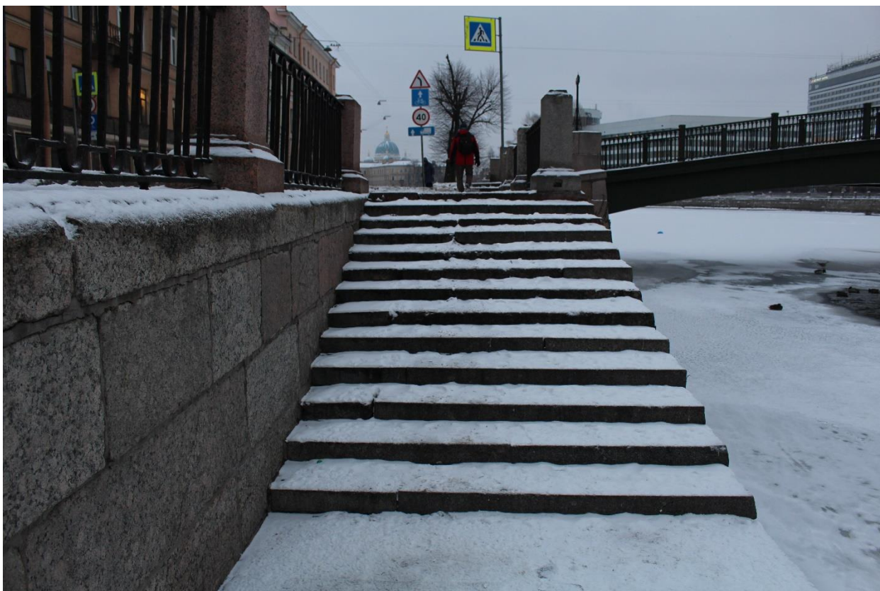
Фото 5. Вид на восточный лестничный марш спуска № 15 левобережной части объекта культурного наследия федерального значения «Набережные со спусками».
