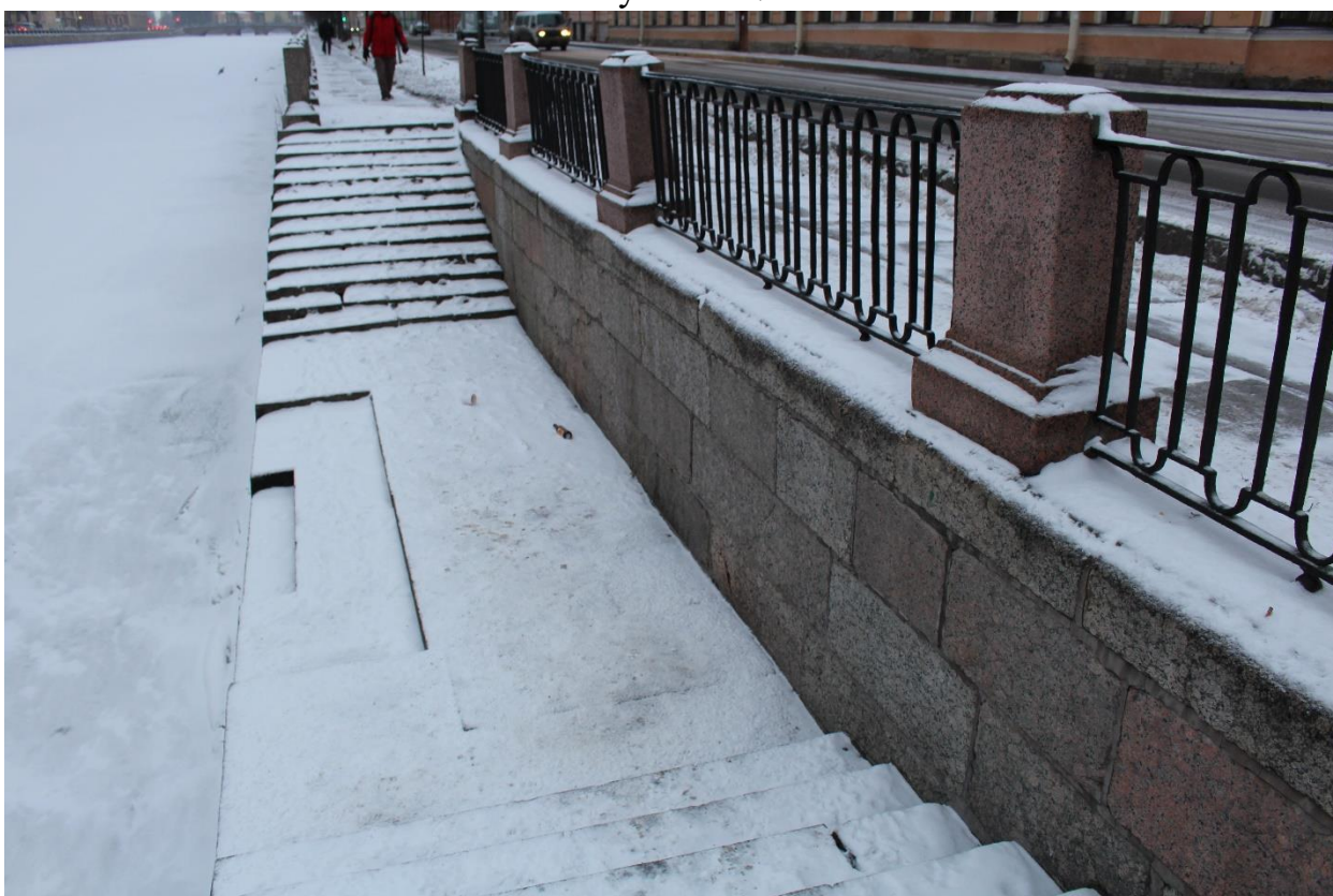
Фото 4. Вид на нижнюю площадку и подпорную стенку спуска № 15 левобережной части объекта культурного наследия федерального значения «Набережные со спусками».
