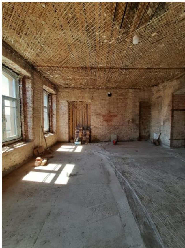
Фото 21 Интерьер квартиры №39 выявленного объекта культурного наследия «Дом Ф.Ф. Шпринга» расположенного по адресу: Санкт-Петербург, пер. Тучков, дом 11/5, литера А (26.09.2022)
